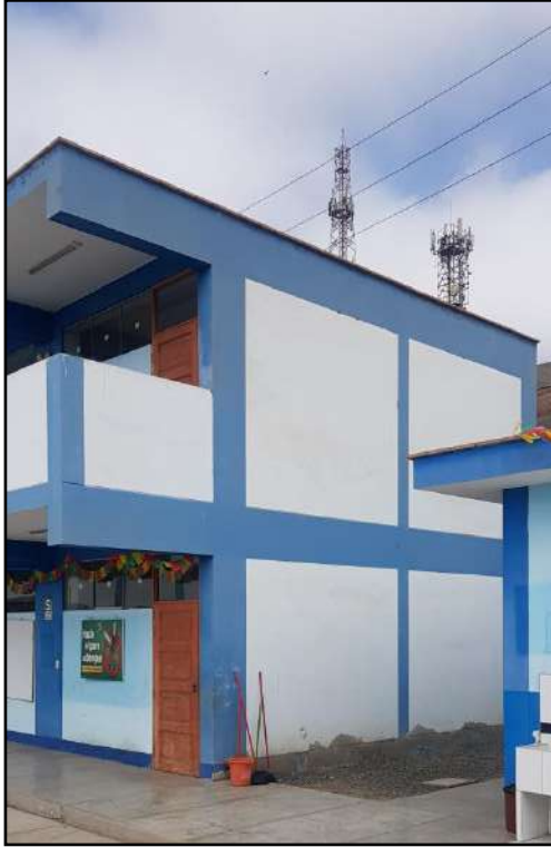
Figura 8. Desprendimiento de cobertura y tarrajeo en el Pabellón 1.
