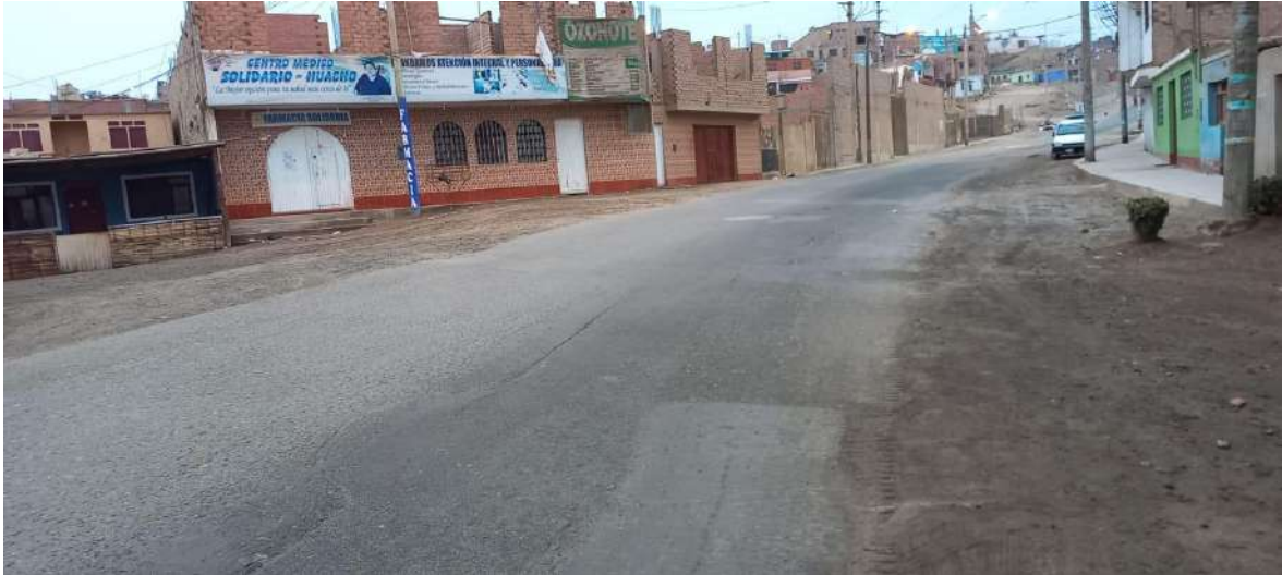
Figura 59: Falla de Parcheo en la muestra N° 05
