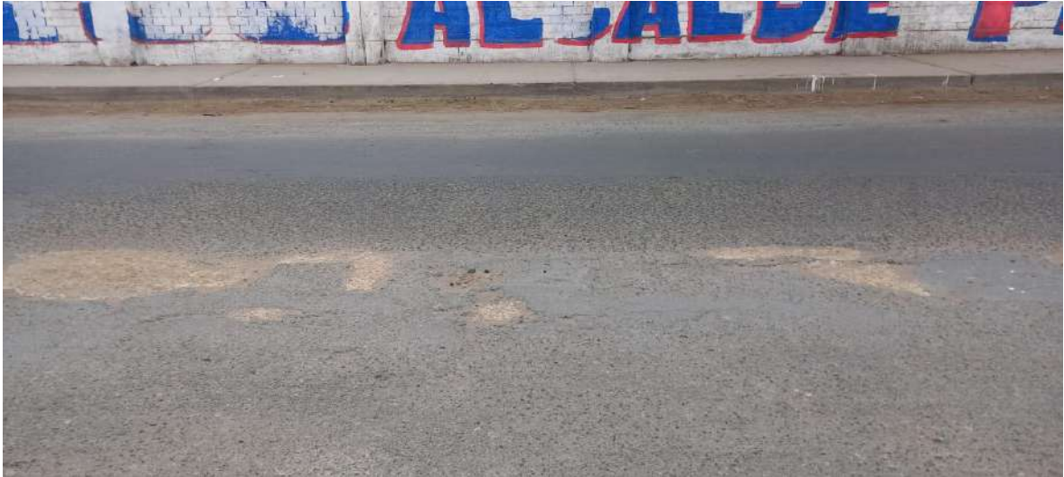
Figura 61: Falla de Huecos en la muestra N° 02
