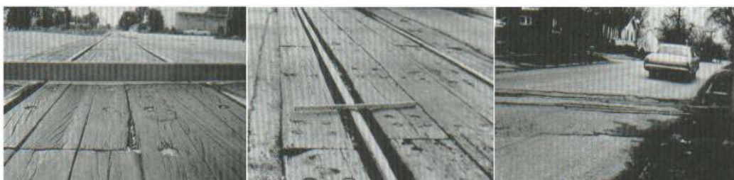
Figura 20: Cruce de vía férrea de severidad baja, media y alta (izquierda a derecha)
