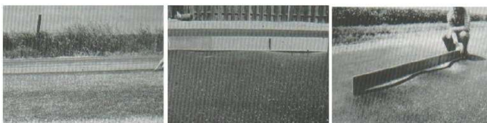
Figura 11: Corrugación de severidad baja, media y alta (Izquierda a derecha).
