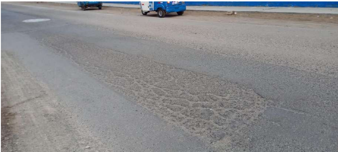
Figura 60: Falla de Piel de cocodrilo y Parcheo en la muestra N° 04
