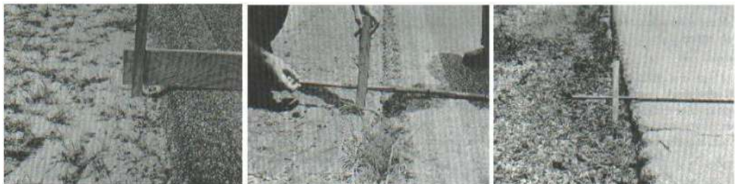
Figura 15: Desnivel carril-berma de severidad baja, media y alta (izquierda a derecha)
