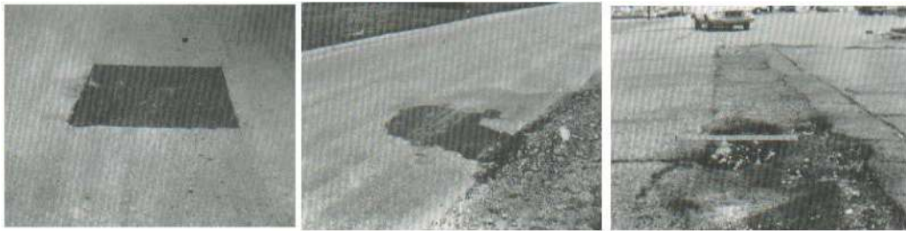
Figura 17: Parches y acometidas de severidad baja, media y alta (izquierda a derecha)
