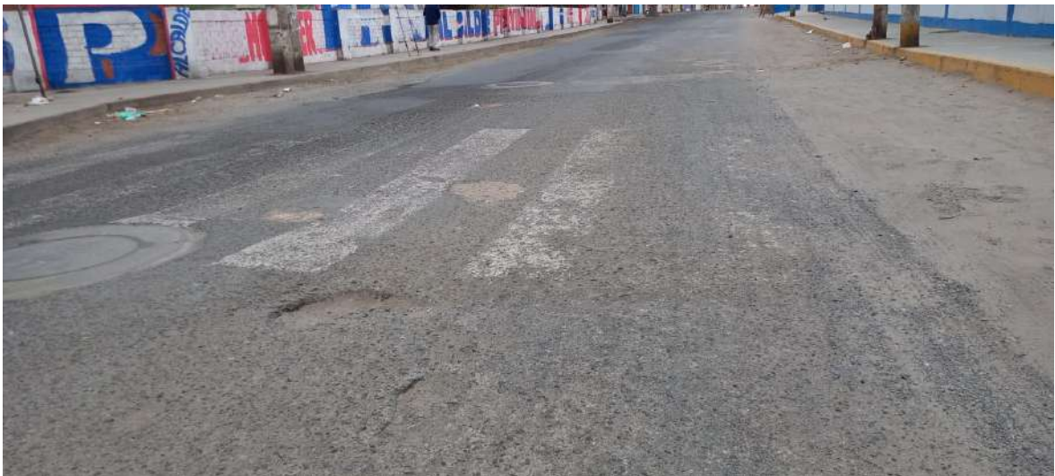
Figura 62: Falla de Huecos en la muestra N° 02
