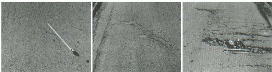
Figura 23: Grietas parabólicas de severidad baja, media y alta (izquierda a derecha)
