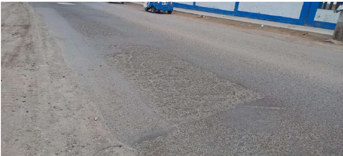
Figura 64: Falla de Piel de cocodrilo y Parcheo en la muestra N° 04
