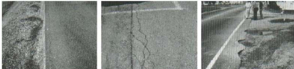
Figura 13: Grietas de borde de severidad baja, media y alta (izquierda a derecha)
