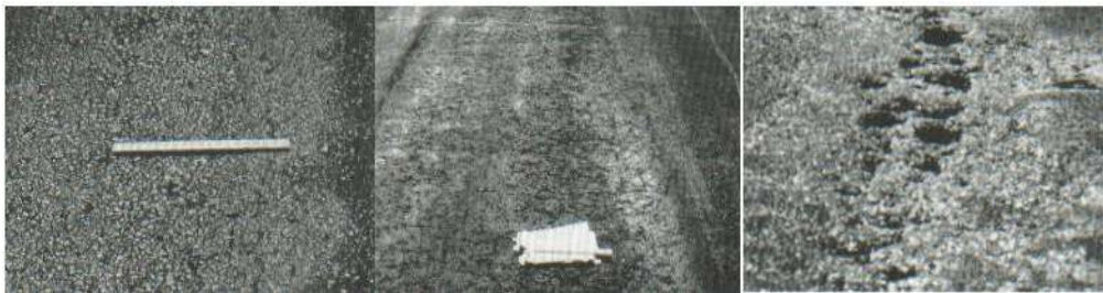
Figura 25: Desprendimiento de agregados de severidad baja, media y alta (izquierda a derecha)
