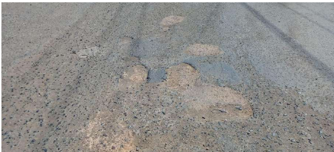
Figura 57: Falla de Huecos en la muestra N° 07
