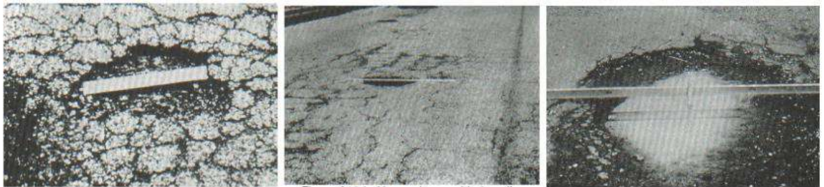
Figura 19: Huecos de severidad baja, media y alta (izquierda a derecha)
