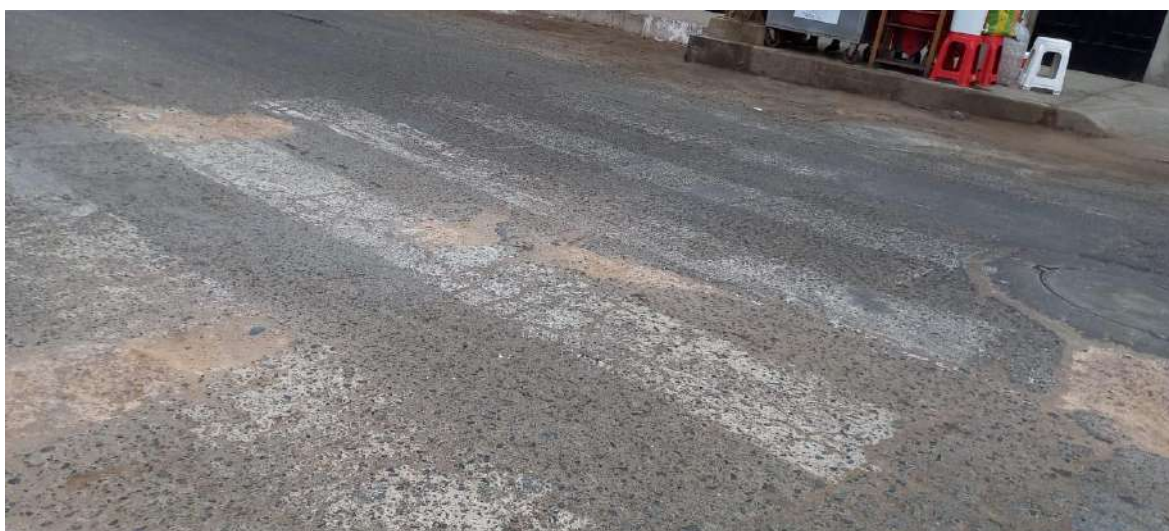
Figura 58: Falla de Huecos y Piel de Cocodrilo en la muestra N° 01
