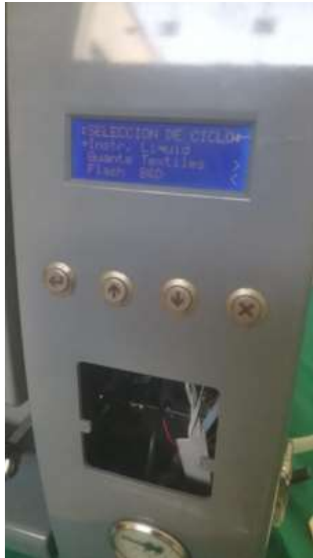
Figura 11. Equipo funcional después del mantenimiento preventivo
