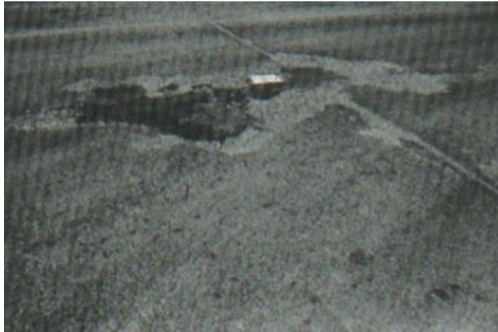
Figura 18. Desconchamiento, mapa de grietas, craquelado de alta severidad Fuente: Vásquez, (2002), p.71
