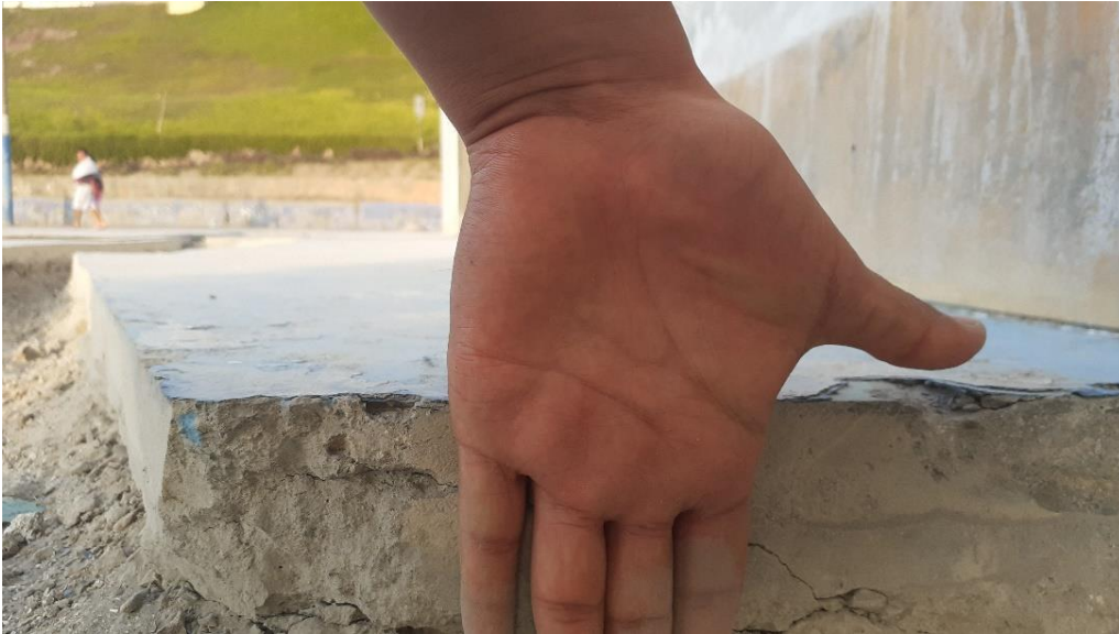
ANEXO 26. Losa sin refuerzo de malla de acero.
