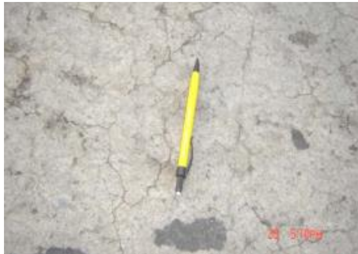
Figura 21. Grietas de retracción
