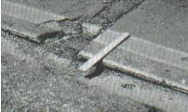
Figura 10. Desnivel carril /berma de baja severidad
