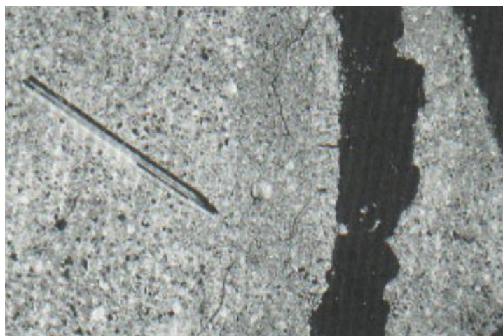
Figura 7. Grieta de durabilidad de baja severidad
