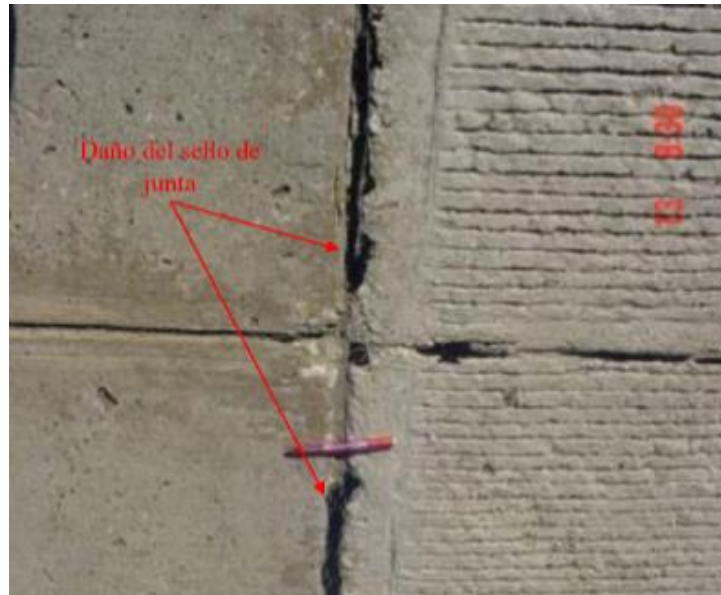
Figura 9. Daño del sello de la junta
