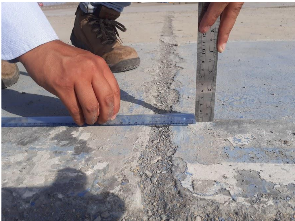
ANEXO 04. Escala, descascaramiento de junta
