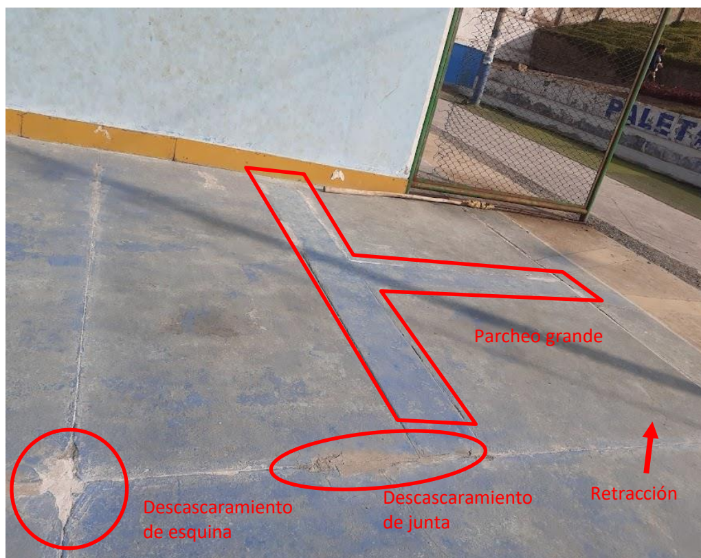
ANEXO 16. Descascaramiento de esquina, descascaramiento de junta, parcheo grande, retracción.
