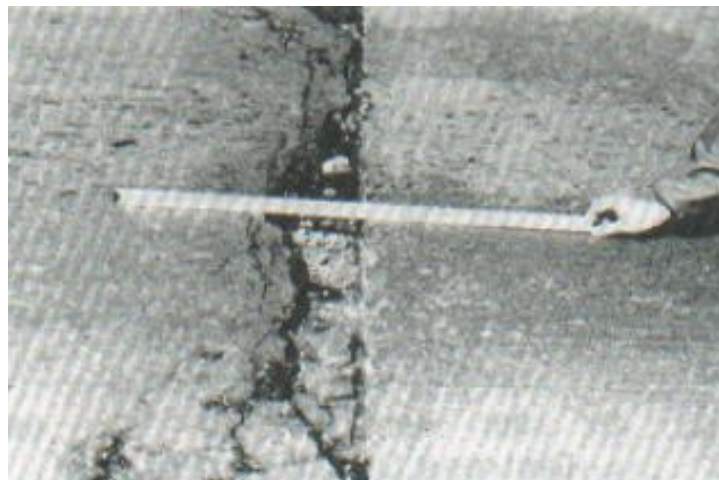
Figura 23. Descascaramiento de junta de alta severidad
