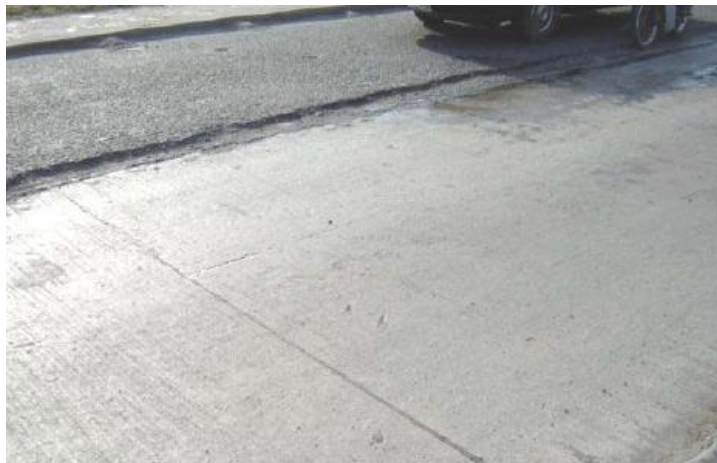
Figura 15. Vista típica de una vía con pulimiento de losas de concreto
