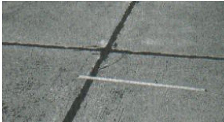
Figura 22. Descascarillado de esquina
