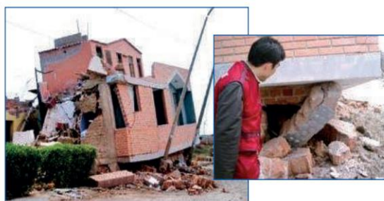
Figura 1: Viviendas dañadas debido al terremoto de Pisco, 15 de agosto del 2007.
