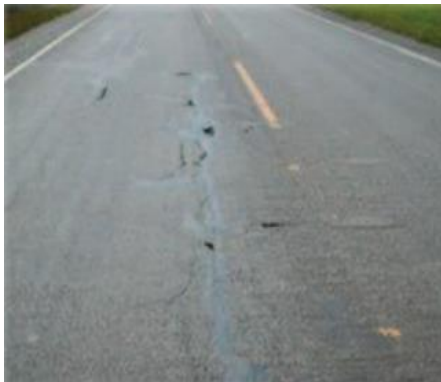
Figura 64 Nivel de gravedad (3) - Fisuras longitudinales por fatiga.
