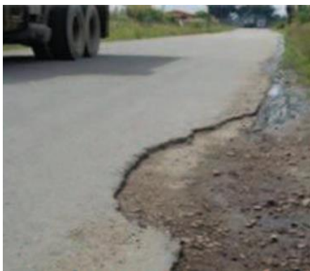
Figura 109 Nivel de gravedad (2) - Desintegración de bordes.
