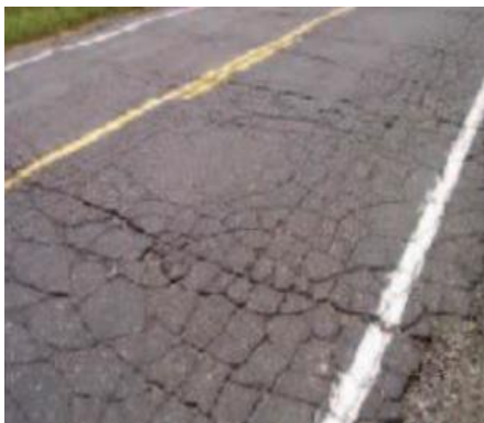
Figura 67 Nivel de gravedad (3) - Fisuras piel de cocodrilo.
