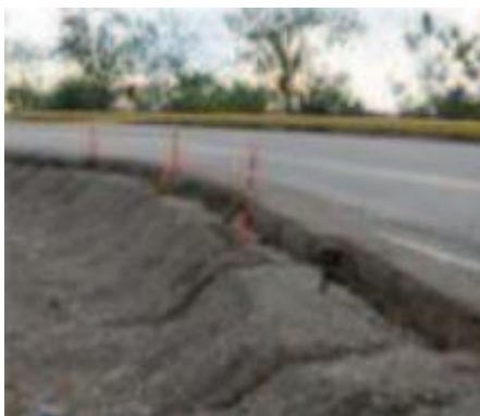
Figura 116 Nivel de gravedad (3) - Erosión de berma.
