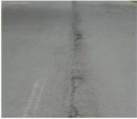
Figura 72 Nivel de gravedad (2) - Fisura longitudinal y transversal junta.
