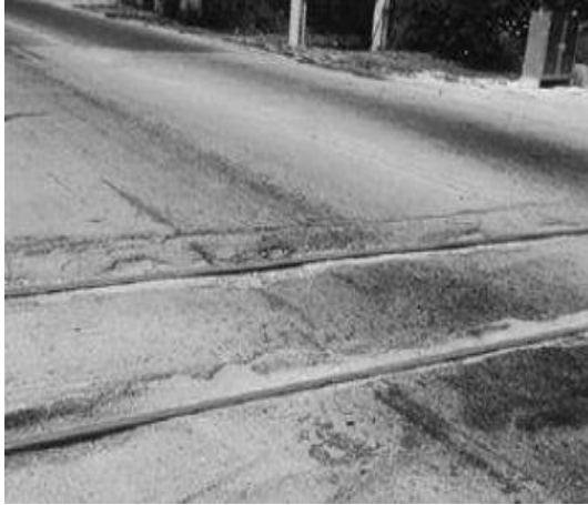
Figura 40 Grado de gravedad (M) - Cruce de vía férrea.
