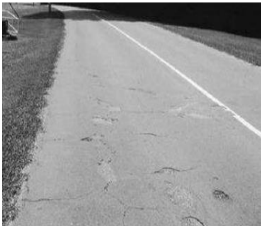
Figura 54 Grado de gravedad (H) - Desprendimiento de agregados.
