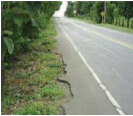
Figura 114 Nivel de gravedad (1) - Erosión de berma.
