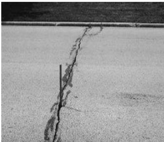
Figura 30 Grado de gravedad (M) - Fisuras longitudinales y transversales.
