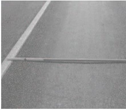
Figura 56 Grado de gravedad (1) - Ahuellamiento.
