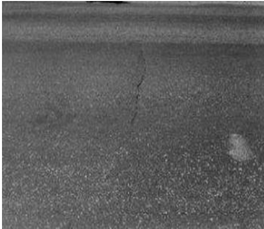
Figura 29 Grado de gravedad (L) - Fisuras longitudinales y transversales.
