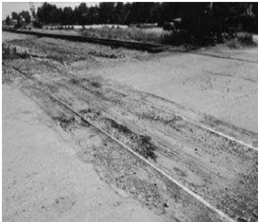
Figura 41 Grado de gravedad (H) - Cruce de vía férrea.
