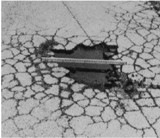
Figura 38 Grado de gravedad (H) - Baches.
