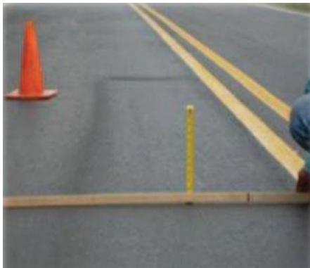
Figura 59 Nivel de severidad (1) - Depresiones longitudinales y transversales.
