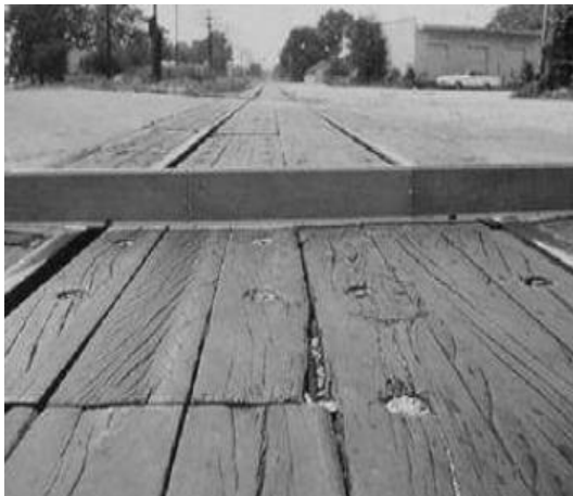
Figura 39 Grado de gravedad (L) - Cruce de vía férrea.
