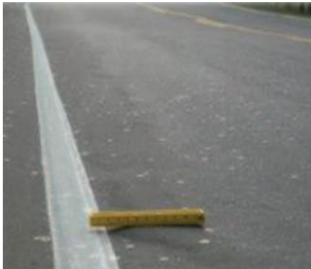
Figura 86 Nivel de gravedad (1) - Desplazamiento de mezcla.
