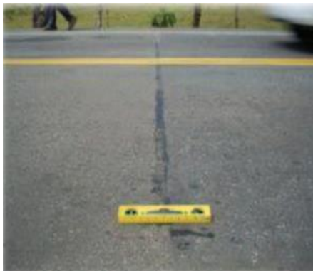
Figura 71 Nivel de gravedad (1) - Fisura longitudinal y transversal junta.
