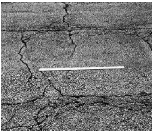
Figura 8 Grado de gravedad: (L) - Fisuras en bloque.
