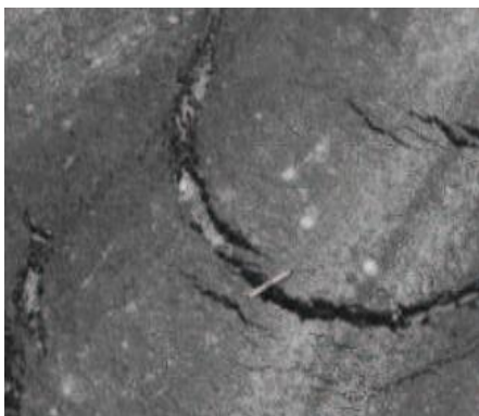
Figura 78 Nivel de gravedad (2) - Fisuras parabólicas.
