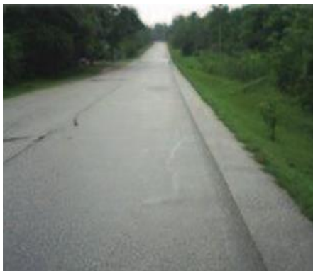
Figura 111 Nivel de gravedad (1) - Escalonamiento entre calzada y berma.
