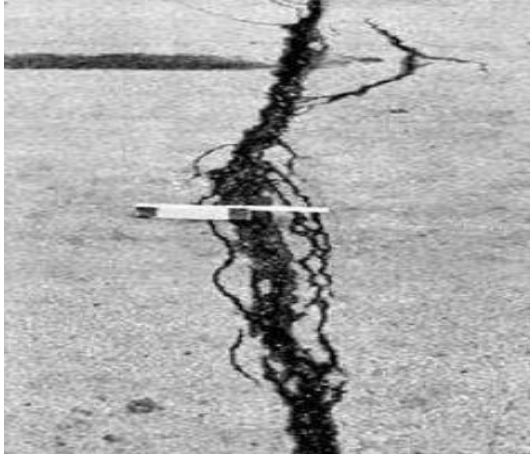
Figura 25 Grado de gravedad (H) - Fisura de reflexión de junta.
