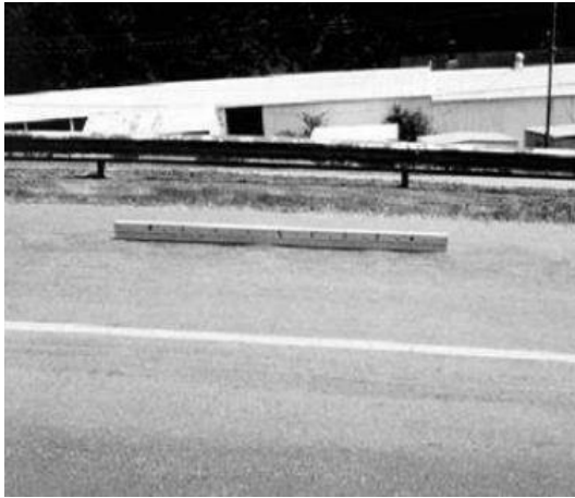
Figura 15 Grado de gravedad (M) - Corrugación.
