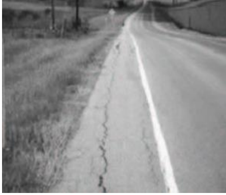
Figura 81 Nivel de gravedad (2) - Grietas de borde.
