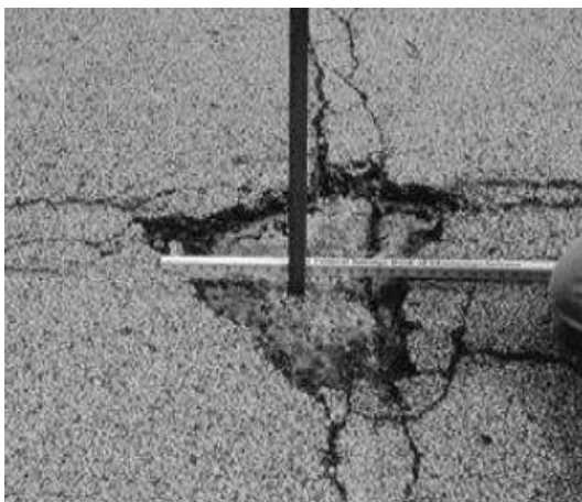
Figura 37 Grado de gravedad (M) - Baches.
