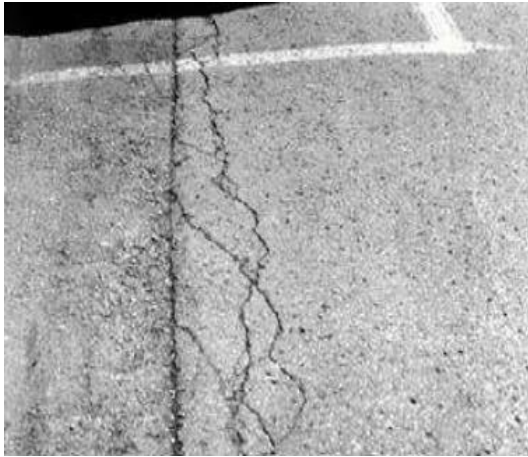
Figura 21 Grado de gravedad (M) - Fisura de borde.
