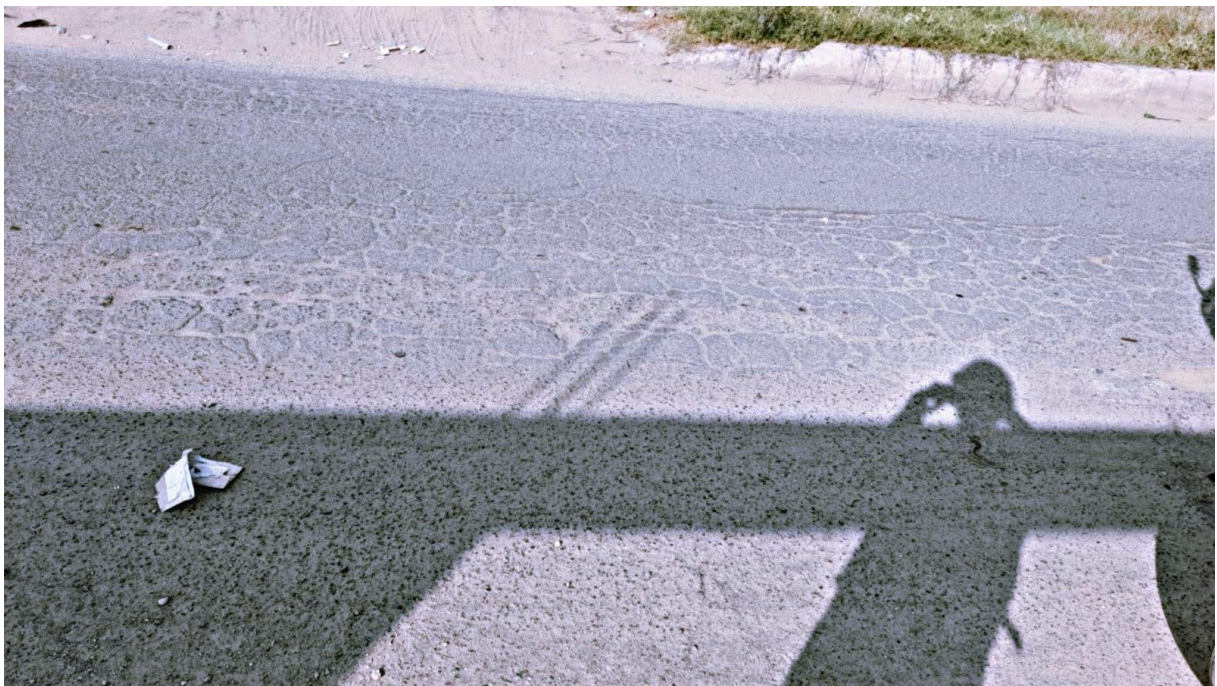
Fotografía 6 Identificación del tipo de falla piel de cocodrilo, nivel de severidad medio.
