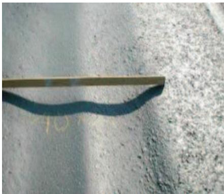
Figura 58 Grado de gravedad (3) - Ahuellamiento.
