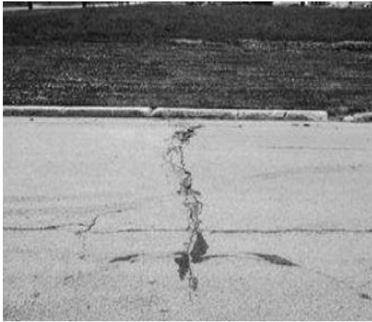
Figura 31 Grado de gravedad (H) - Fisuras longitudinales y transversales.
