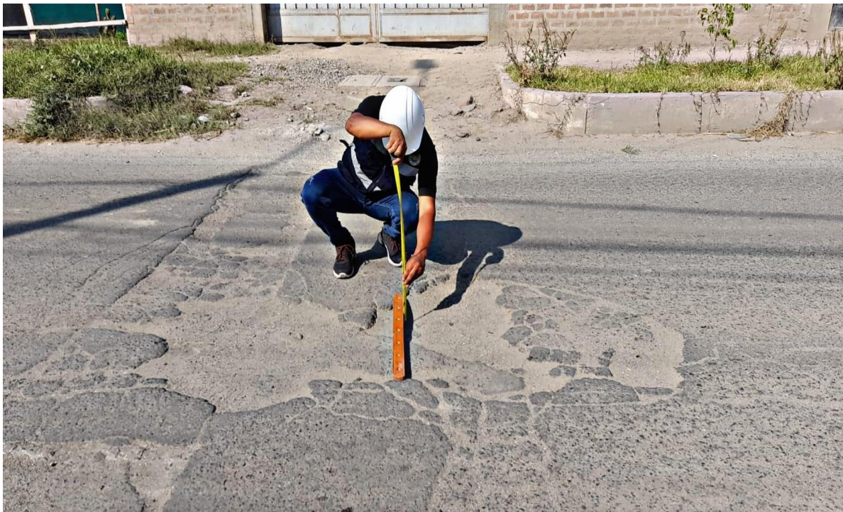
Fotografía 20 Identificación de tipos de fallas parcheo y hueco, nivel de severidad alto.
