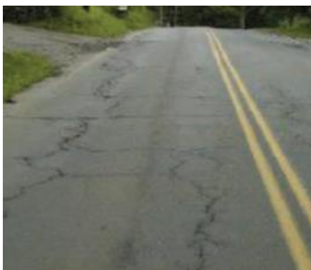
Figura 76 Nivel de gravedad (3) - Grietas de contracción térmica.
