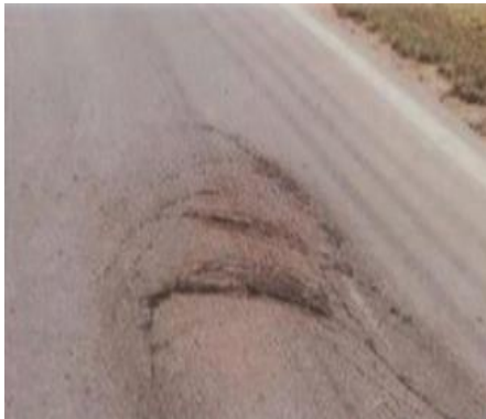
Figura 77 Nivel de gravedad (1) - Fisuras parabólicas.
