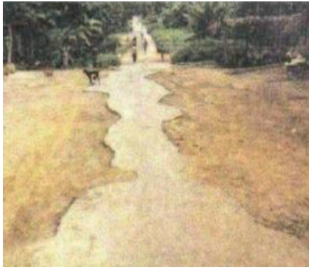
Figura 110 Nivel de gravedad (3) - Desintegración de bordes.
