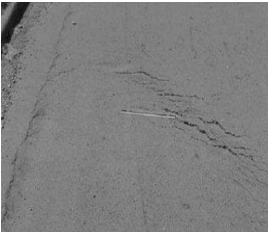
Figura 49 Grado de gravedad (M) - Fisura parabólica.
