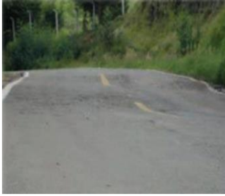
Figura 61 Nivel de severidad (3) - Depresiones longitudinales y transversales.
