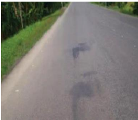
Figura 99 Nivel de gravedad (1) - Exudación.
