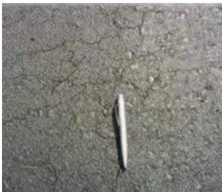
Figura 75 Nivel de gravedad (2) - Grietas de contracción térmica.
