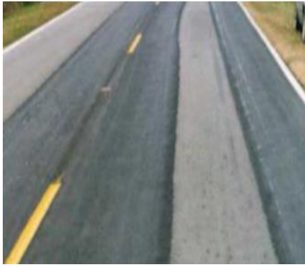
Figura 70 Grado de gravedad (3) - Baches y parcheo.
