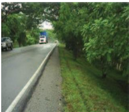
Figura 112 Nivel de gravedad (2) - Escalonamiento entre calzada y berma.
