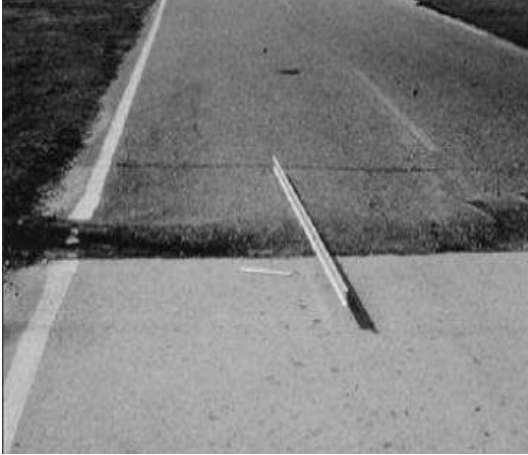
Figura 48 Grado de gravedad (L) - Fisura parabólica.
