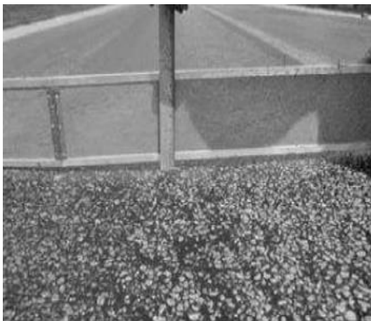
Figura 43 Grado de gravedad (M) - Ahuellamiento.
