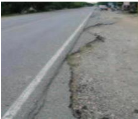
Figura 115 Nivel de gravedad (2) - Erosión de berma.
