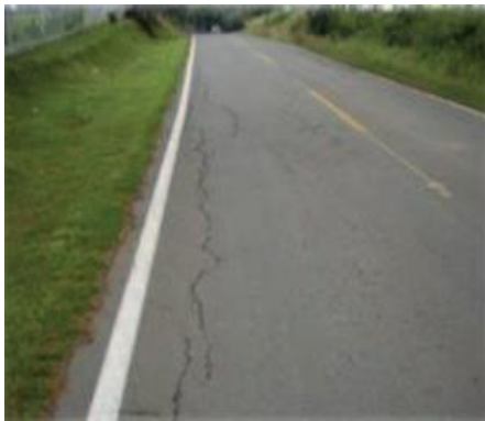
Figura 80 Nivel de gravedad (1) - Grietas de borde.
