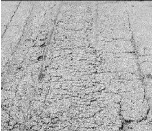
Figura 53 Grado de gravedad (M) - Desprendimiento de agregados.
