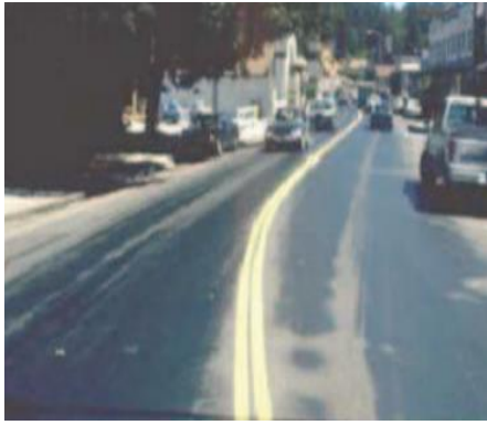
Figura 101 Nivel de gravedad (3) - Exudación.
