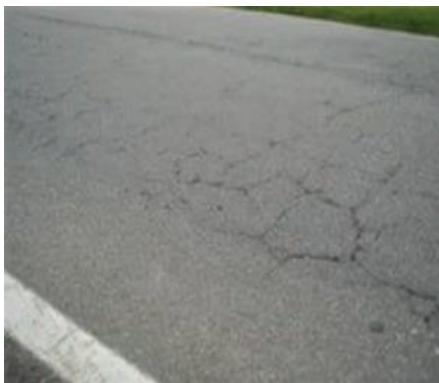
Figura 66 Nivel de gravedad (2) - Fisuras piel de cocodrilo.
