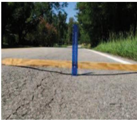
Figura 57 Grado de gravedad (2) - Ahuellamiento.
