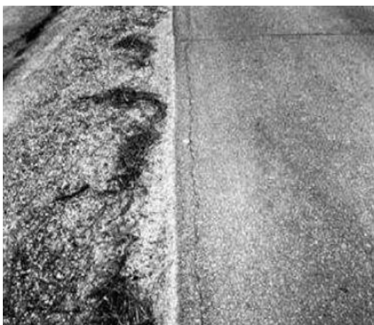
Figura 20 Grado de gravedad (L) - Fisura de borde.
