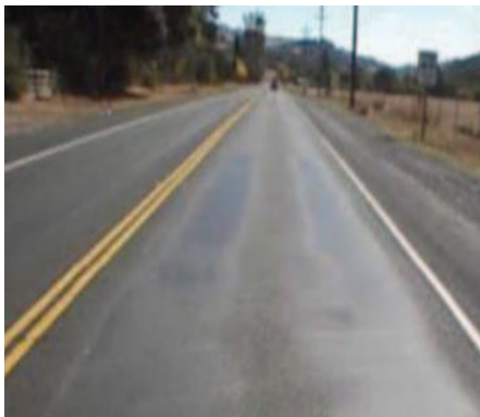
Figura 100 Nivel de gravedad (2) - Exudación.
