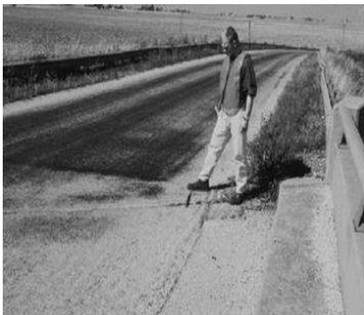
Figura 45 Grado de gravedad (L) - Desplazamiento.
