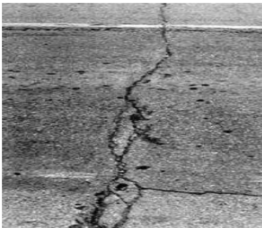
Figura 24 Grado de gravedad (M) - Fisura de reflexión de junta.
