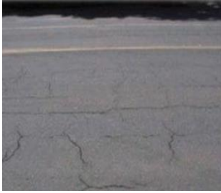
Figura 65 Nivel de gravedad (1) - Fisuras piel de cocodrilo.
