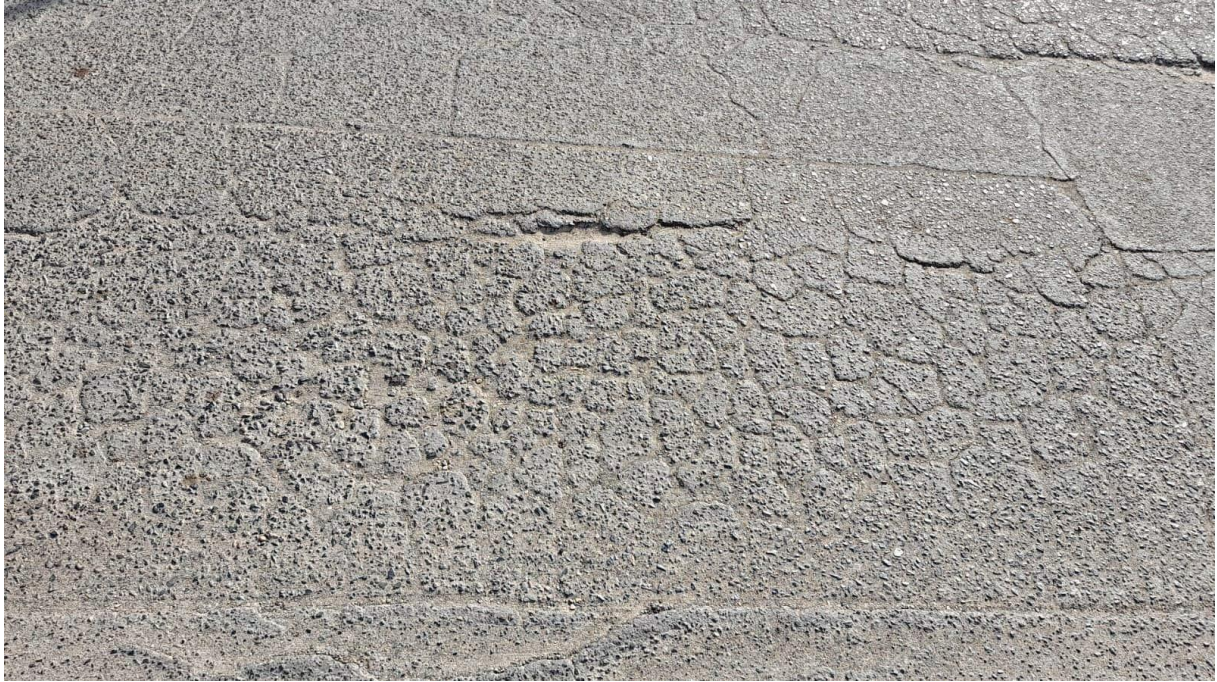
Fotografía 3 Identificación del tipo de falla piel de cocodrilo, nivel de severidad medio.
