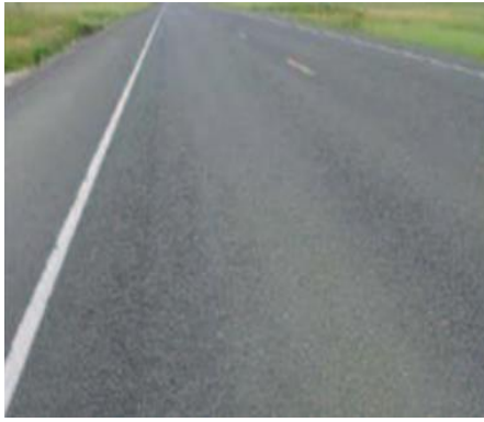
Figura 92 Nivel de gravedad (1) - Pérdida de agregados.
