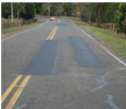
Figura 69 Grado de gravedad (2) - Baches y parcheo.
