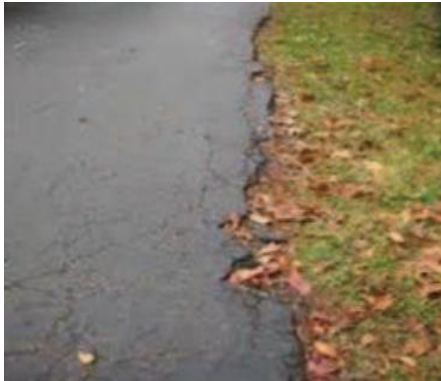
Figura 108 Nivel de gravedad (1) - Desintegración de bordes.
