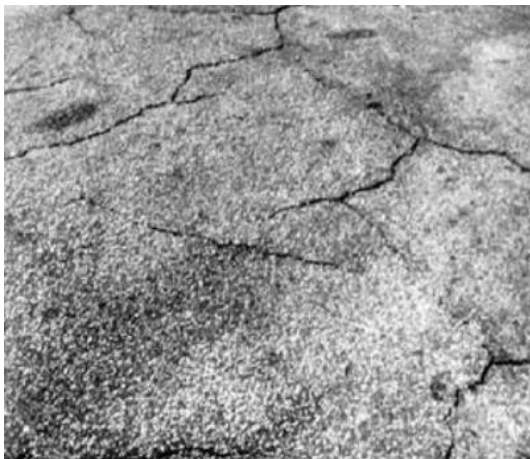
Figura 10 Grado de gravedad (H) - Fisuras en bloque.
