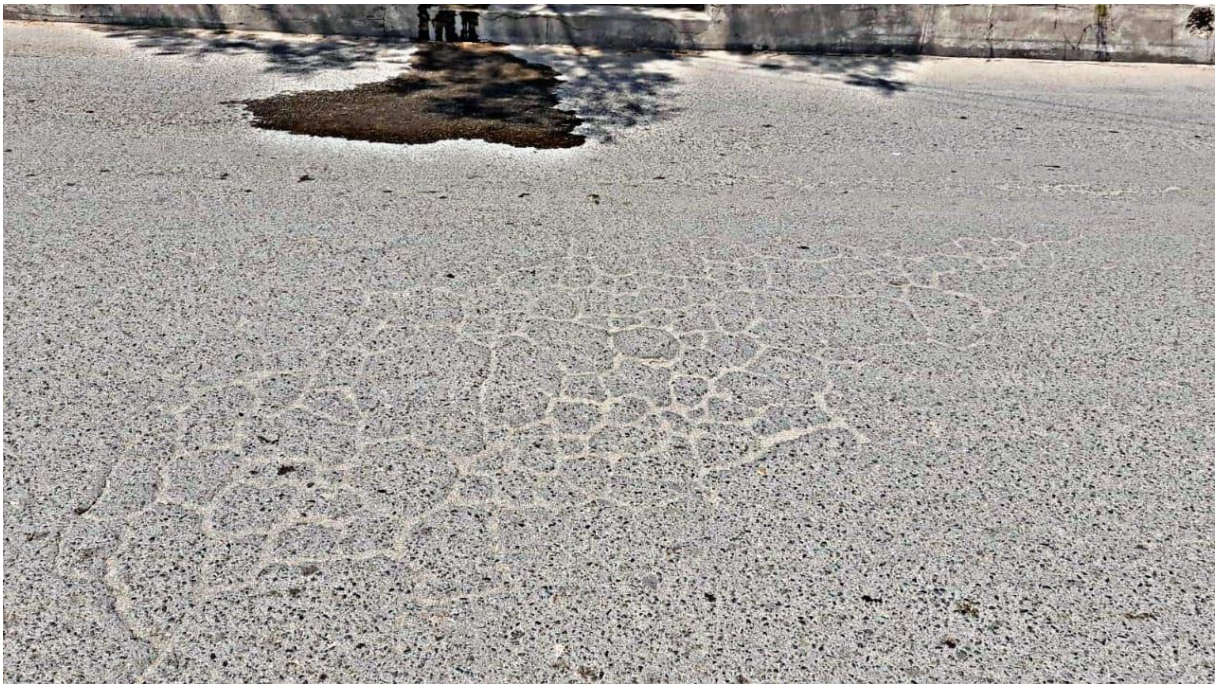
Fotografía 4 Identificación del tipo de falla piel de cocodrilo, nivel de severidad medio.
