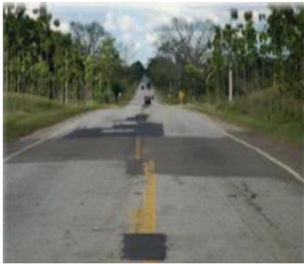
Figura 68 Grado de gravedad (1) - Baches y parcheo.
