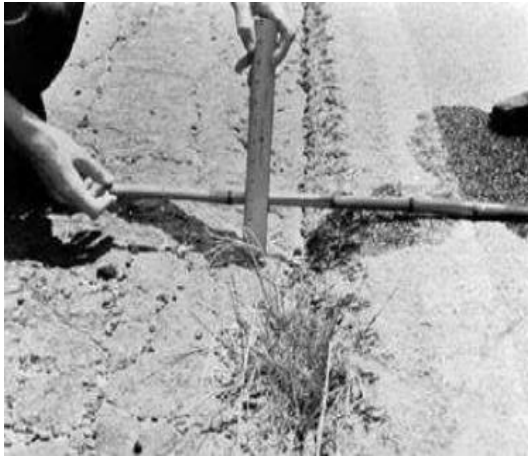
Figura 27 Grado de gravedad (M) - Desnivel carril, berma.
