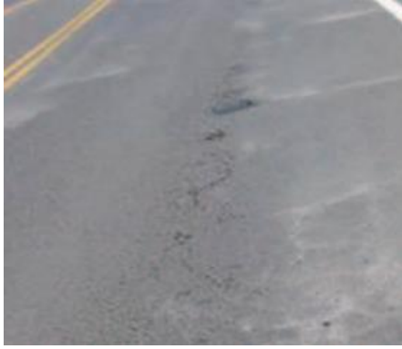
Figura 103 Nivel de gravedad (2) - Afloramiento de mortero.
