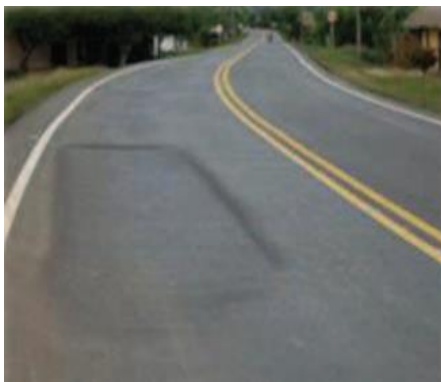
Figura 60 Nivel de severidad (2) - Depresiones longitudinales y transversales.
