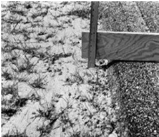
Figura 26 Grado de gravedad (L) - Desnivel carril, berma.
