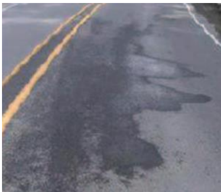
Figura 107 Nivel de gravedad (3) - Afloramiento de agua.
