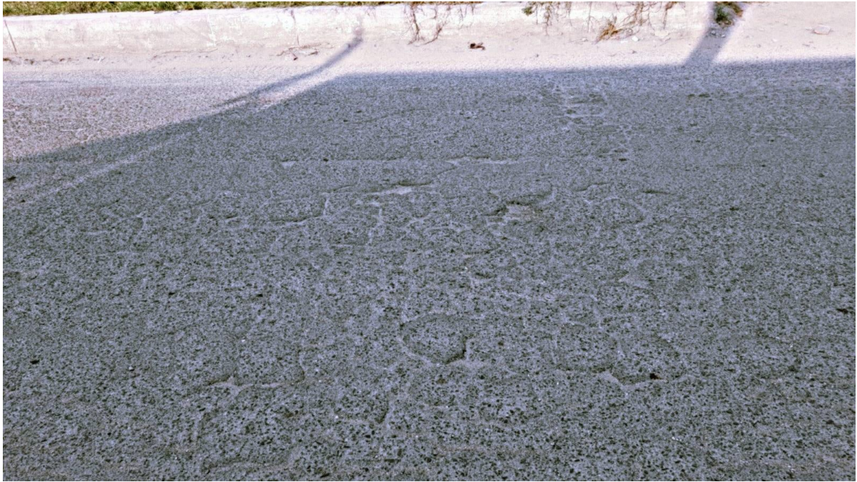
Fotografía 5 Identificación del tipo de falla piel de cocodrilo, nivel de severidad medio.
