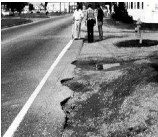
Figura 22 Grado de gravedad (H) - Fisura de borde.
