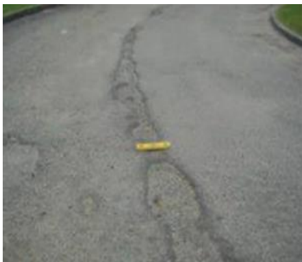
Figura 73 Nivel de gravedad (3) - Fisura longitudinal y transversal junta.
