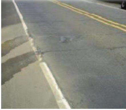
Figura 105 Nivel de gravedad (1) - Afloramiento de agua.
