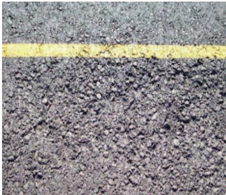
Figura 117 Nivel de gravedad (1), (2) y (3) - Segregación.
