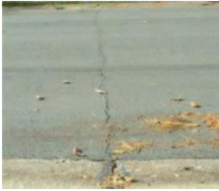
Figura 74 Nivel de gravedad (1) - Grietas de contracción térmica.
