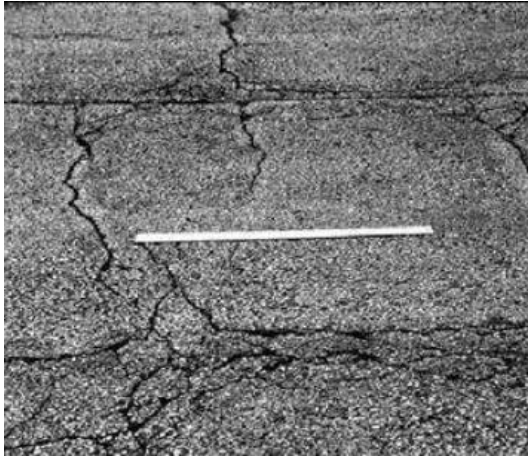
Figura 11 Grado de gravedad (L) - Abultamientos y hundimientos.
