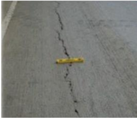
Figura 63 Nivel de gravedad (2) - Fisuras longitudinales por fatiga.
