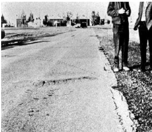
Figura 12 Grado de gravedad (M) - Abultamientos y hundimientos.
