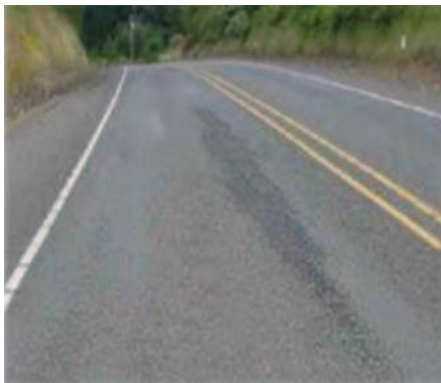
Figura 89 Nivel de gravedad (1) - Pérdida de película de ligante.
