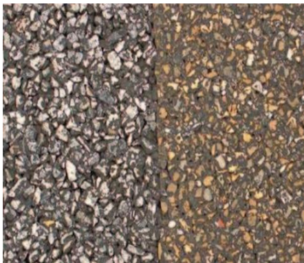
Figura 98 Nivel de gravedad (1), (2) y (3) - Pulimento de agregados.
