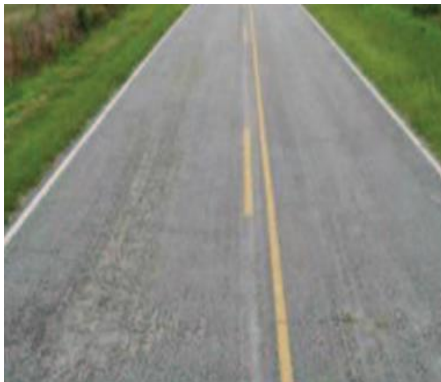
Figura 93 Nivel de gravedad (2) - Pérdida de agregados.
