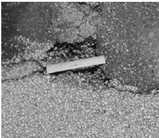
Figura 36 Grado de gravedad (L) - Baches.
