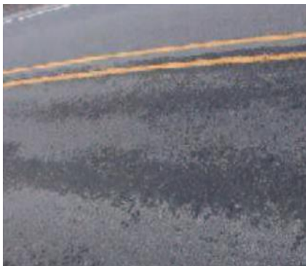
Figura 106 Nivel de gravedad (2) - Afloramiento de agua.
