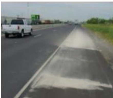
Figura 104 Nivel de gravedad (3) - Afloramiento de mortero.
