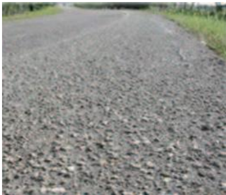
Figura 91 Nivel de gravedad (3) - Pérdida de película de ligante.
