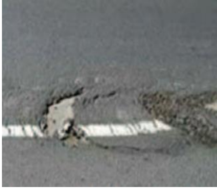
Figura 79 Nivel de gravedad (3) - Fisuras parabólicas.
