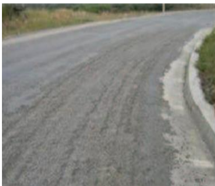
Figura 94 Nivel de gravedad (3) - Pérdida de agregados.
