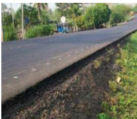
Figura 113 Nivel de gravedad (3) - Escalonamiento entre calzada y berma.
