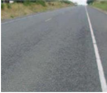
Figura 90 Nivel de gravedad (2) - Pérdida de película de ligante.
