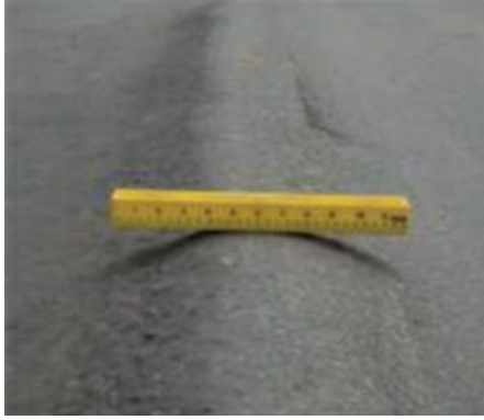
Figura 88 Nivel de gravedad (3) - Desplazamiento de mezcla.
