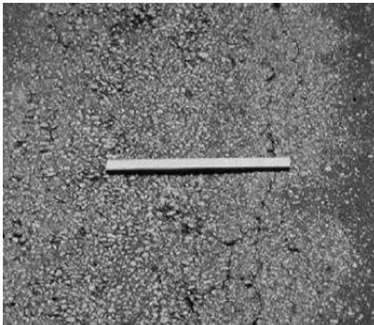
Figura 52 Grado de gravedad (L) - Desprendimiento de agregados.
