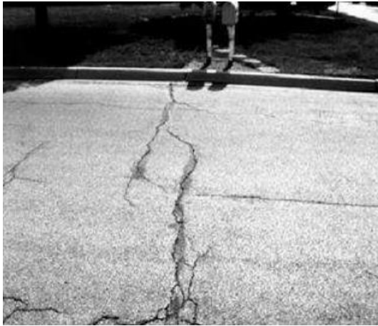
Figura 9 Grado de gravedad (M) - Fisuras en bloque.
