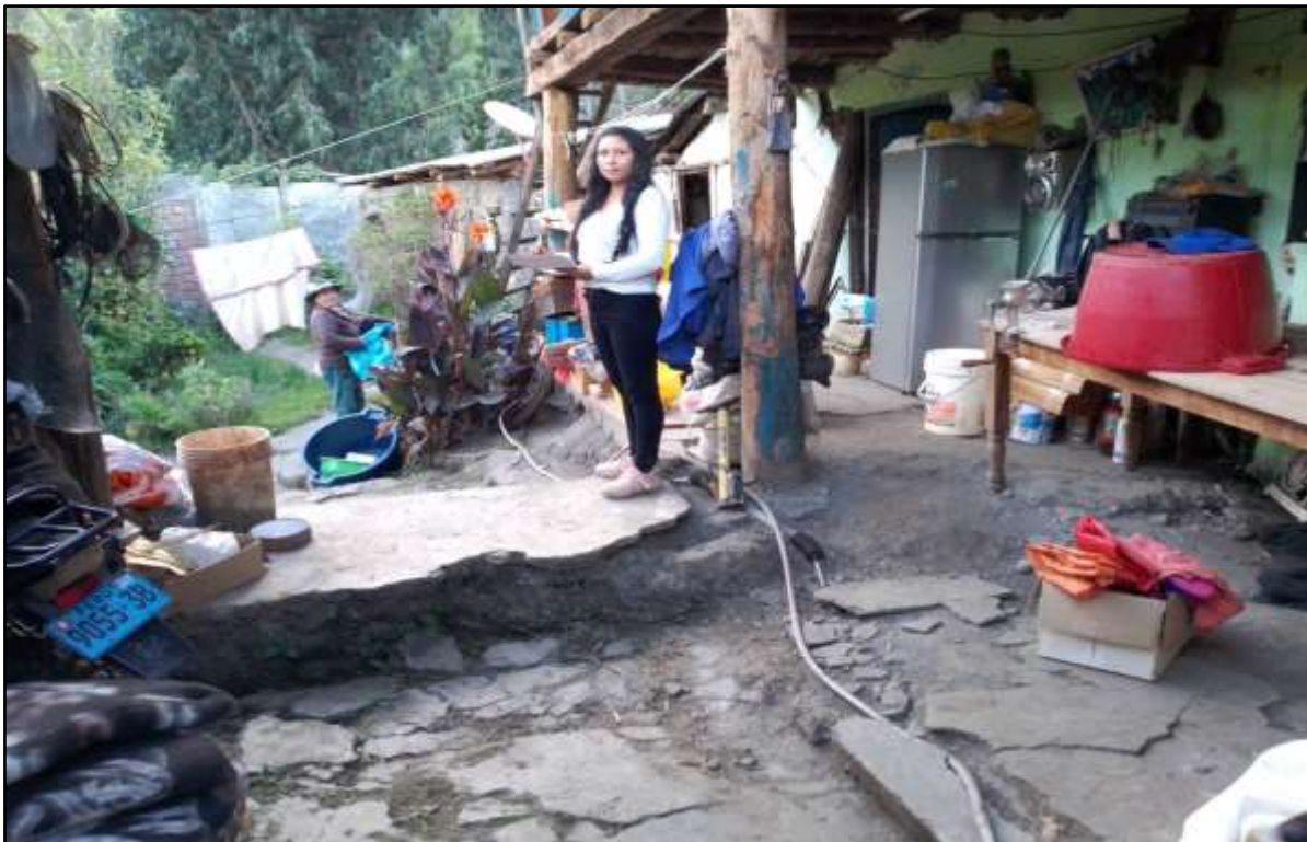
Figura 65. Vista del nivel de piso por donde pasa el deslizamiento
