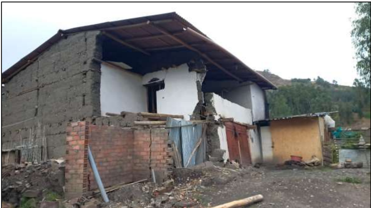
Figura 67. Vista de la vivienda edificada hace dos años totalmente deteriorada por la activación del deslizamiento.
