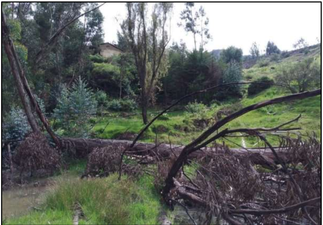
Figura 53. Zona baja donde resulta el agua de infiltración en el que se ve el escarpe del deslizamiento.
