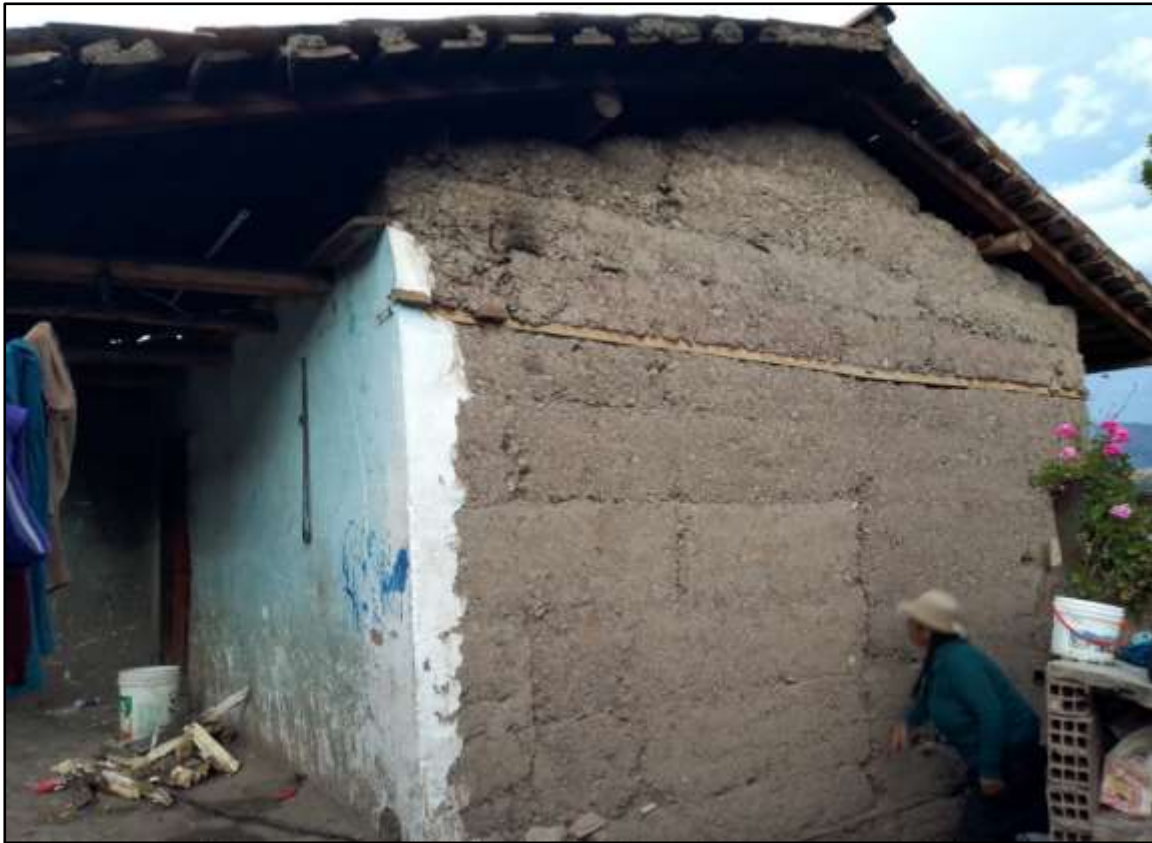
Figura 60. Vista de la vivienda que presenta rajaduras en las paredes
