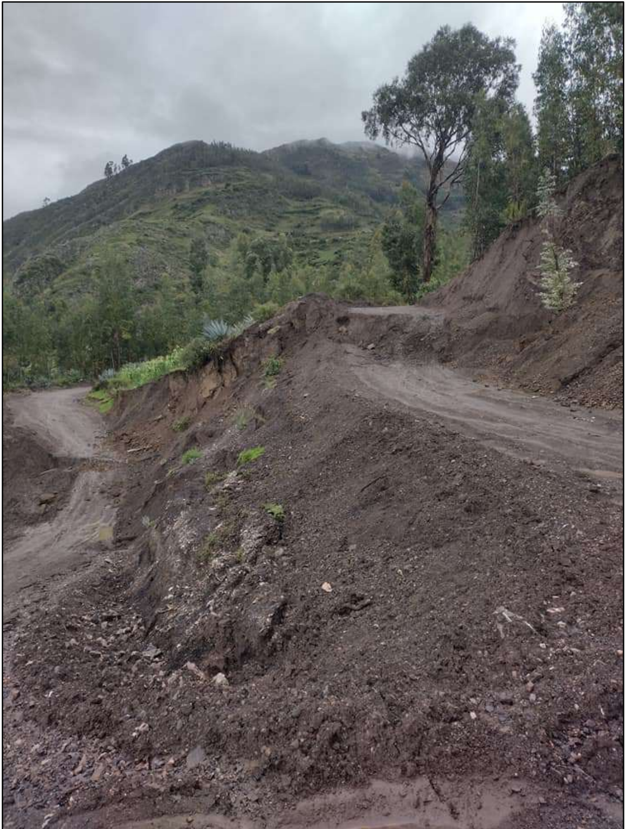
Figura 59. Vista del tramo de la carretera con deslizamiento constante
