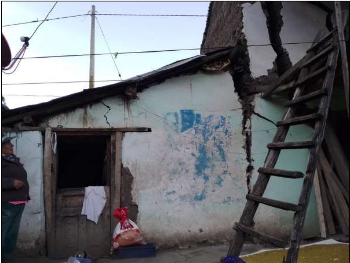
Figura 66. Vista de la rajadura en la pared de la vivienda como consecuencia del deslizamiento que atraviesa la vivienda.
