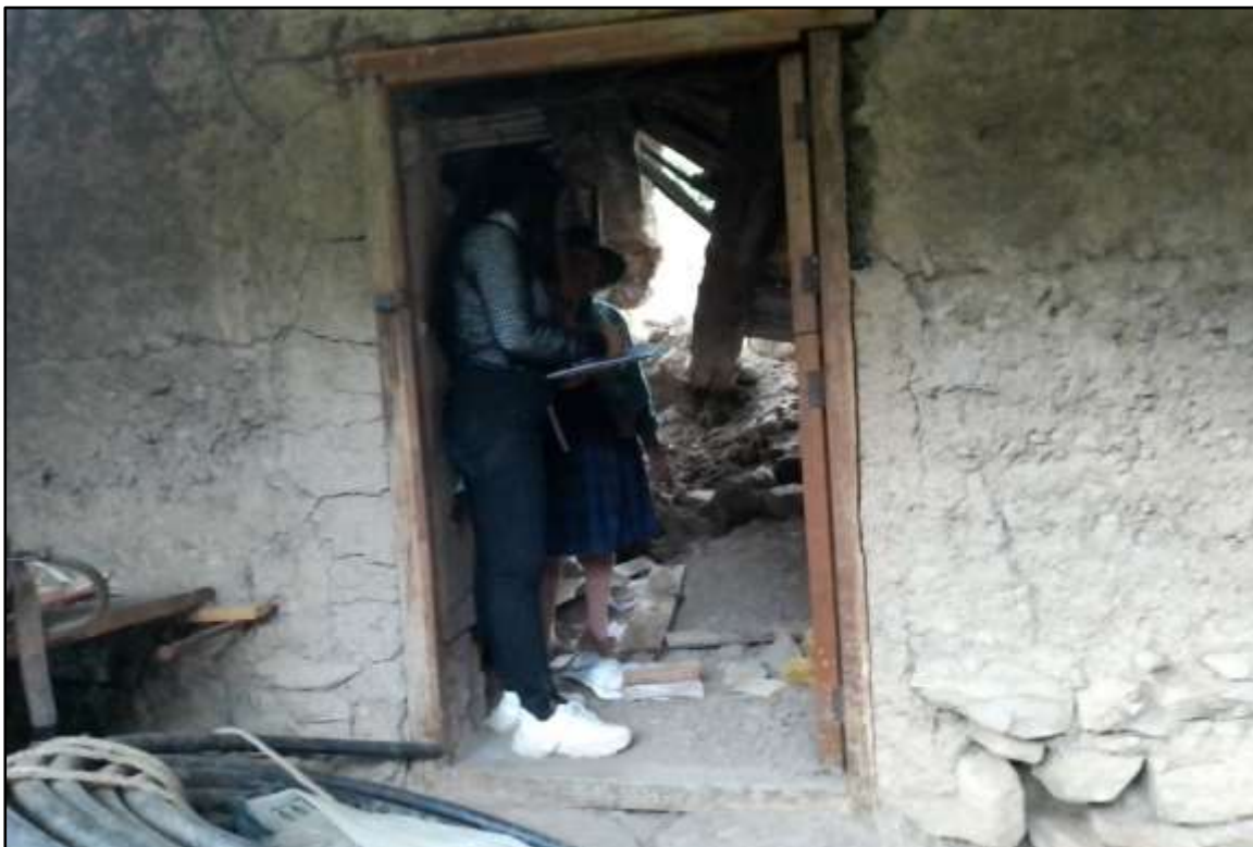
Figura 61. Vista interior de la vivienda colapsada a causa de las grietas tensionales del deslizamiento de la zona.
