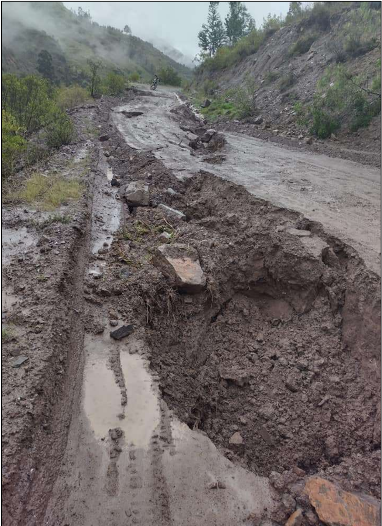
Figura 58. Carretera obstruida por las intensas lluvias
