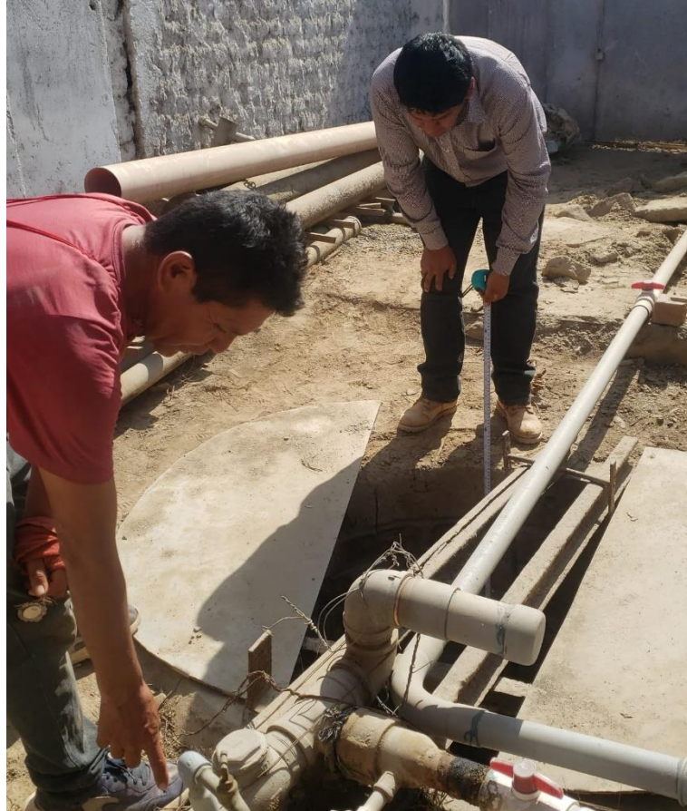
Figura 5. Tuberías de Impulsión de la captación.
