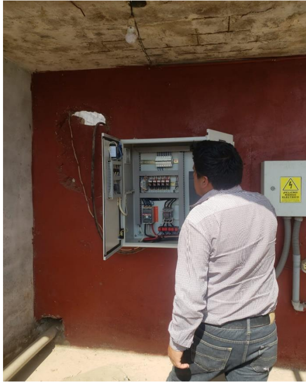
Figura 6. Tablero de control eléctrico del CCPP Palpa.
