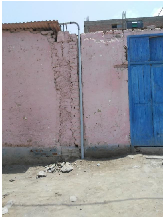
Figura 8. Red de distribución de agua, encima de viviendas.
