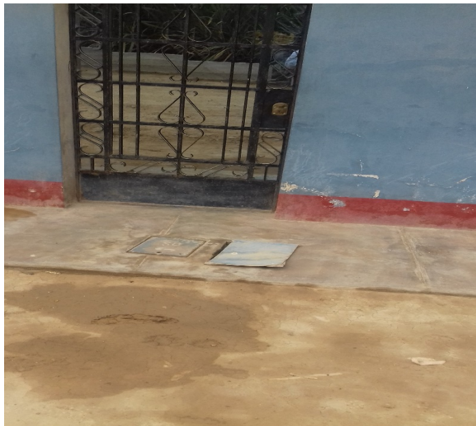
FOTO N°23: CONEXION DOMICILIARI C.P CHAMBARA ALTA, NOTECE CAJA, MARCO Y TAPA DE CAJA DE REGISTRO DOMICILIARIO, CABE MENCIONAR QUE NO SE CUENTA CON MICROMEDICION.
