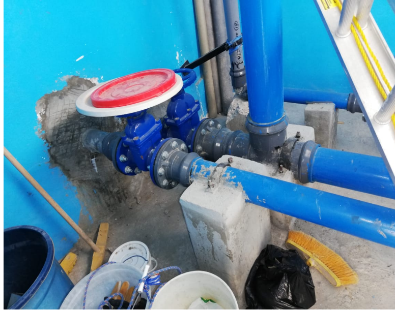
FOTO N°17: VISTA DE VALVULAS EN LA CASETA DEL RESERVORIO
