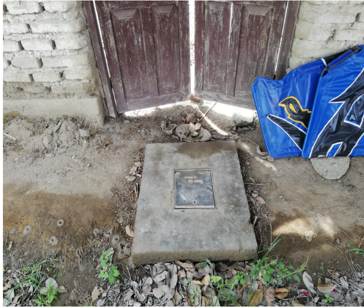
FOTO N°21: CONEXION DOMICILIARI C.P CHAMBARA BAJA, NOTECE CAJA, MARCO Y TAPA DE CAJA DE REGISTRO DOMICILIARIO, CABE MENCIONAR QUE NO SE CUENTA CON MICROMEDICION..
