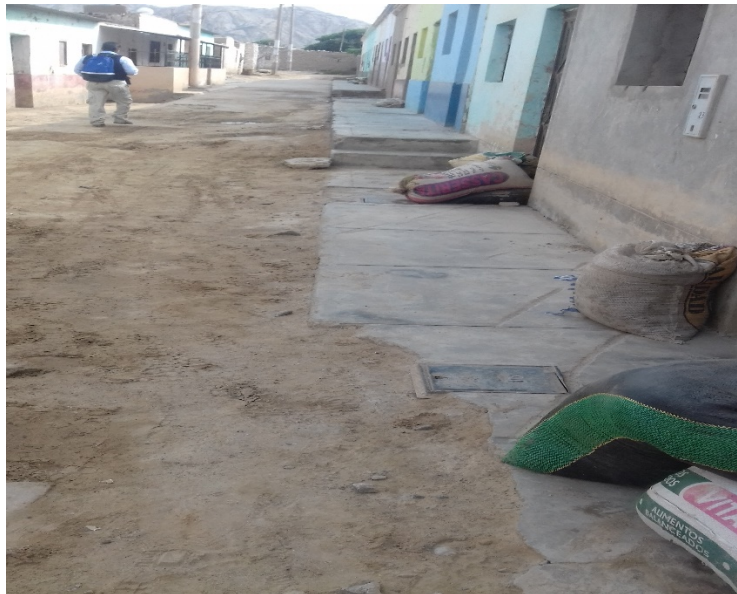
FOTO N°22: CONEXION DOMICILIARI C.P CHAMBARA ALTA, NOTECE CAJA, MARCO Y TAPA DE CAJA DE REGISTRO DOMICILIARIO, CABE MENCIONAR QUE NO SE CUENTA CON MICROMEDICION..
