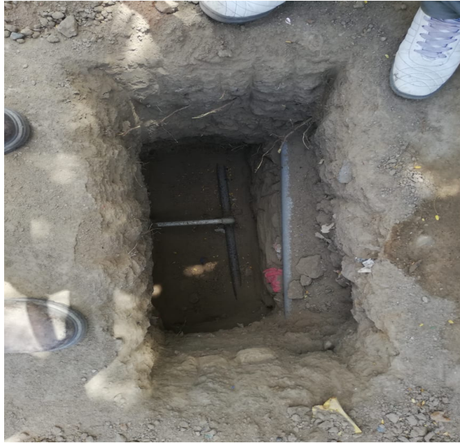
FOTO N°19: EXCAVACION DE EXPLORACION PARA VERIFICAR LA TUBERIA DE DISTRIBUCION QUE PASA EN EL C.P DE CHAMBARA BAJA
