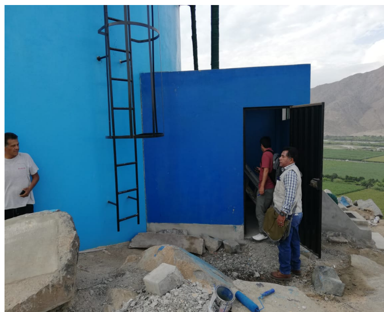
FOTO N°16: VISTA DE LA CASETA DE VALVULAS DEL RESERVORIO, EN COMPAÑÍA CON EL PERSONAL DE LA JASS CHAMBARA
