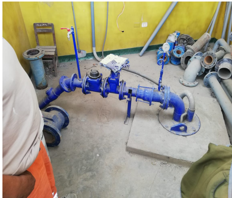
FOTO N°8: VISTA DEL POSO TUBULAR, NOTECE TUBERIA DE SUCCION DE FIERRO CON SUS RESPECTIVOS ACCESORIOS
