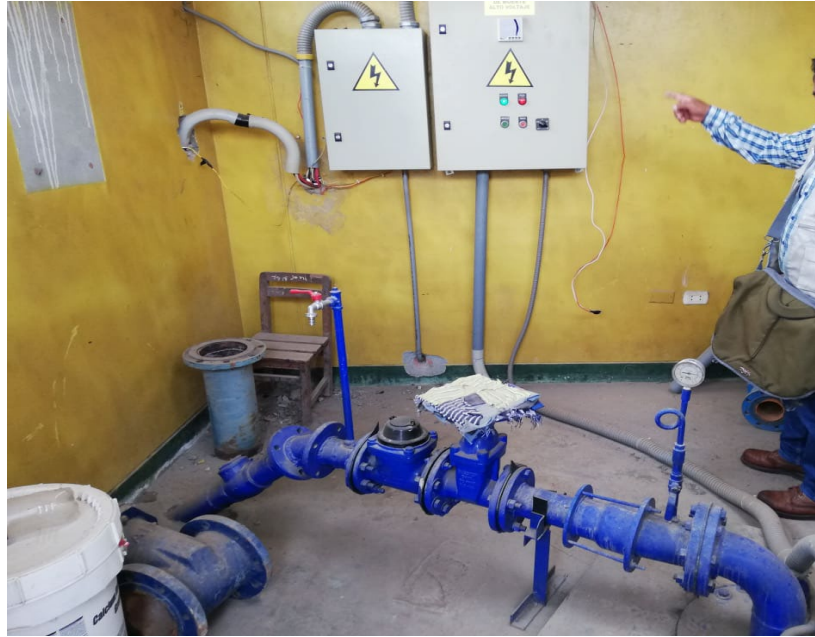
FOTO N°11: CONTINUACION DE LA VISTA DEL POSO TUBULAR Y TUBERIA METALICA DE SUCCION DE 6" CON SUS RESPECTIVA MANOMETRO Y VALUVA CHECK..
