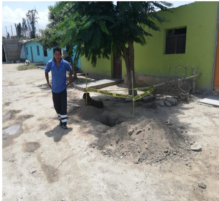
FOTO N°20: EXCAVACION DE EXPLORACION PARA VERIFICAR LA TUBERIA DE DISTRIBUCION QUE PASA EN EL C.P DE LOS ANGELES
