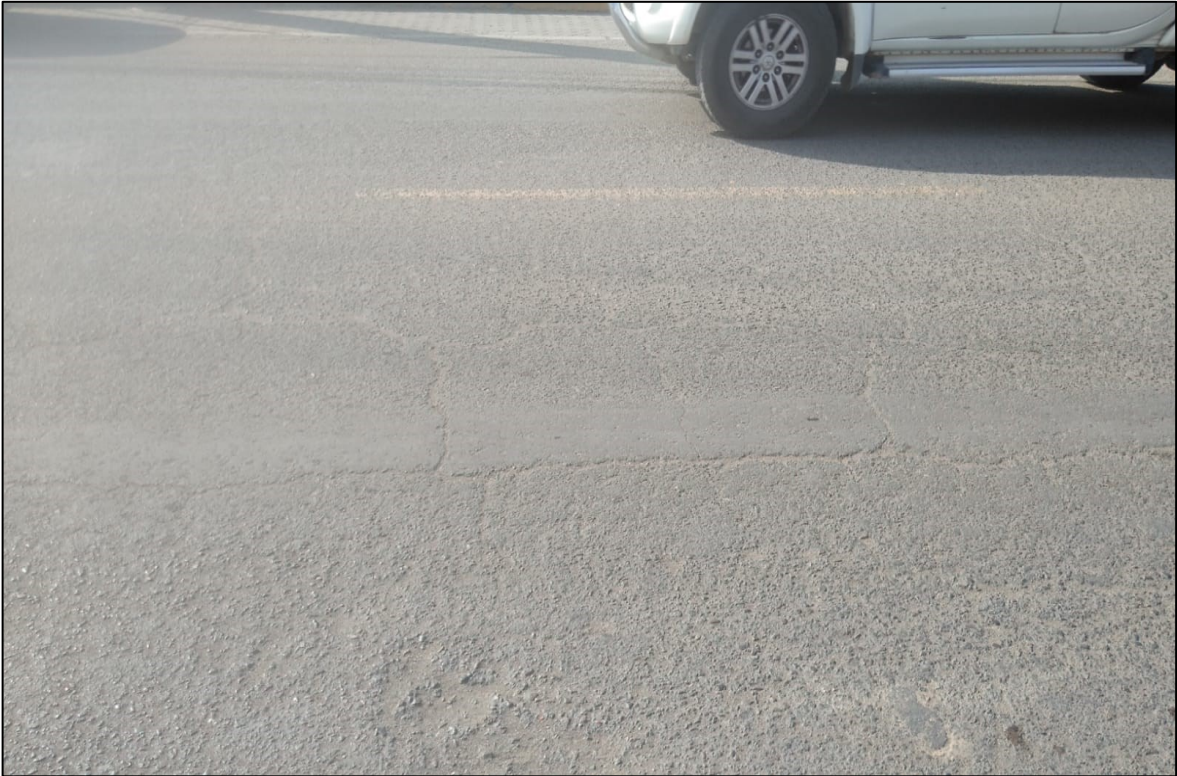
Nota: Identificación sobre grietas transversales y longitudinales.
