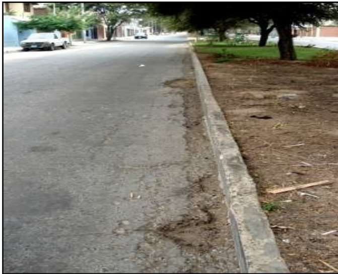
Figura 10. Fisura de Borde.
