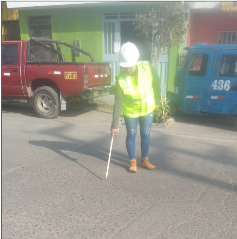
Nota: Identificación del agrietamiento en bloque del pavimento.
