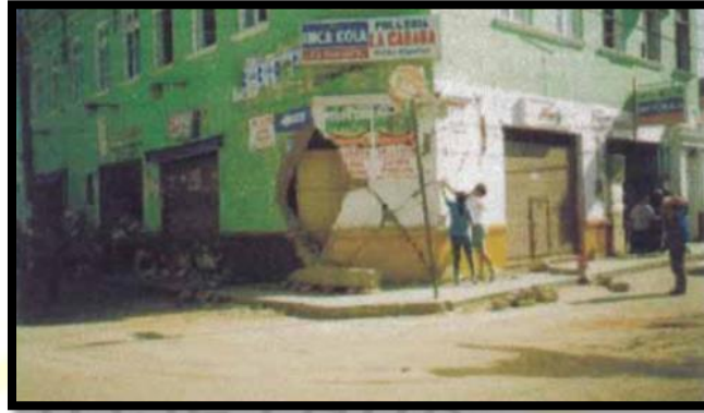
Figura N° 10: Falla en esquina de una estructura de concreto armado
