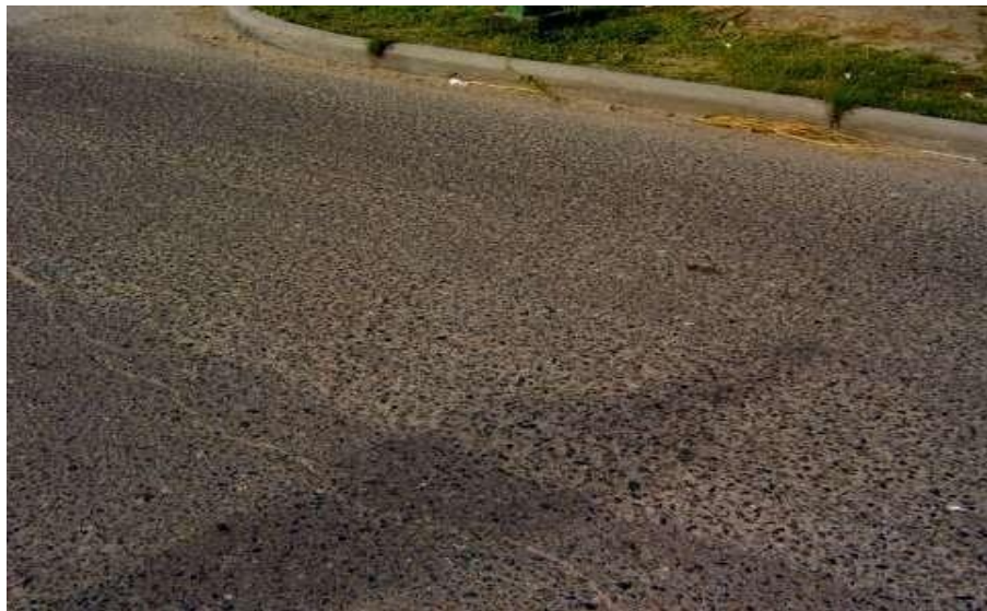
Desprendimiento de Compuesto
