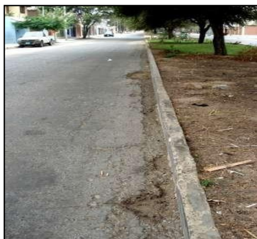
Grieta al Borde
