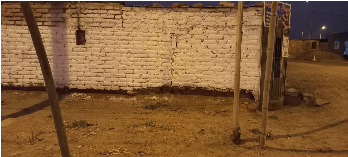
Figura 19. Ausencia de elementos verticales y deterioro de muros en la vivienda n° 08 en calle paralela a la transversal a la principal del sector Santa Cruz.
