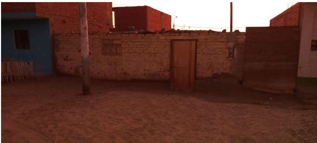
Figura 18. Ausencia de elementos verticales y deterioro de muros en la vivienda n° 07 en calle transversal a la principal del sector Santa Cruz.
