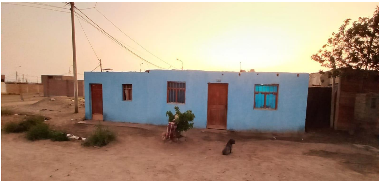
Figura 12. Presencia de patología de salitre en cimentación de la vivienda n° 04 en calle principal del sector Santa Cruz.
