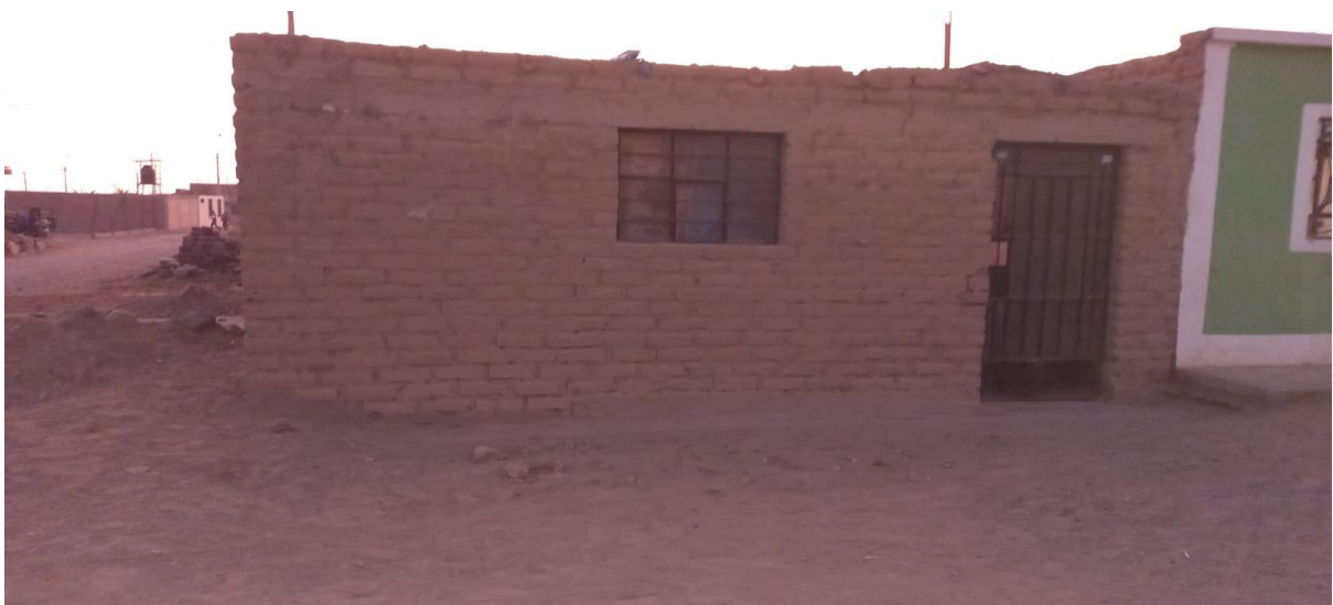
Figura 16. Ausencia de elementos verticales en la vivienda n° 06 en calle transversal a la principal del sector Santa Cruz.
