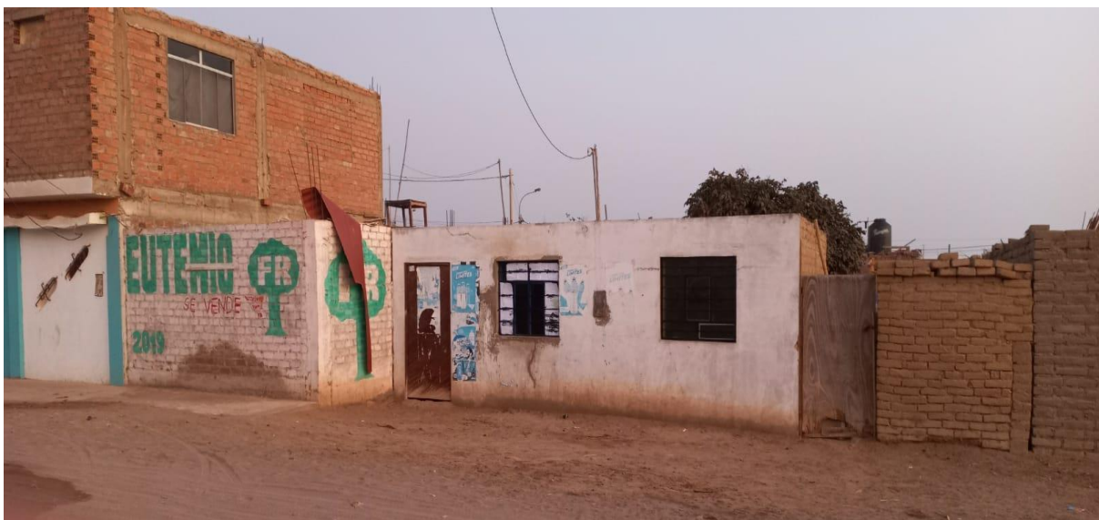
Figura 10. Presencia de fisuras y grietas en muros de la vivienda n° 03 en calle principal del sector Santa Cruz.
