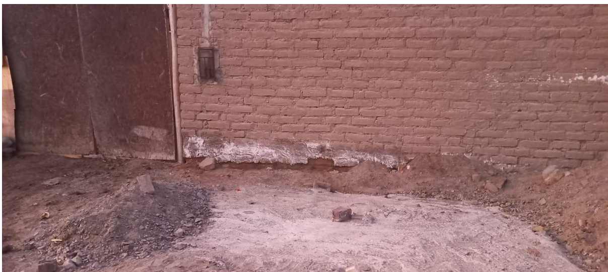
Figura 14. Presencia de patología salitre en cimentación de la vivienda n° 05 en calle principal del sector Santa Cruz.
