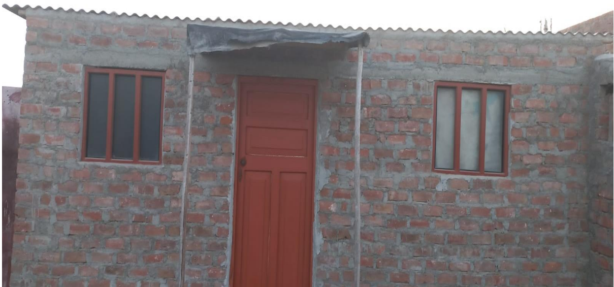
Figura 6. Ausencia de elementos verticales en vivienda n° 01 en calle sin número del sector Santa Cruz.
