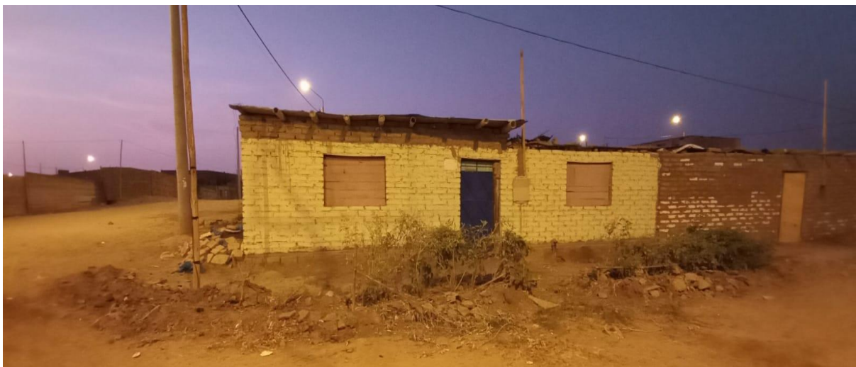
Figura 22. Presencia de patología en cimentación de la vivienda n° 09 en calle paralela a la transversal a la principal del sector Santa Cruz.
