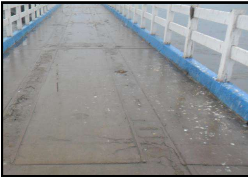
Figura 29: Excremento de Aves en el Piso del Muelle
