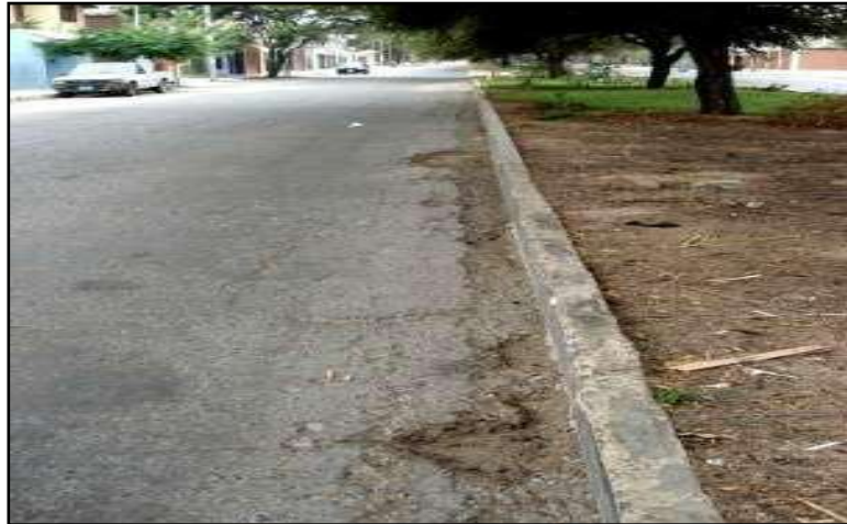
Grieta lateral de este limite
