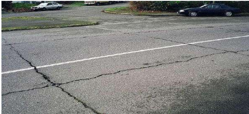
Grieta de Reflexión de Junta
