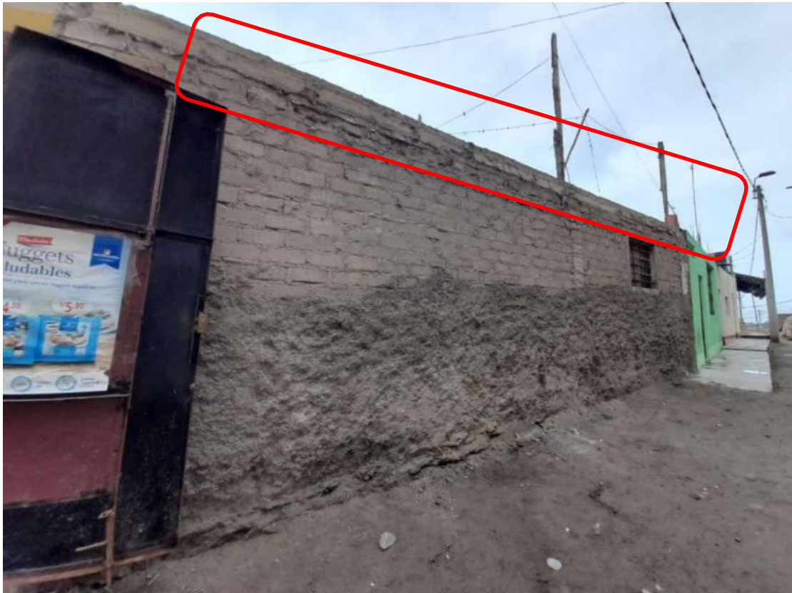
Figura 14. Ausencia de cobertura en la vivienda 03, en el pasaje Gamarra.
