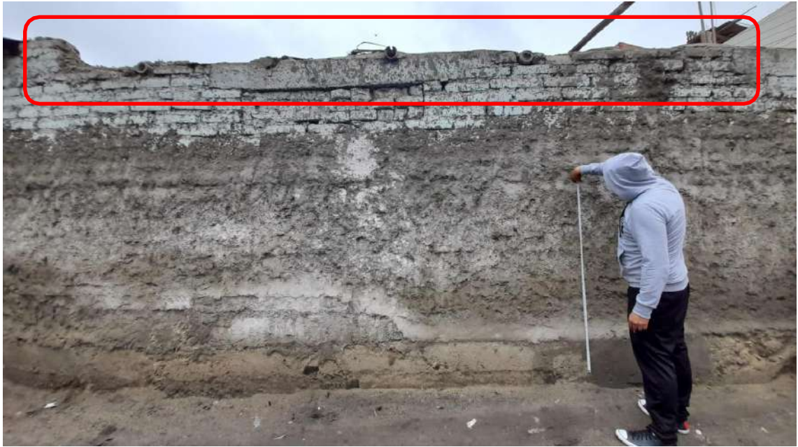
Figura 6. Ausencia de cobertura en la vivienda 01, en la calle los Sauces.
