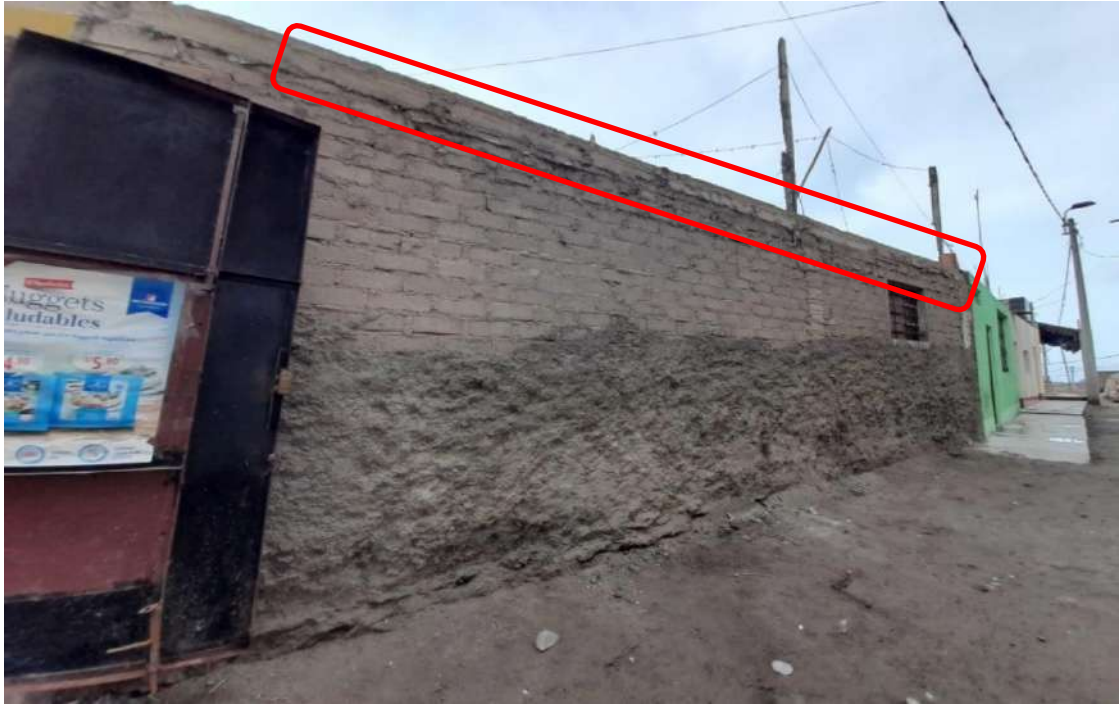
Figura 11. Ausencia de confinamiento con elementos estructurales en la vivienda 03, en el pasaje Gamarra.
