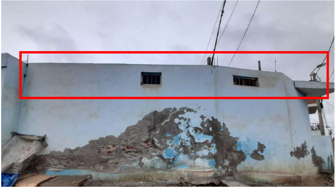
Figura 46. Presencia de losa rígida en la vivienda 11, en la mitad de la calle los Sauces.
