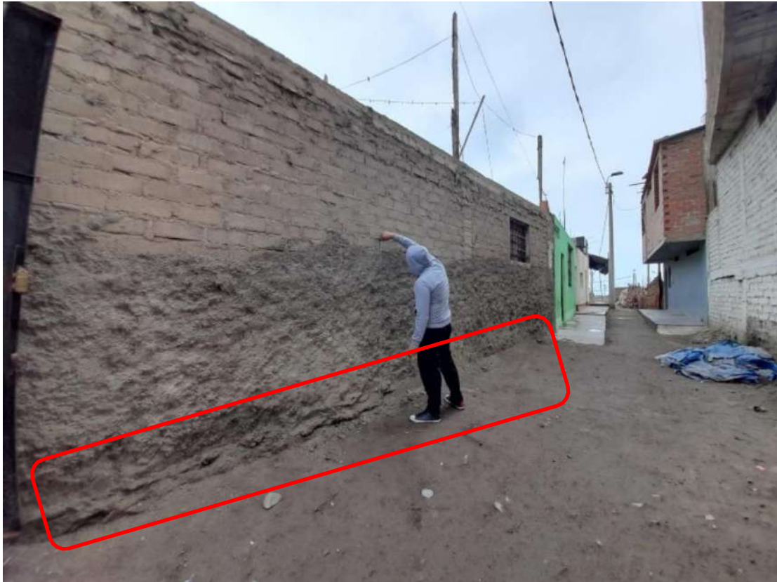
Figura 13. Inclinación del terreno y ausencia de vigas de cimentación en la vivienda 03, en el pasaje Gamarra.
