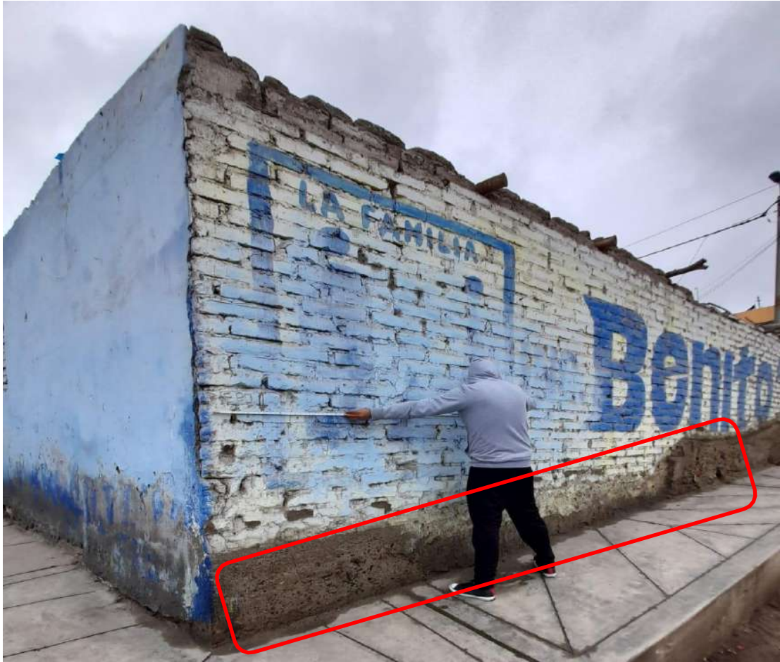
Figura 09. Inclinación del terreno y ausencia de vigas de cimentación en la vivienda 02, en la calle los Laureles.
