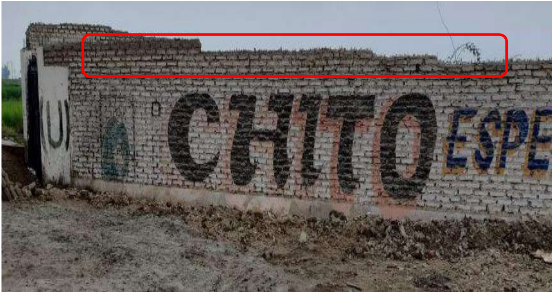
Figura 34. Ausencia de cobertura en la vivienda 08, en calle 16 de junio colindante al descampado.
