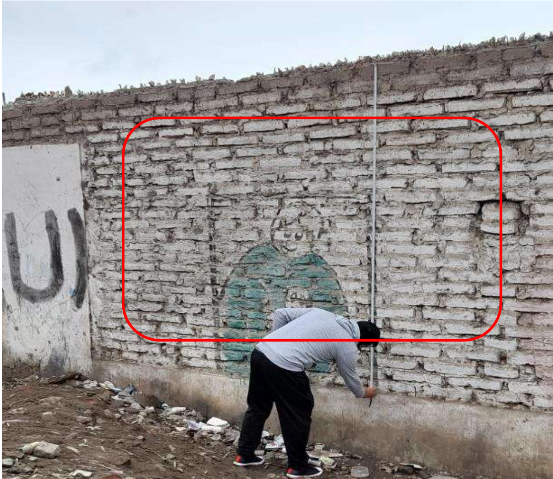
Figura 32. Falta de calidad de las unidades de mampostería requerida en la vivienda 08, en calle 16 de junio colindante al descampado.
