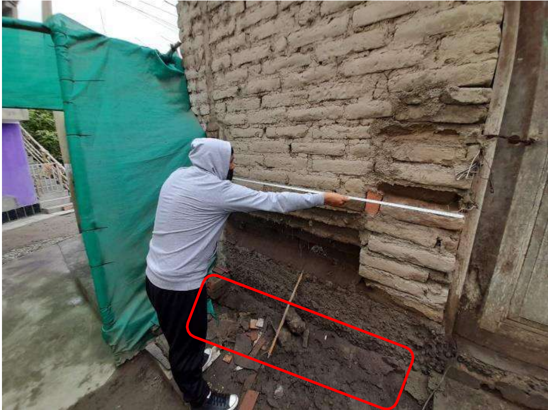
Figura 17. Inclínación del terreno y ausencia de vigas de cimentación en la vivienda 04, finalizando la calle los Laureles.
