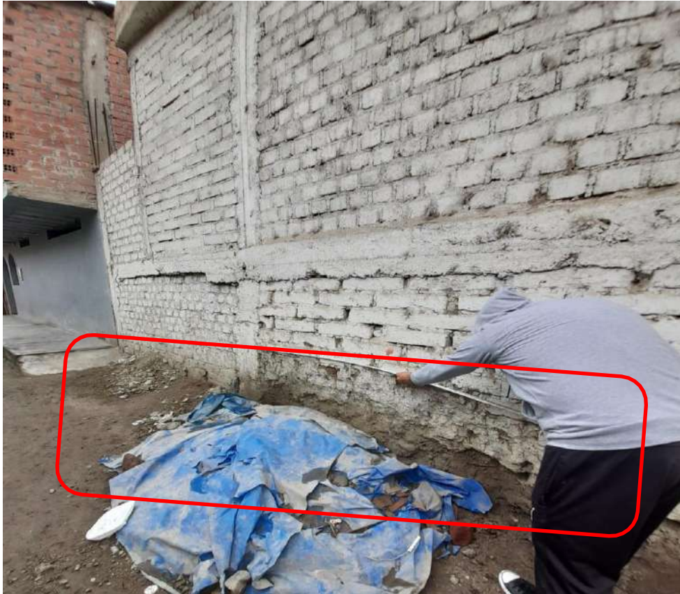
Figura 41. Inclínación del terreno y ausencia de vigas de cimentación en la vivienda 10, en la intersección de Daniel Tapia con pasaje Gamarra.
