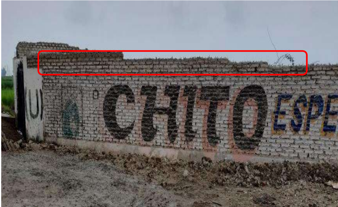
Figura 31. Ausencia de confinamiento con elementos estructurales en la vivienda 08, en calle 16 de junio colindante al descampado.
