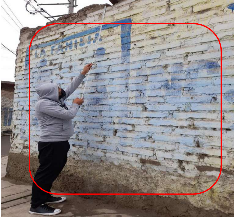
Figura 08. Falta de calidad de las unidades de mampostería requerida en la vivienda 02, en la calle los Laureles.
