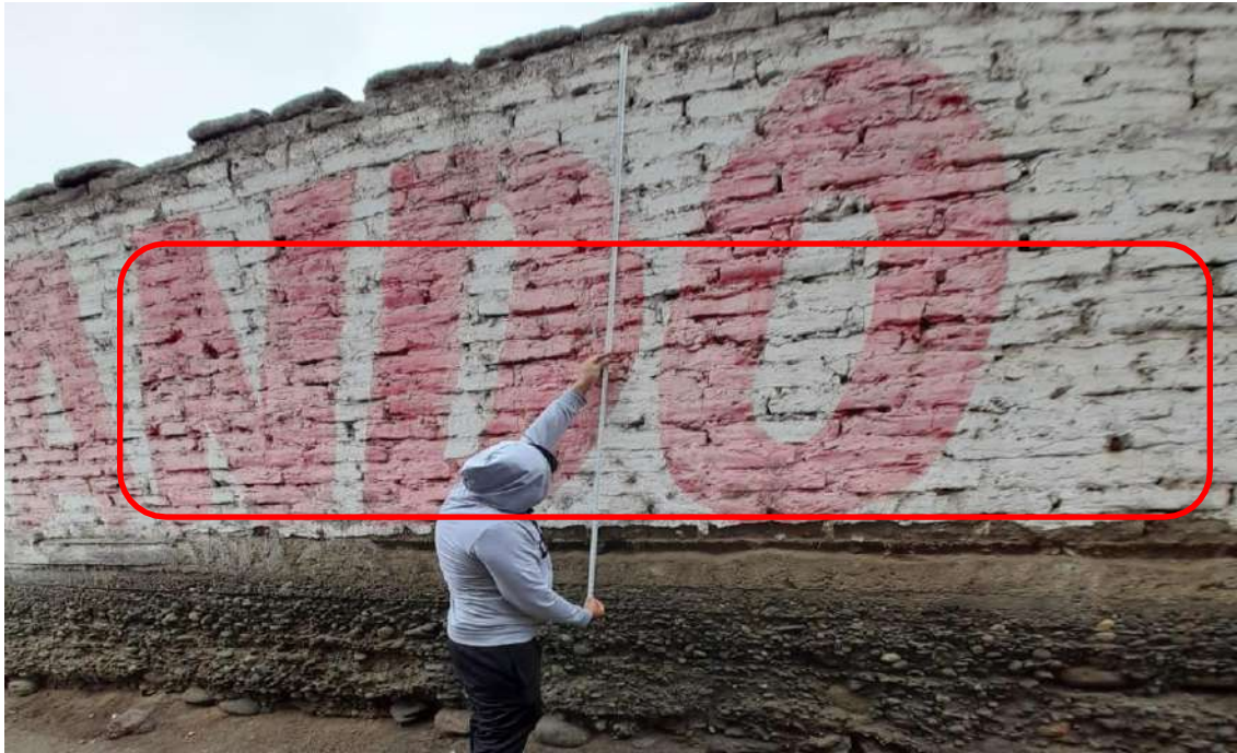
Figura 28. Falta de calidad de las unidades de mampostería requerida en la vivienda 07, en inicio de la calle Daniel Tapia.
