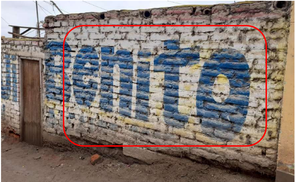
Figura 24. Falta de calidad de las unidades de mampostería requerida en la vivienda 06, la calle 16 de junio y los Laureles.
