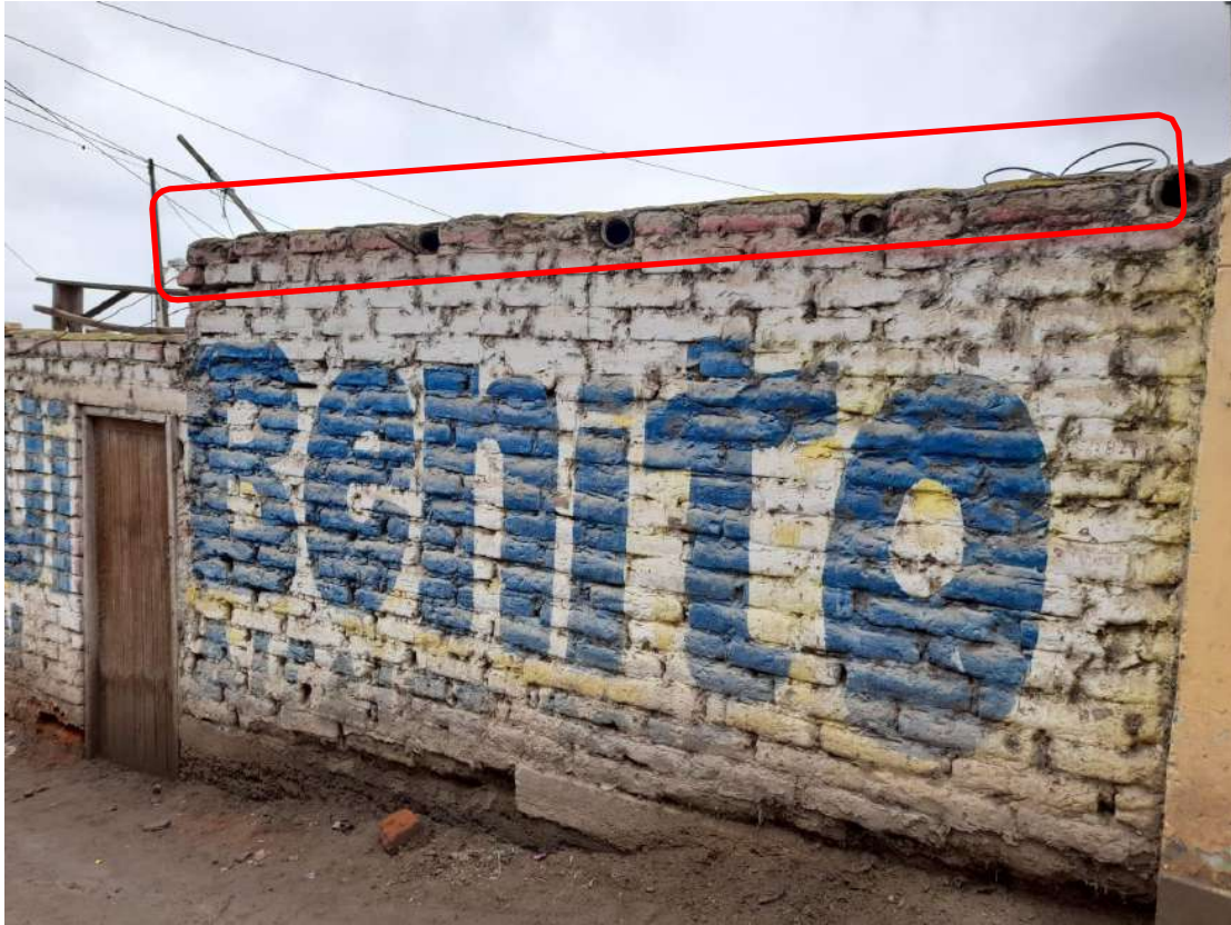
Figura 23. Ausencia de confinamiento con elementos estructurales en la vivienda 06, entre la calle 16 de junio y los Laureles.
