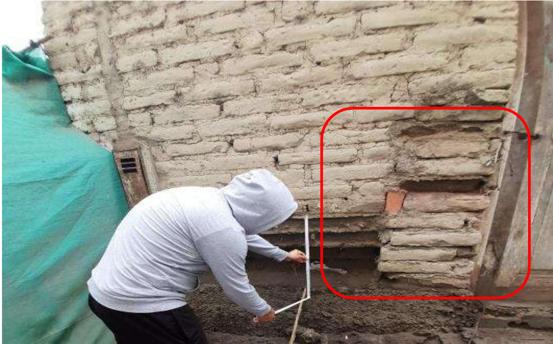
Figura 16. Falta de calidad de las unidades de mampostería requerida en la vivienda 04, finalizando la calle los Laureles.
