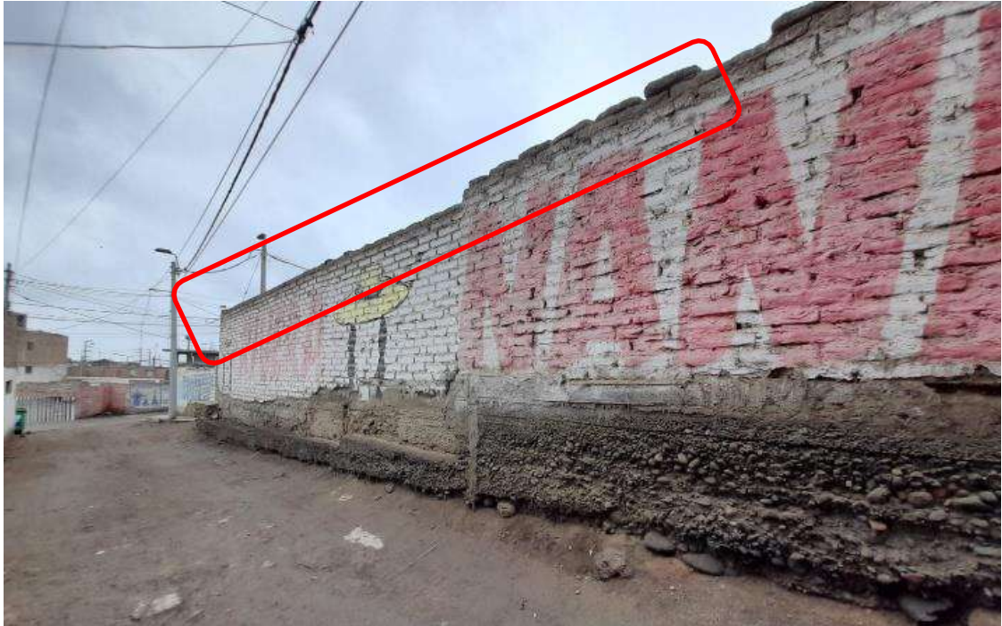
Figura 27. Ausencia de confinamiento con elementos estructurales en la vivienda 07, en inicio de la calle Daniel Tapia.
