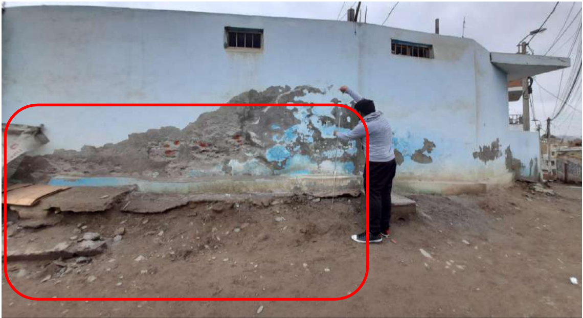
Figura 44. Falta de calidad de las unidades de mampostería requerida en la vivienda 11, en la mitad de la calle los Sauces.
