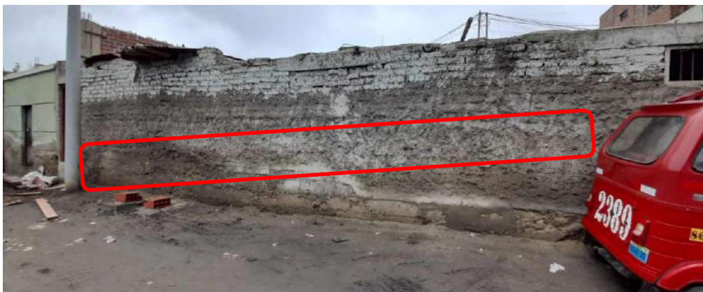
Figura 3. Ausencia de confinamiento con elementos estructurales en la vivienda 01, ubicado en la calle Los Sauces.
