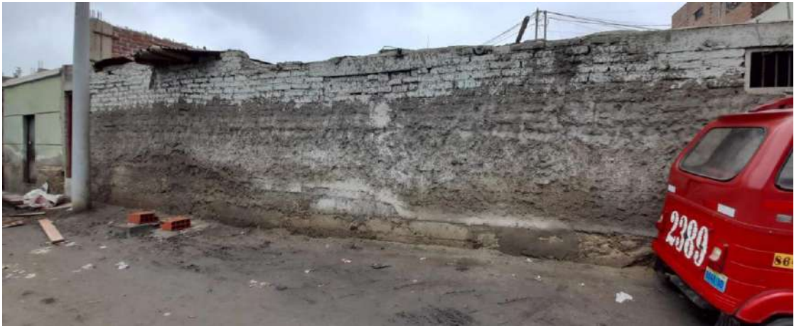
Figura 5. Inclinación del terreno y ausencia de vigas de cimentación en la vivienda 01, en la calle los Sauces.
