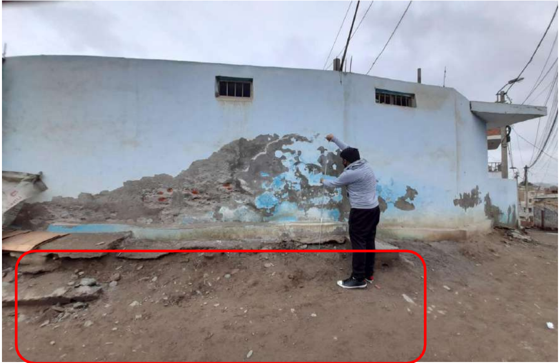
Figura 45. Inclínación del terreno y ausencia de vigas de cimentación en la vivienda 11, en la mitad de la calle los Sauces.
