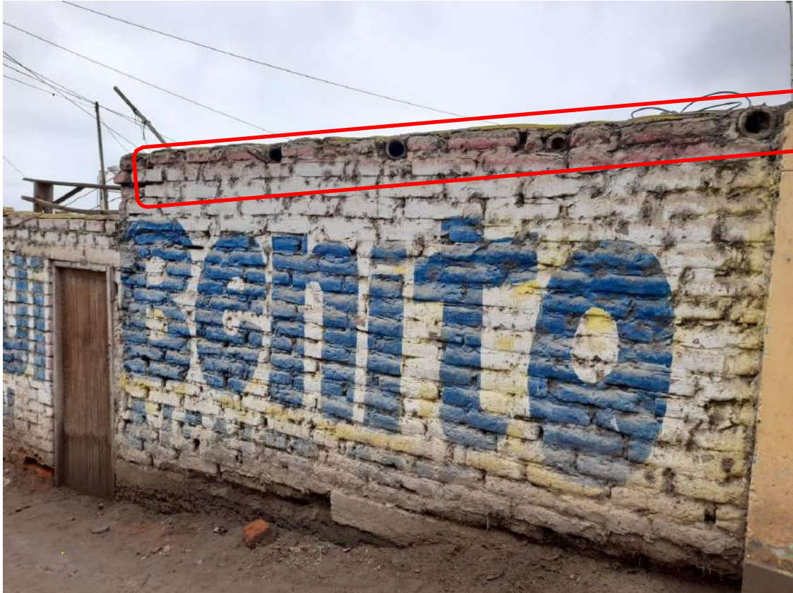
Figura 26. Ausencia de cobertura en la vivienda 06, la calle 16 de junio y los Laureles.
