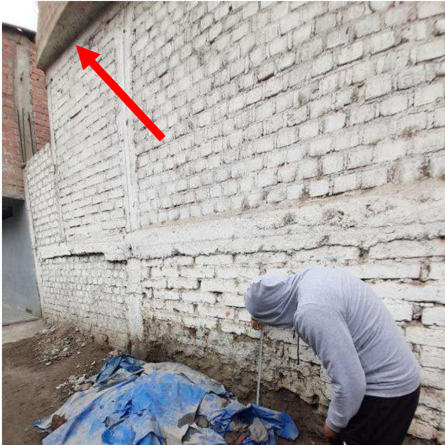
Figura 42. Presencia de losa rígida en la vivienda 10, en la intersección de Daniel Tapia con pasaje Gamarra.
