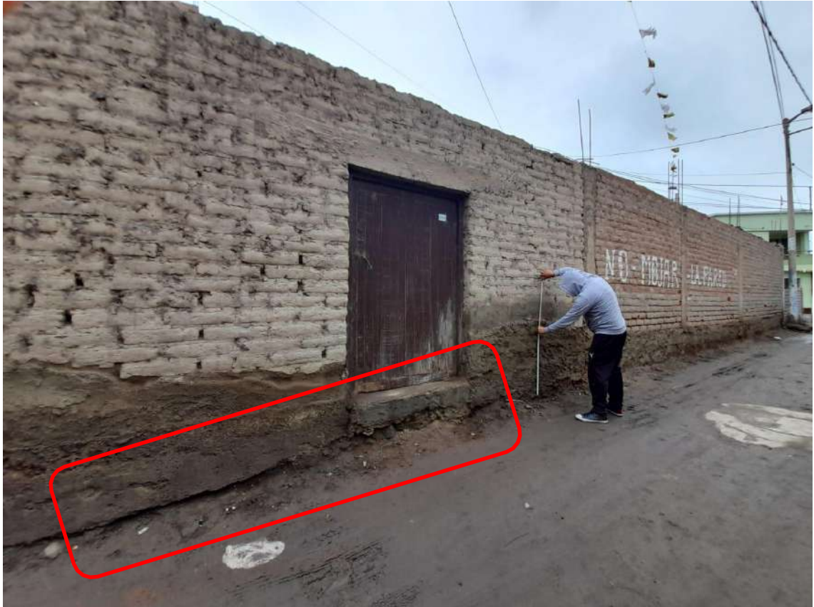
Figura 21. Inclinación del terreno y ausencia de vigas de cimentación en la vivienda 05, entre la calle Indalecio Paz y los Sauces.
