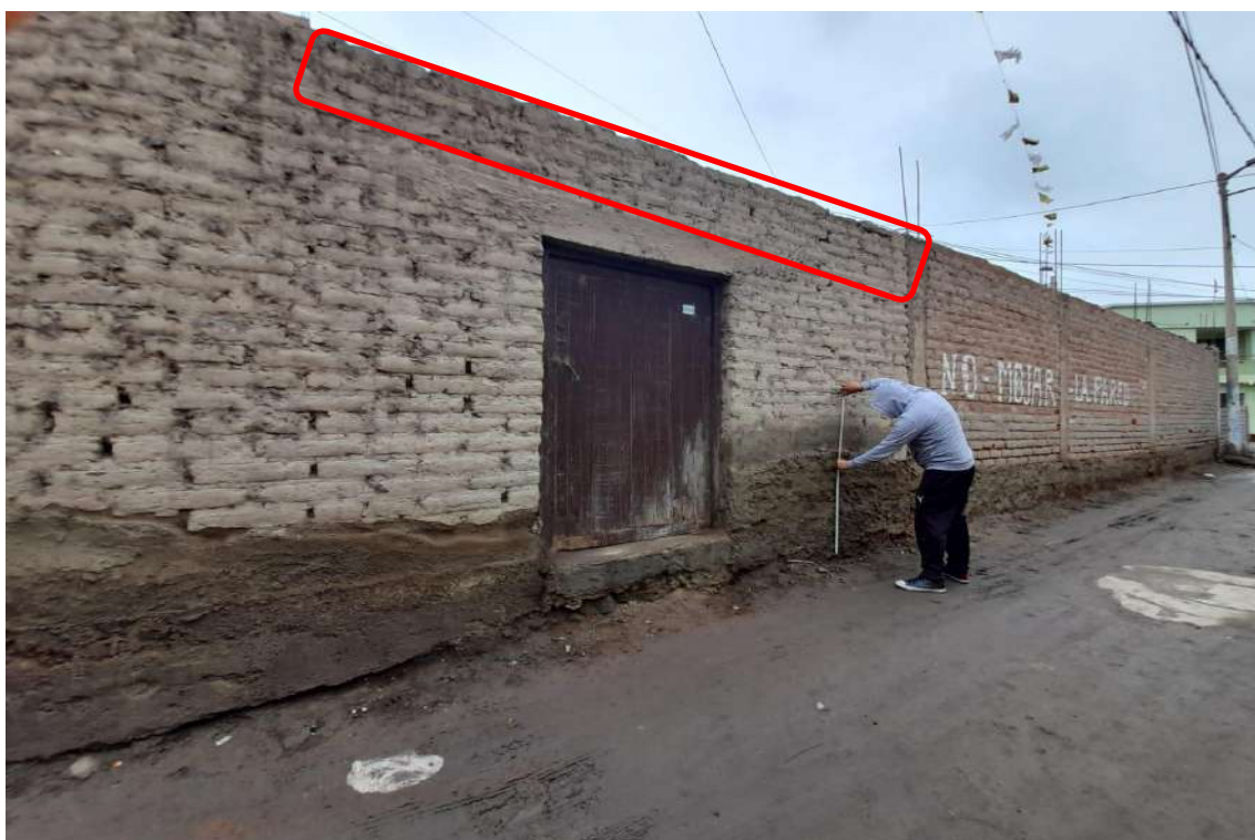
Figura 19. Ausencia de confinamiento con elementos estructurales en la vivienda 05, entre la calle Indalecio Paz y los Sauces.
