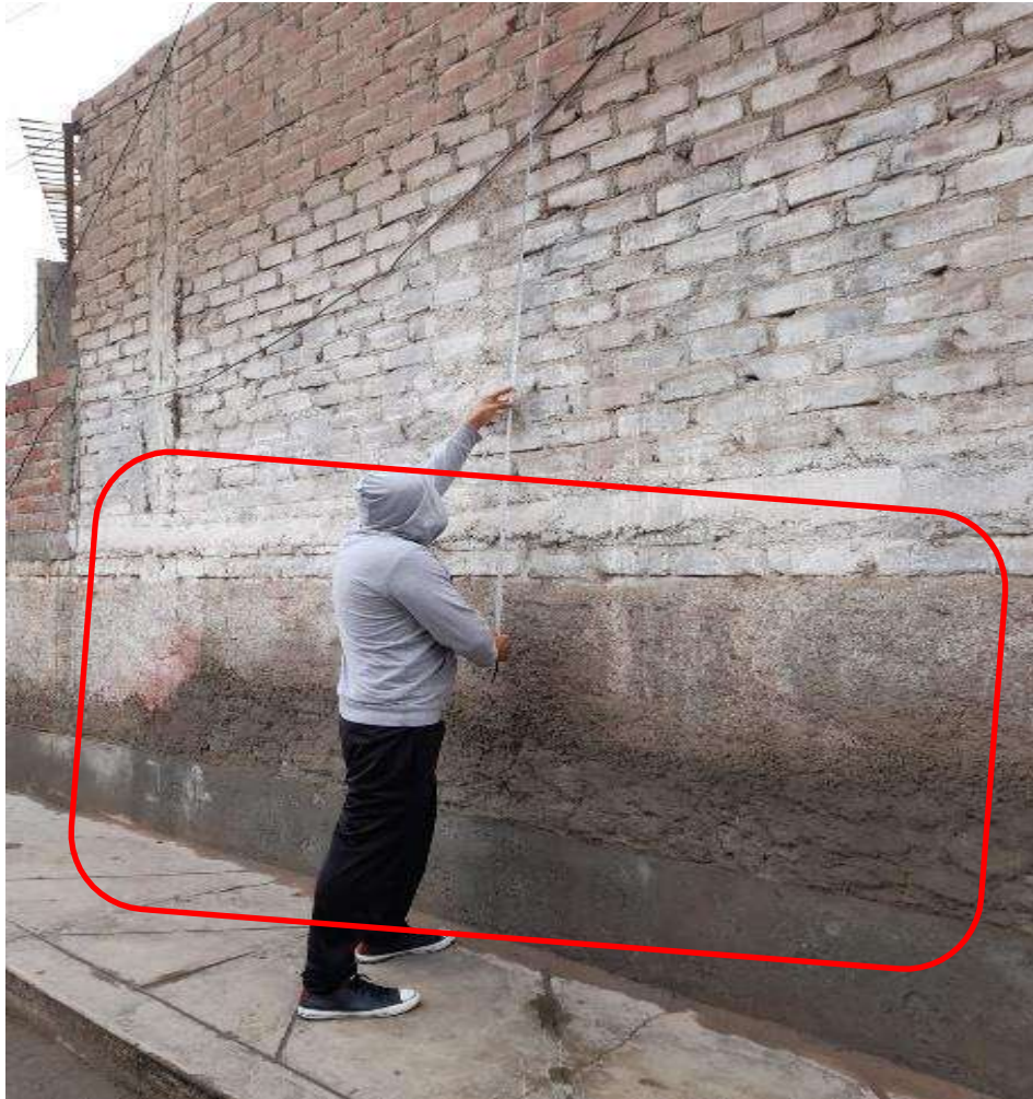
Figura 37. Inclínación del terreno y ausencia de vigas de cimentación en la vivienda 09, zona media de calle los Laureles.
