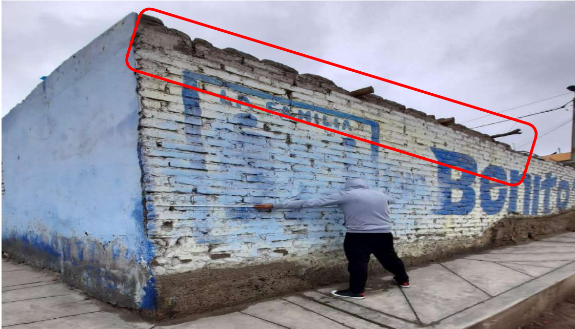
Figura 10. Ausencia de cobertura en la vivienda 02, en la calle los laureles.
