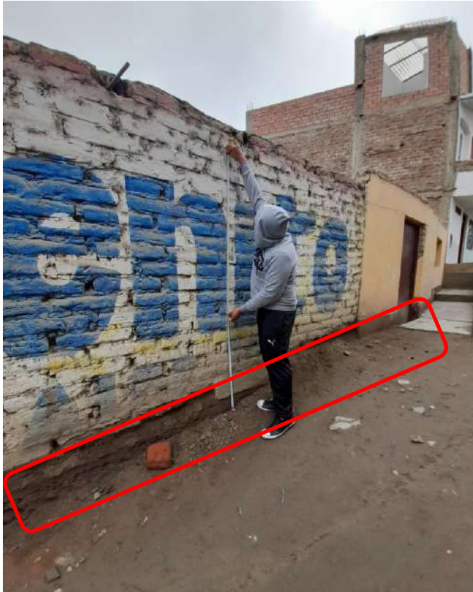
Figura 25. Inclínación del terreno y ausencia de vigas de cimentación en la vivienda 06, la calle 16 de junio y los Laureles.
