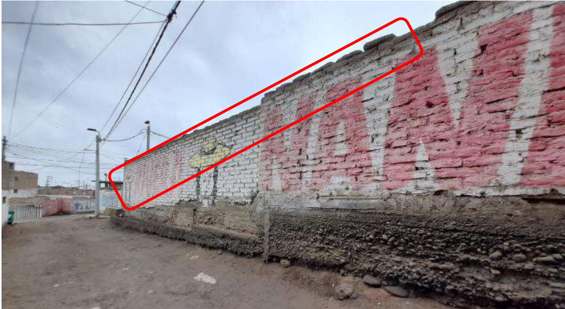
Figura 30. Ausencia de cobertura en la vivienda 07, en inicio de la calle Daniel Tapia.
