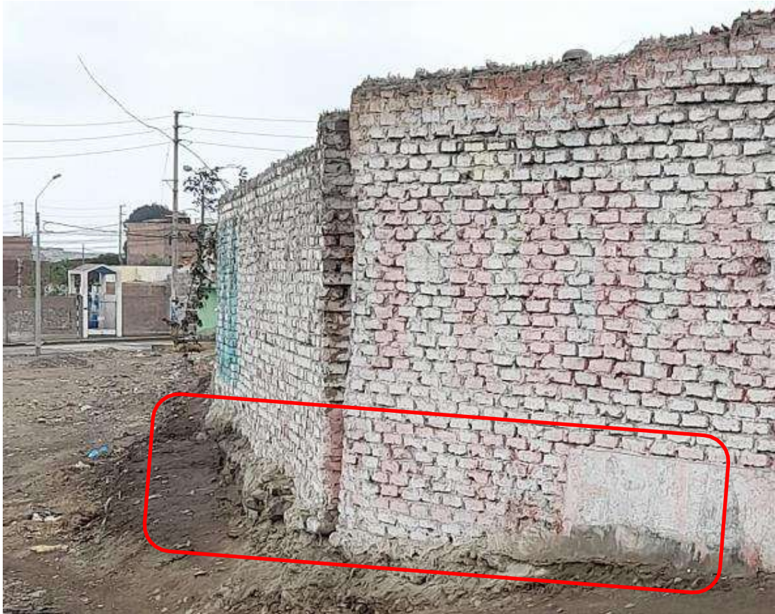
Figura 33. Inclínación del terreno y ausencia de vigas de cimentación en la vivienda 08, en calle 16 de junio colindante al descampado.
