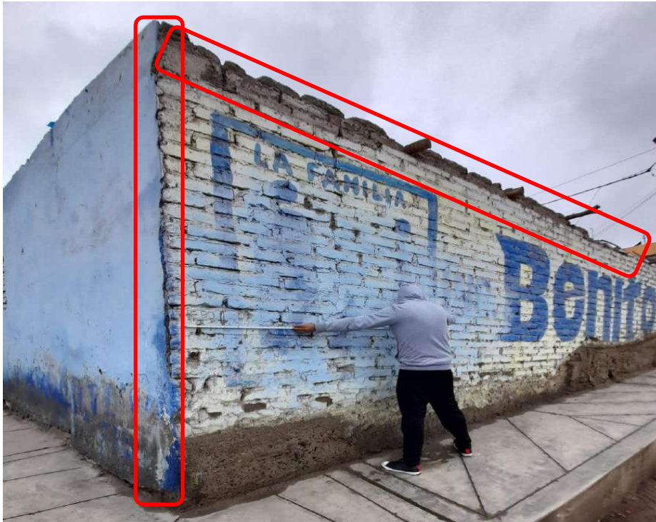
Figura 07. Ausencia de confinamiento con elementos estructurales en la vivienda 02, en la calle los Laureles.
