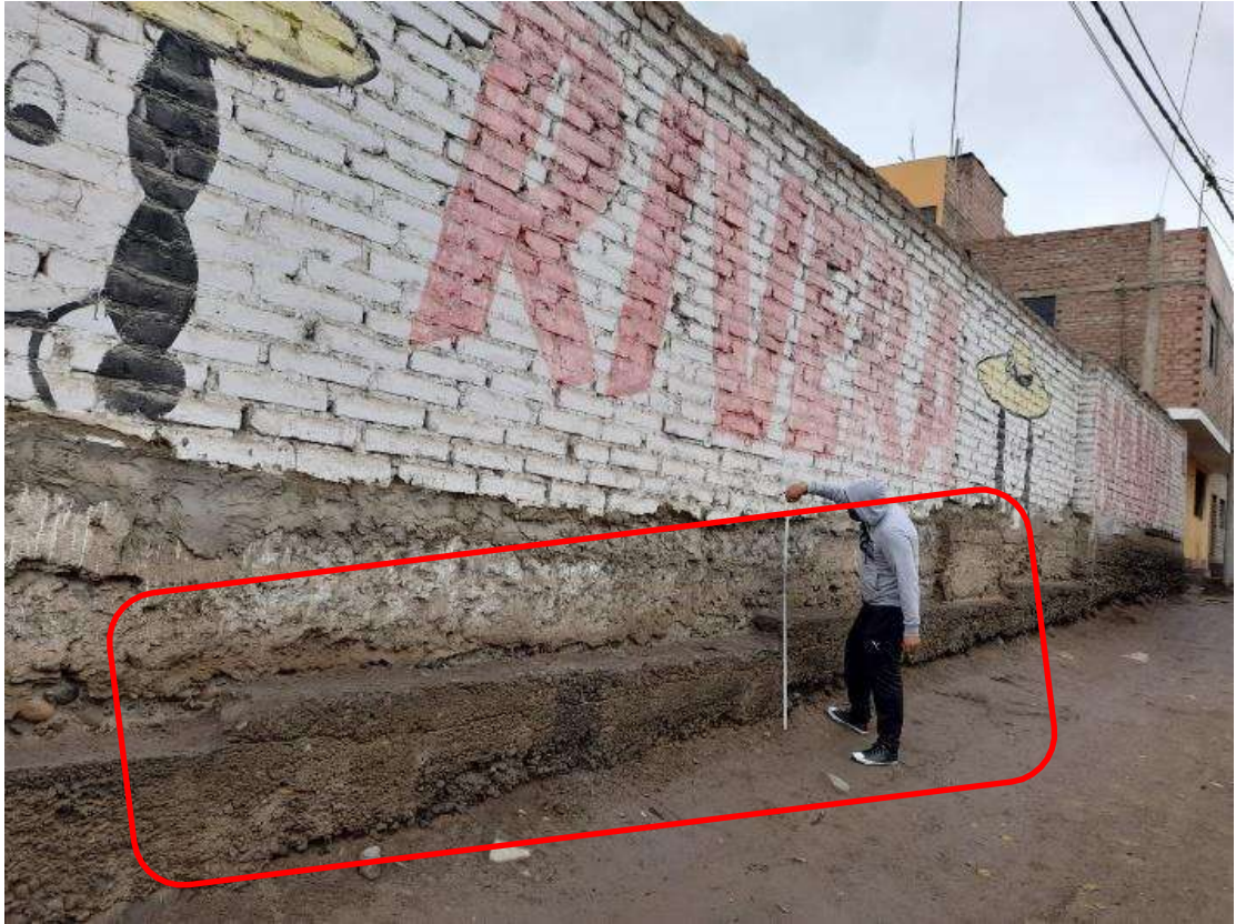
Figura 29. Inclineración del terreno y ausencia de vigas de cimentación en la vivienda 07, en inicio de la calle Daniel Tapia.
