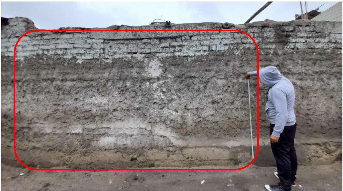
Figura 4. Falta de calidad de las unidades de mampostería requerida en la vivienda 01, en la calle los Sauces.
