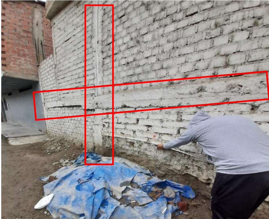
Figura 39. Presencia de confinamiento por elementos estructurales en la vivienda 10, en la intersección de Daniel Tapia con pasaje Gamarra.
