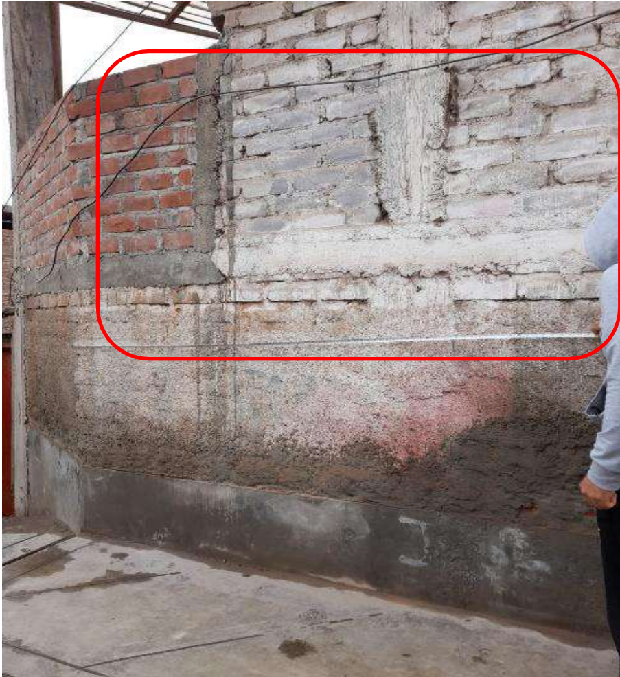
Figura 36. Falta de calidad de las unidades de mampostería requerida en la vivienda 09, zona media de calle los Laureles.
