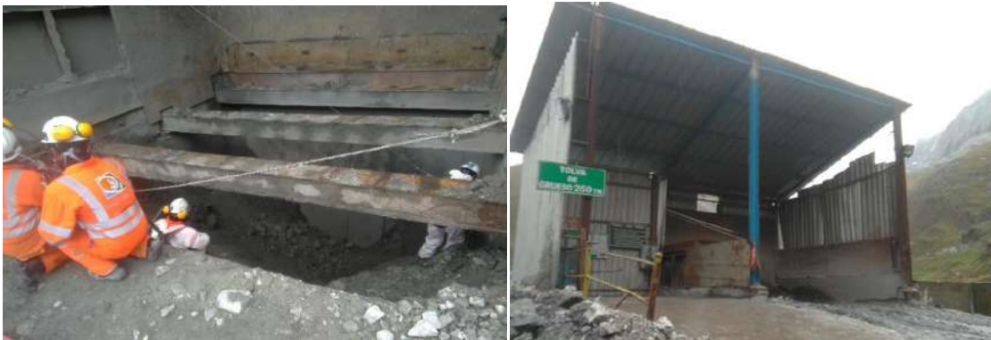
Figura 04. Parrilla de tolva de grueso que tiene una capacidad 250 ton.
