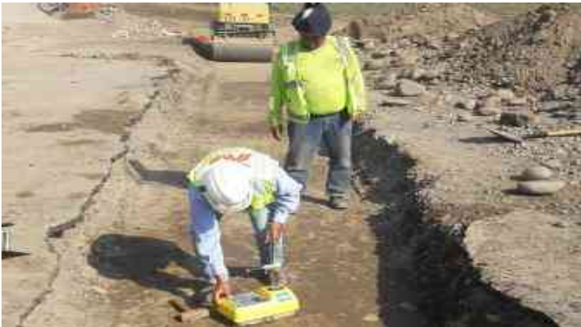
Figura 46. Prueba de calidad de tierra, por el compactado para tener un terreno firme y no seda.
