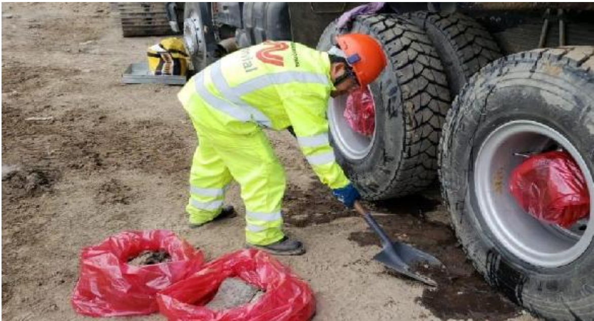
Figura 42. Protegiendo el medio ambiente, retirando el derrame de aceite del suelo desnudo, con todas las medidas de seguridad y en bolsas rojas para colocarlo en residuos peligrosos.
