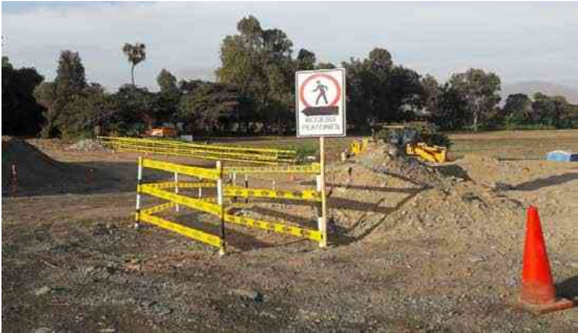
Figura 41. Señalización de paso peatonal para los pobladores.
