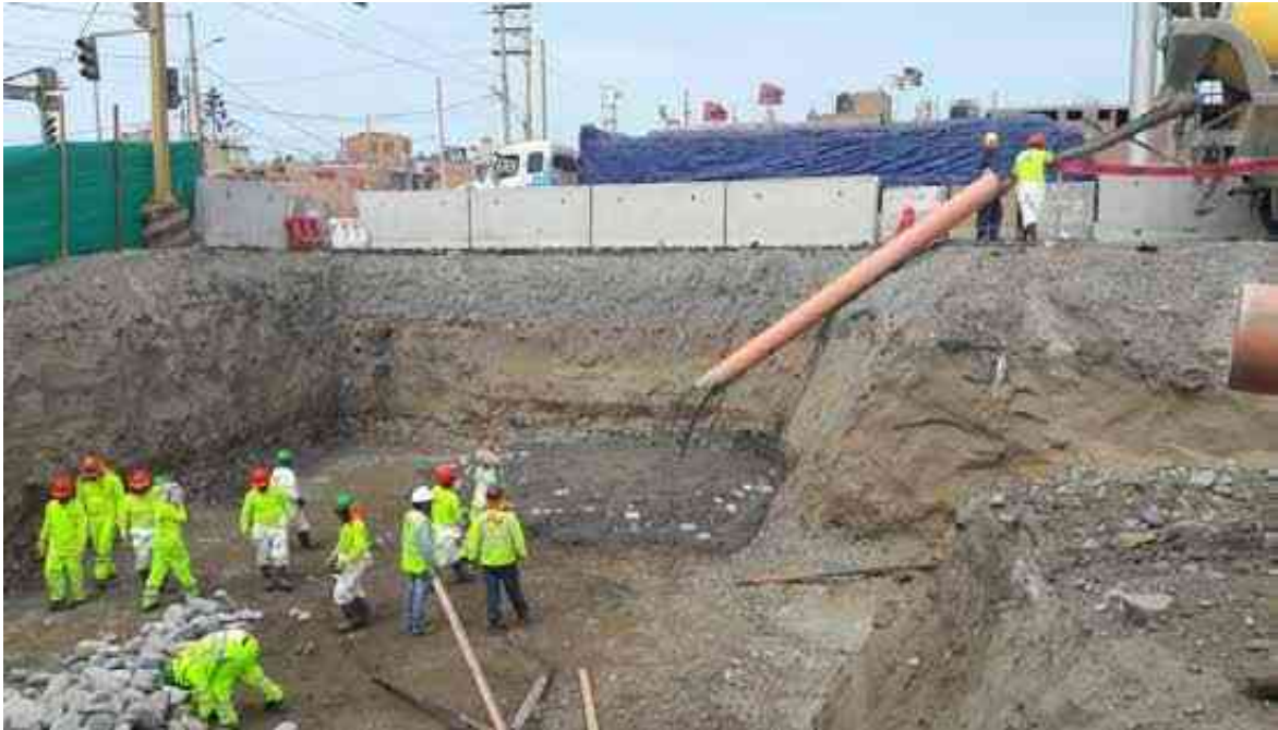
Figura 37. Vaciado de concreto con todas las medidas de seguridad y colocando New years de concreto para evitar que las personas se acerquen.
