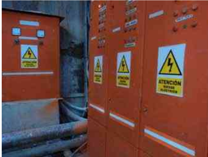
Foto N° 1: Señalización de tableros eléctricos
