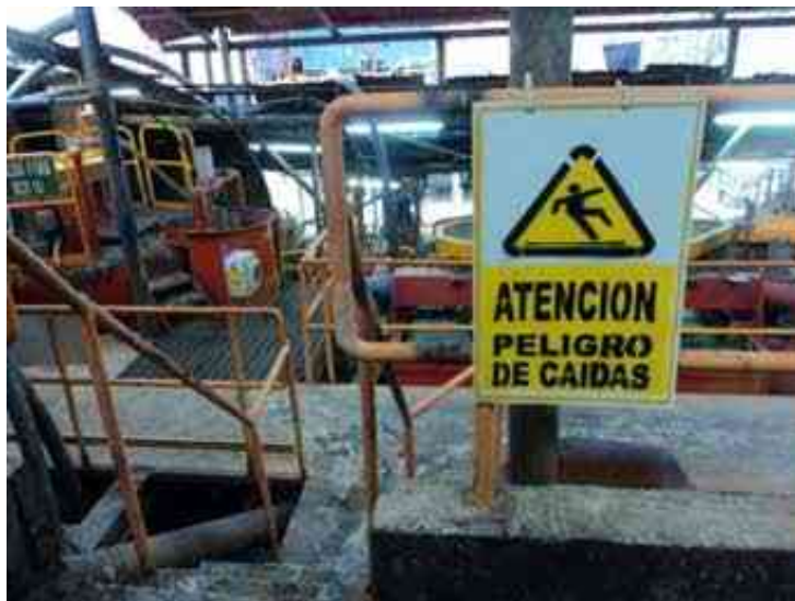
Foto N° 2: Señal de advertencia al costado de la celda Serrano
