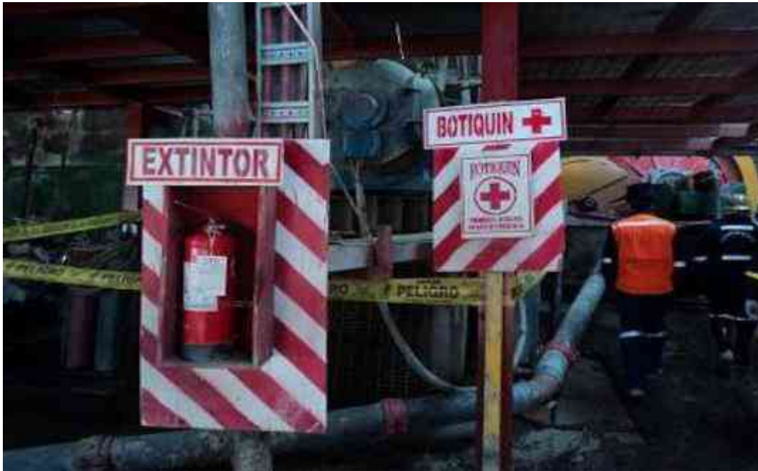
Foto N° 1: Vista del extintor ubicado al costado de celda serrano WS 8x8 n° 3
