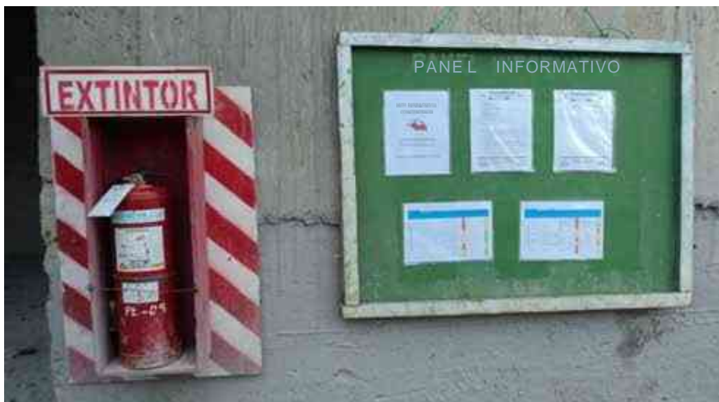
Foto N° 2: Vista del extintor ubicado en el despacho de concentrados
