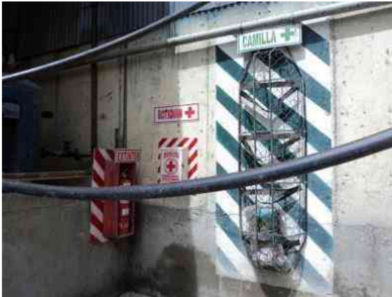
Foto N° 1: Vista de la camilla, botiquín de primeros auxilios y extintor de P.Q.S. ubicado frente a la zona de filtro de prensa.
