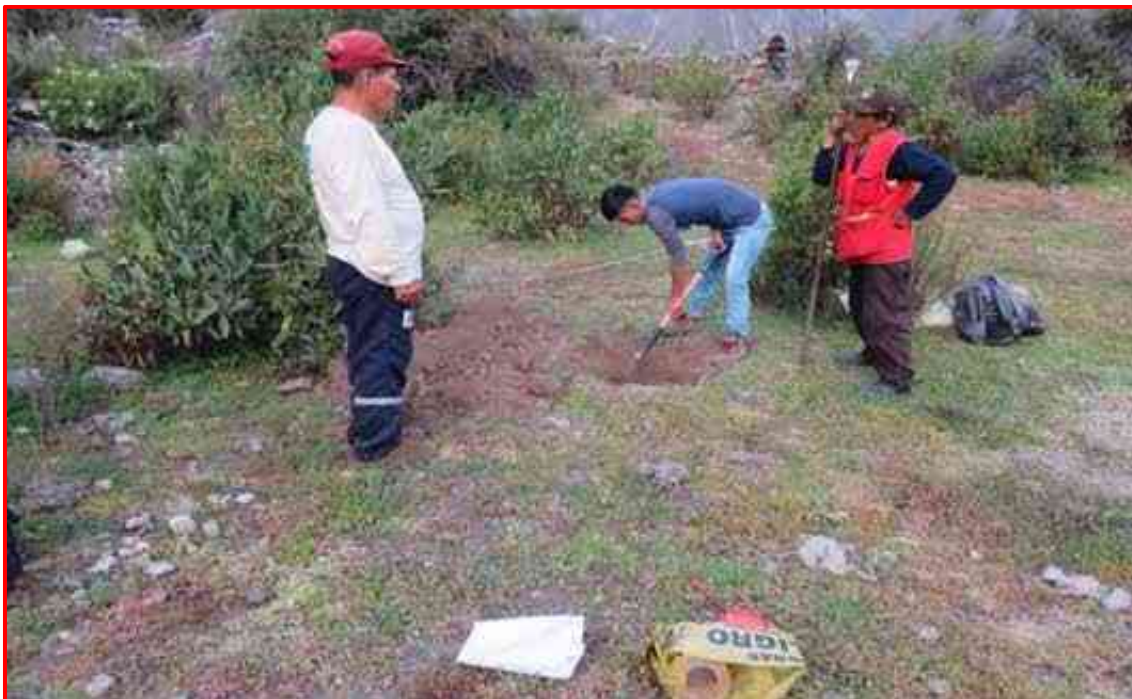
Personal técnico excavando la Calicata, Para Toma de Muestra con Fines de análisis de Mecánica de Suelos.
