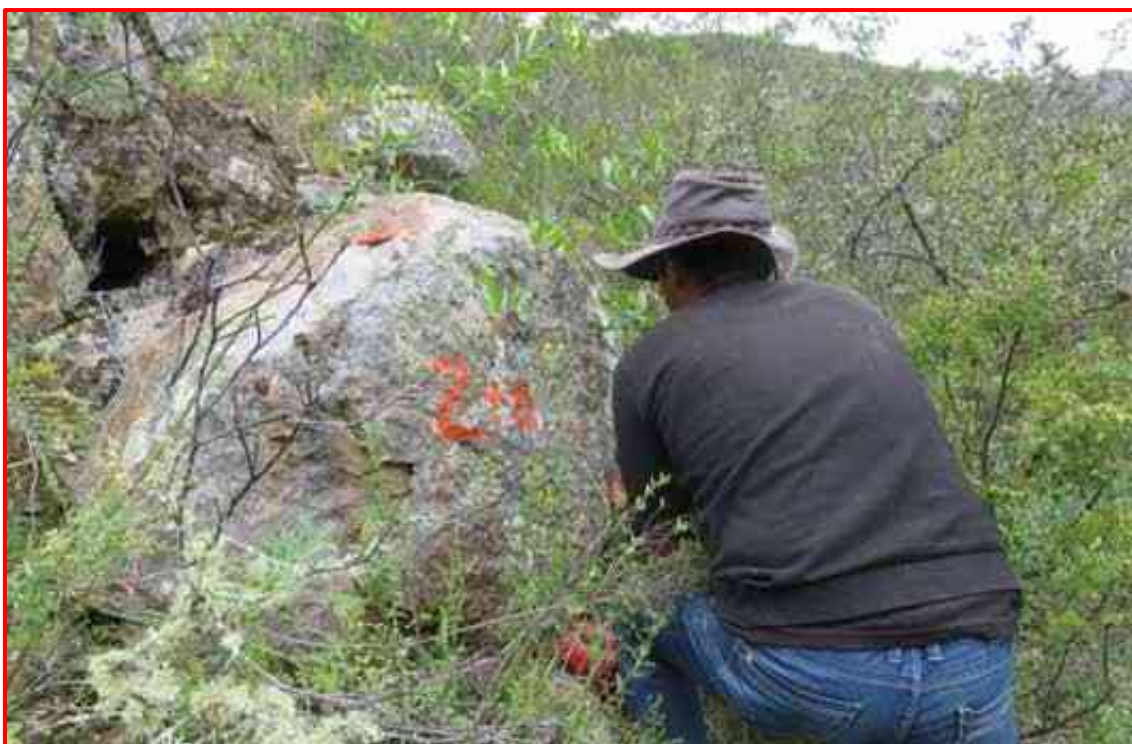
Se observa al personal pintando la progresiva de la Trocha Carrozable, Progresiva KM 2+000
