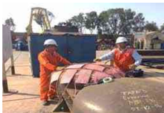
Figura 8. Calentamiento por resistencia eléctrica.
