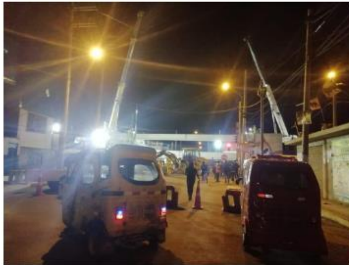
Fotografía 6: Construcción de Puente en el Cruce de la Panamericana Norte con Av. Centenario
