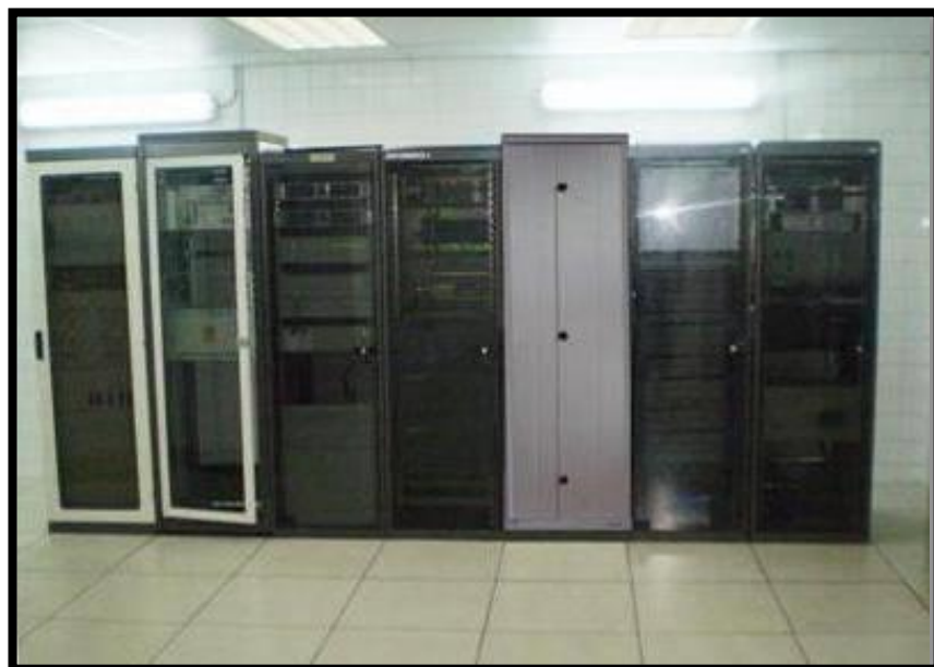
Figura 38: Cuarto de Telecomunicaciones (Armarios)
