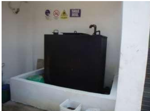
Figura N° 13 Área de almacenamiento de combustible
