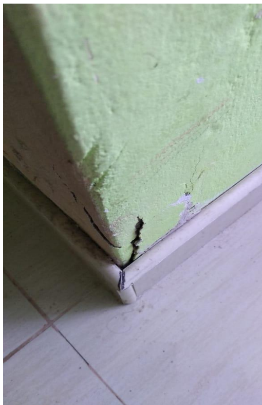
Figura 17: Identificación de grietas en la columna Calle Atahualpa
