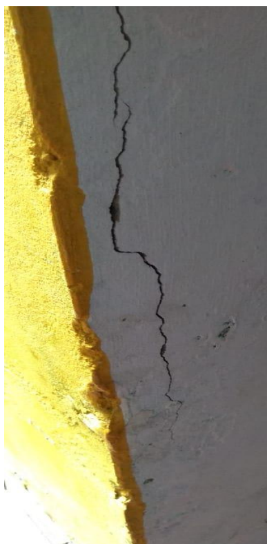
Figura 18: Identificación de grietas en columna en la Calle Santa Elena
