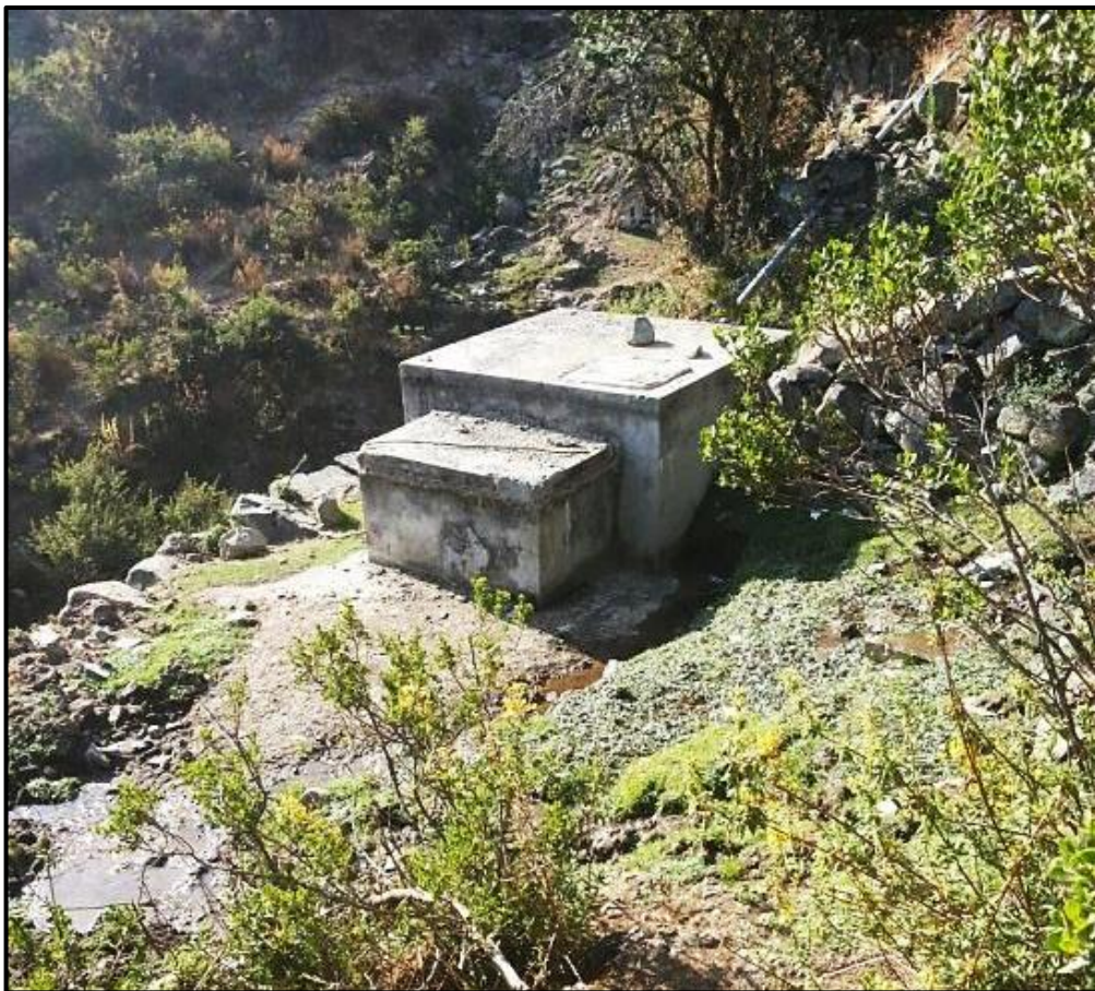
Figura 6. Vista frontal del punto C1 (Captación de agua).
