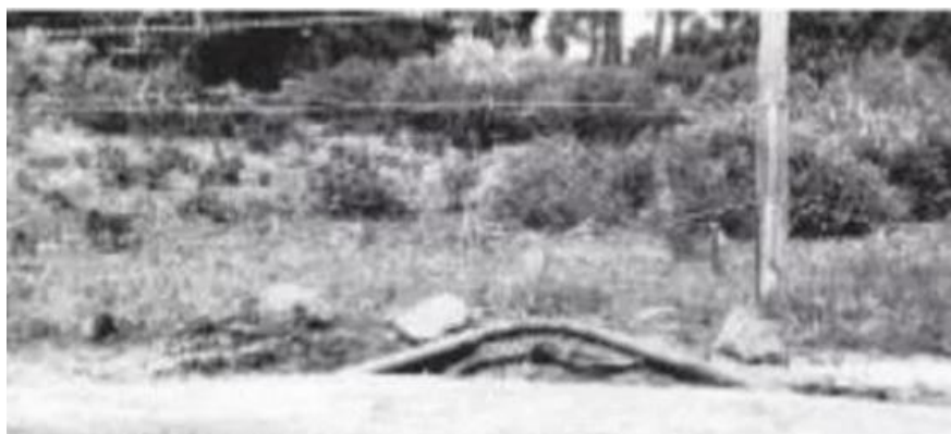
Foto 3: Pandeo Columna de tubería de acero del sistema de agua.
