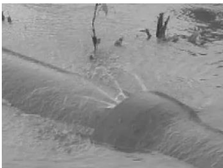
Foto 6: Falla junta espiga campana debido a flexión, sismo Sumatra 2004
