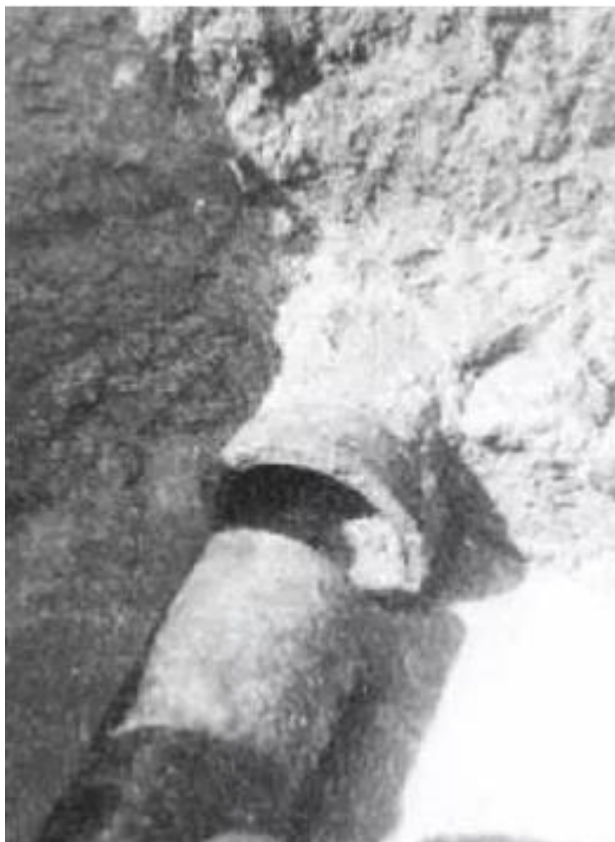
Foto 4: Separación en tubería sistema de abastecimiento de agua
