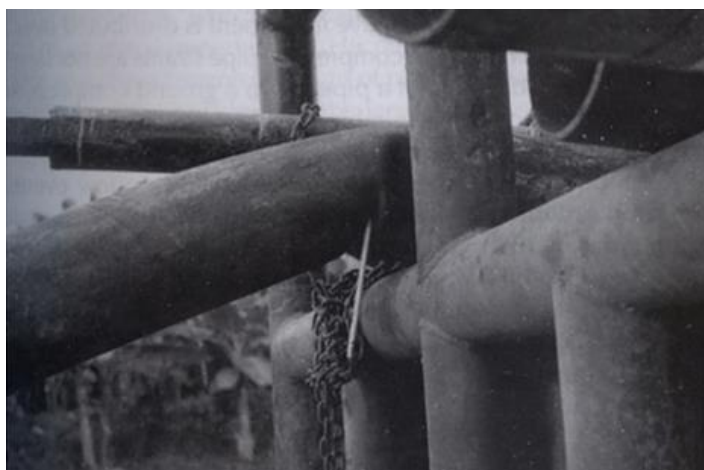
Foto 2: Falla de pandeo local en sismo de Costa Rica
