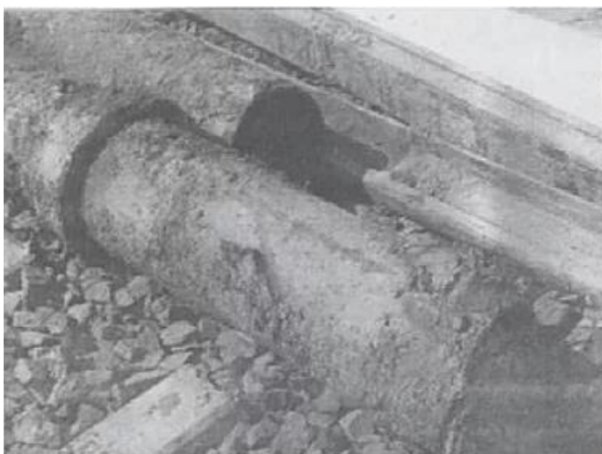
Foto 5: Aplastamiento junta espiga campana, sismo Bhuj 2001
