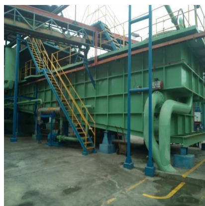
Figura 10: Trampa de grasa de agua de bombeo
