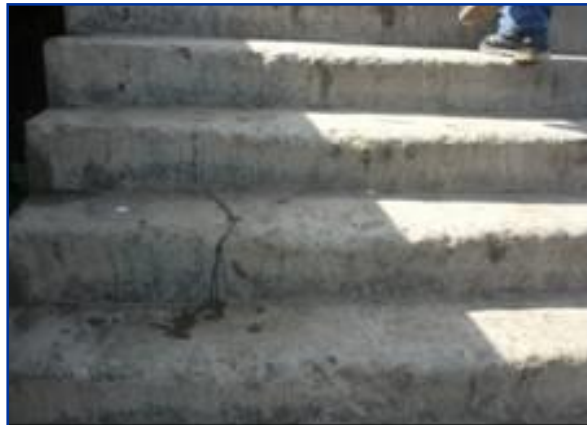
El mal estado de las escaleras.
