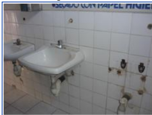
Servicios higiénicos en mal estado
