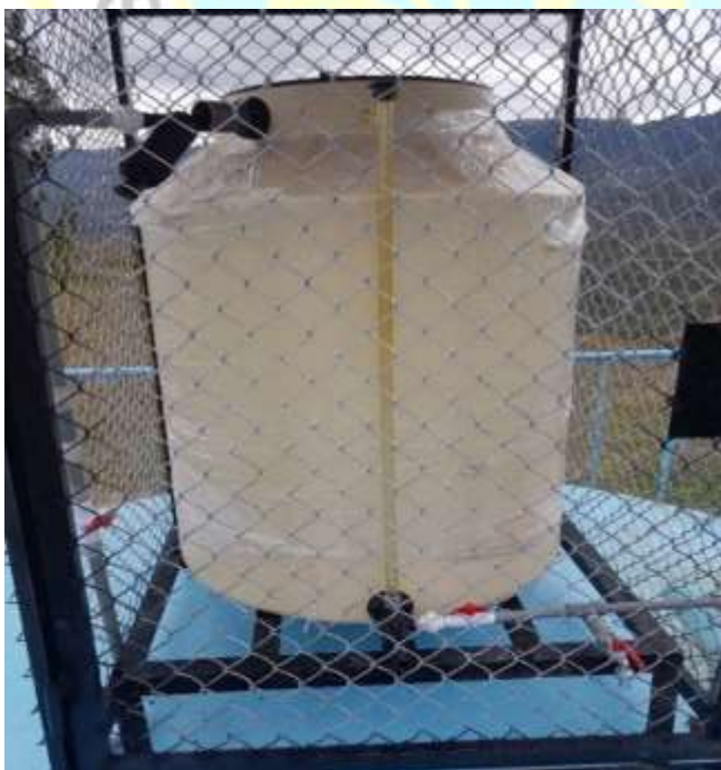
Figura 12. Sistema de cloración.
