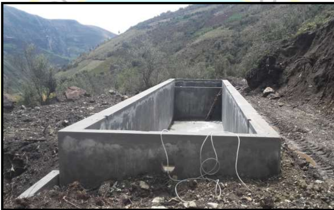
Figura 9. Vista general de sedimentador.
