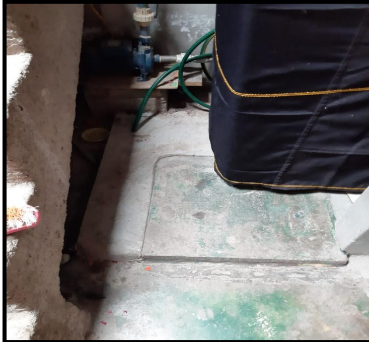
CISTERNA DE AGUA
