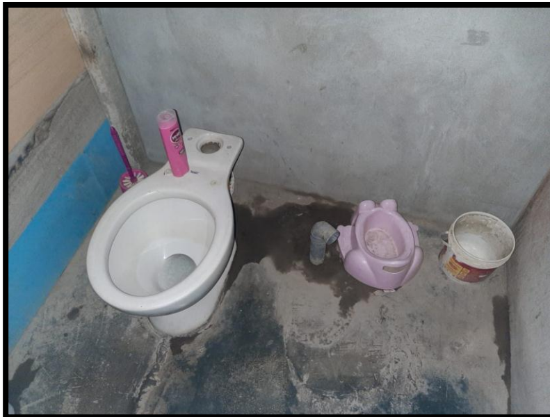
BAÑO SIN TANQUE DE AGUA
