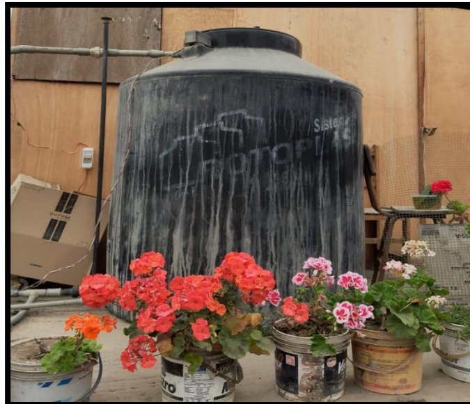
TANQUE DE AGUA UBICADO SOBRE EL SEGUNDO PISO
