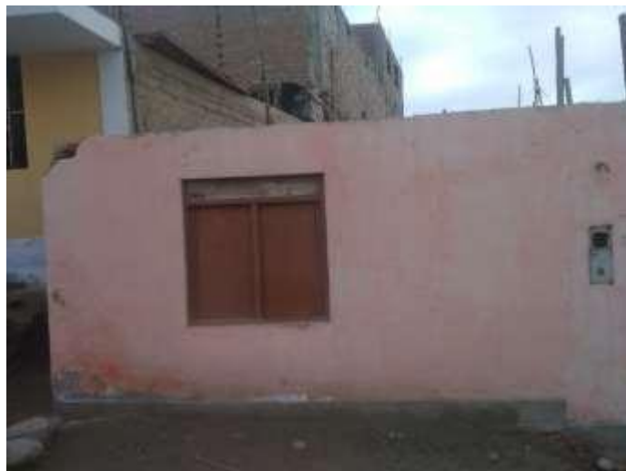
Figura N°12: Estado de las estructura de la vivienda en manzanares
