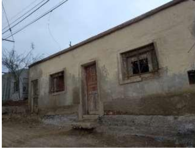
Figura N°14: Vivienda afectada por humedad
