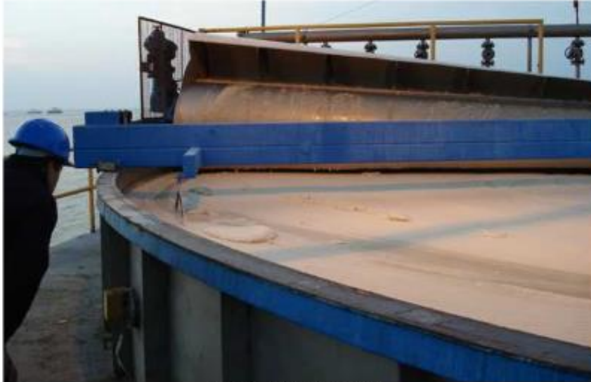
Tanque de flotación química
