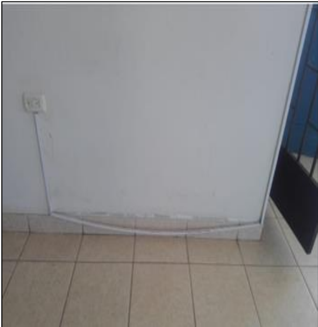
En la FIISI-II, canaleta del sistema de cableado colgado.
