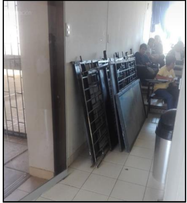
En el salón de la FIISI-II, puertas almacenadas en lugar inadecuado, obstruyendo el ingreso.
