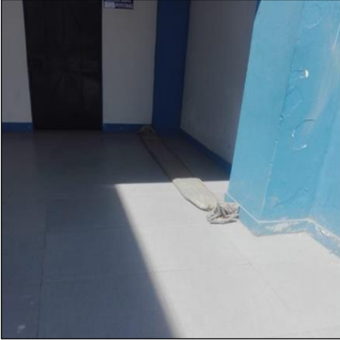
En el patio de la FIISI-I, objetos ubicado en lugar inadecuado.
