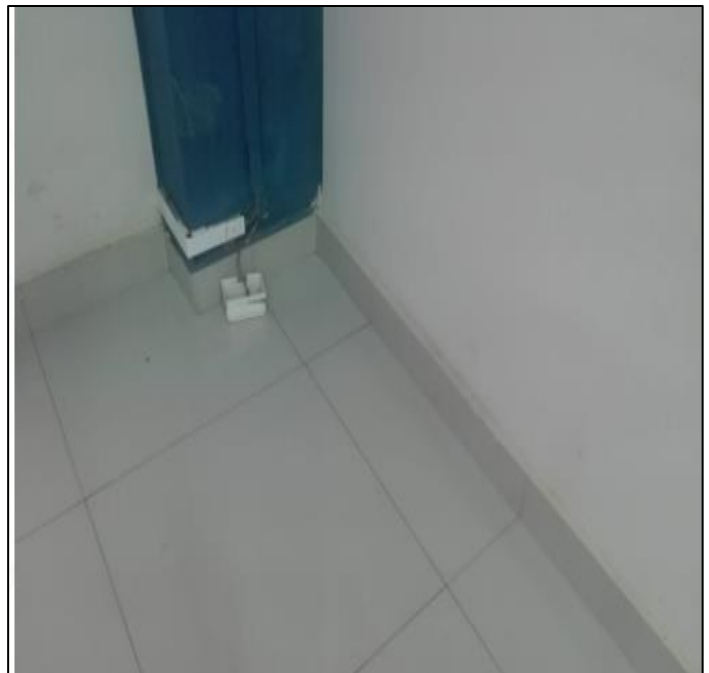
En la oficina de la FIISI-I, se evidencia caja de tomacorriente colgado.
