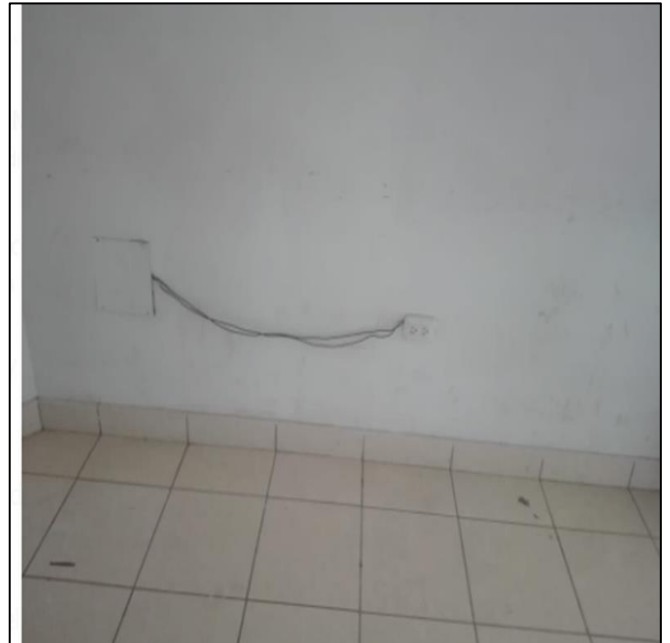
En la FIISI-II, sistema de cableado colgado, sin porta cable.
