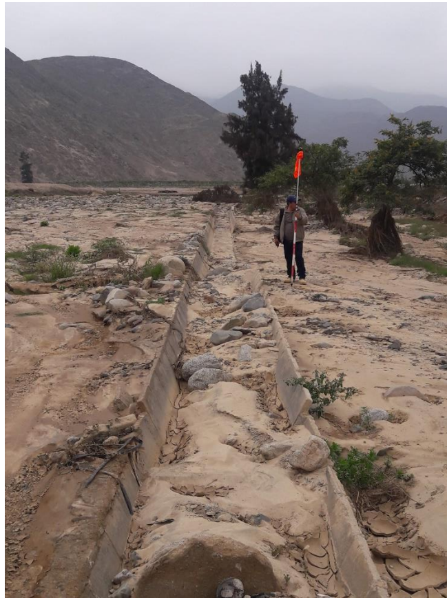
Figura N° 10: Una parte del tramo del Canal afectado por el huayco
