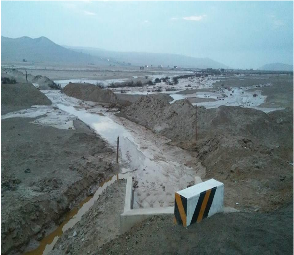
Figura N° 2: Alcantarilla en el desvío a Huaral obstruida por desborde del canal de regadío.
