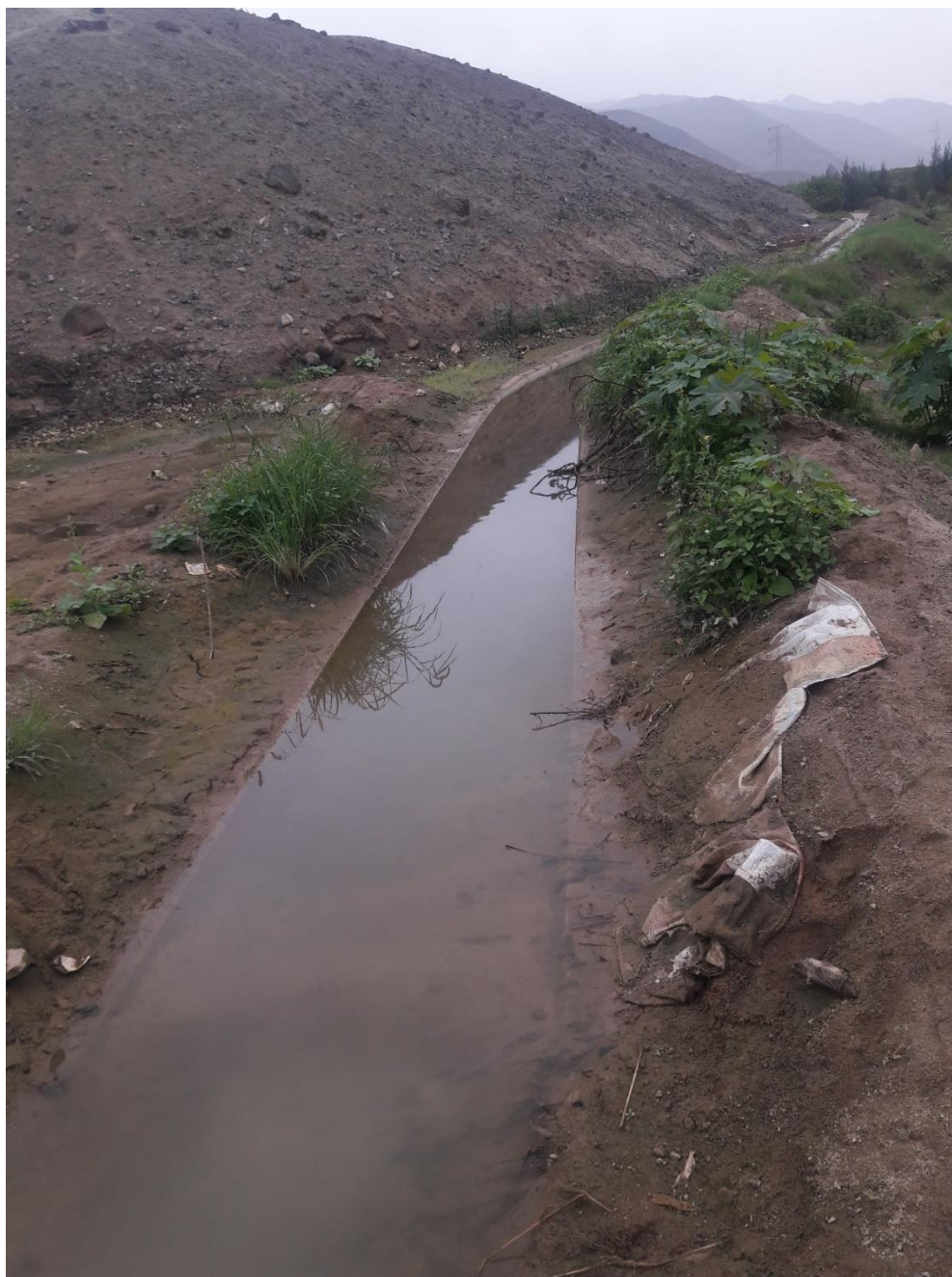
Figura N° 5: Fallas de Canal existente.
