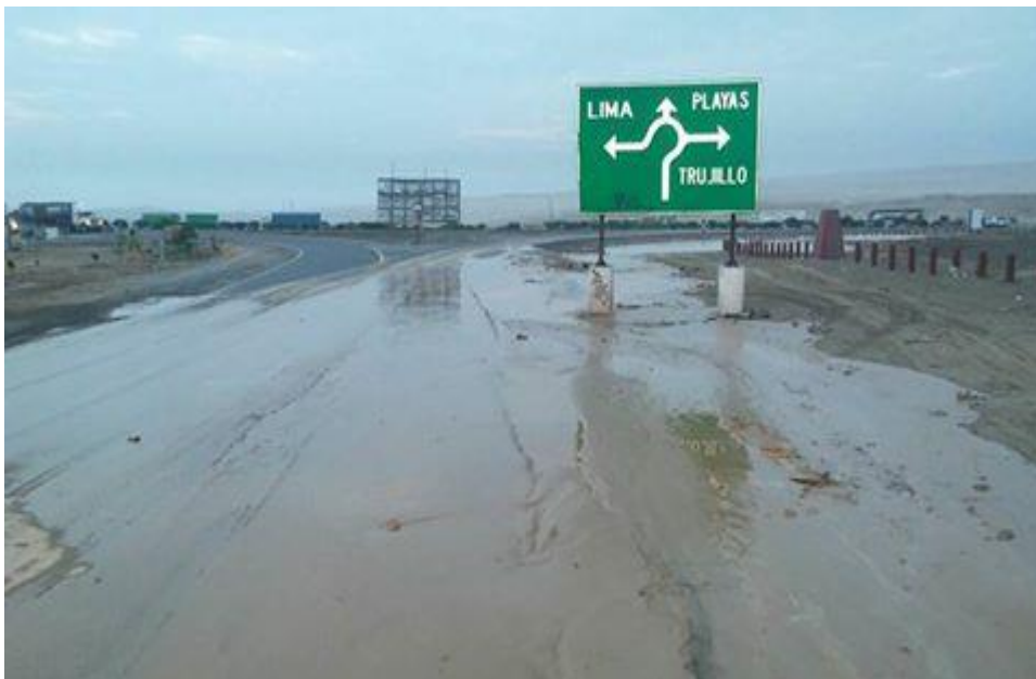
Figura N° 1: Desborde de canal de regadío amenazó con interrumpir Carretera Panamericana
