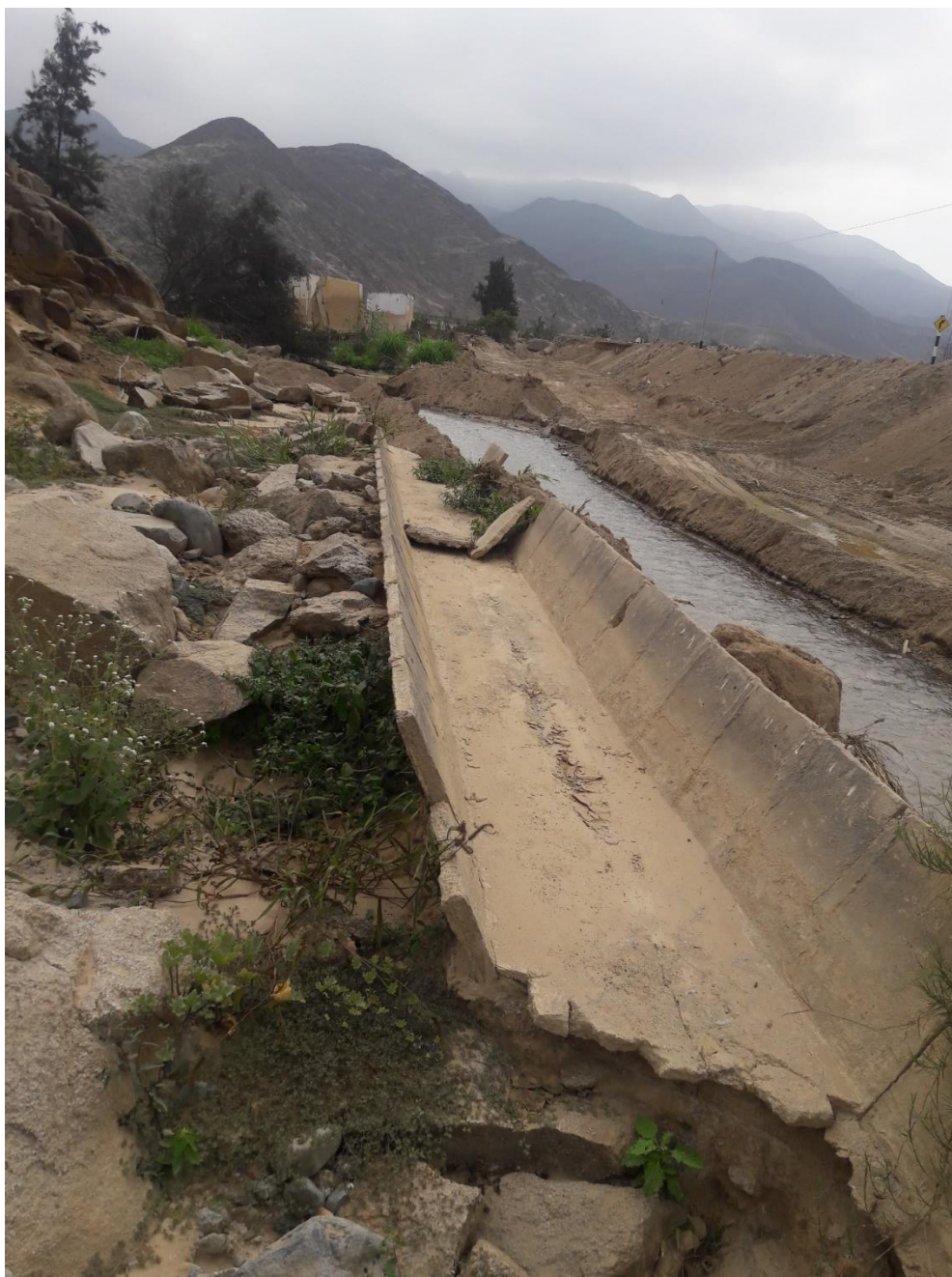
Figura N° 12: Consecuencias del huayco sobre el canal.
