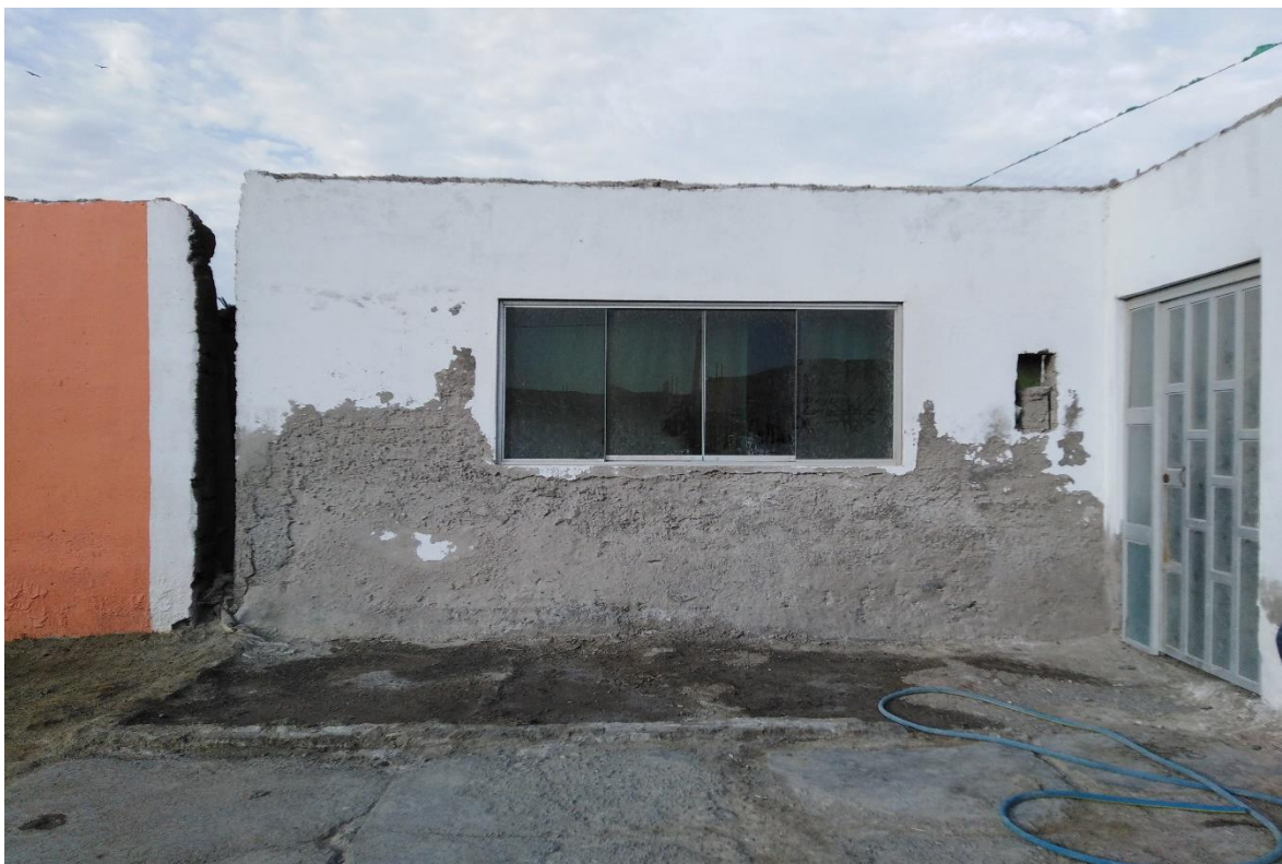
Fotografía de patología de desintegración
