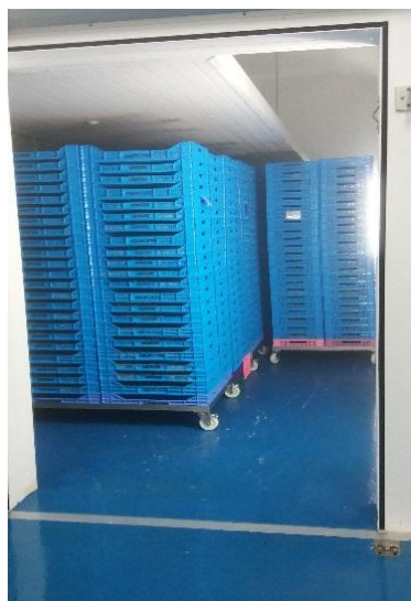
Figura 8: Túnel de congelado
