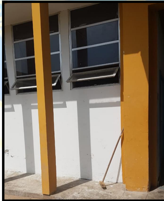
Figura N° 33: Columna corta en muros perimetrales externos
