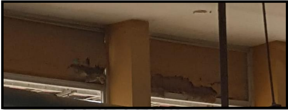
Figura N° 55: Fisura por flexión - viga en el cuarto nivel
