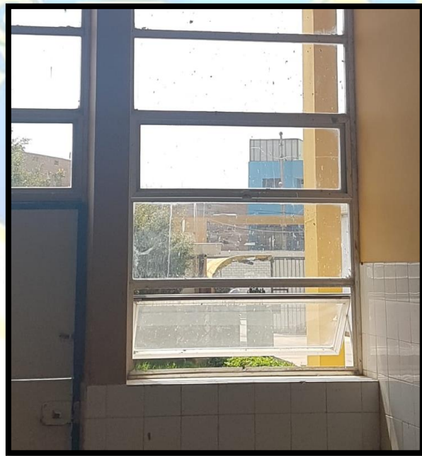
Figura N° 31: Columna corta en muros perimetrales internos
