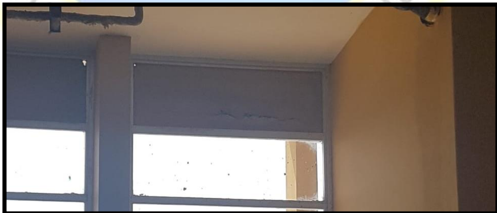
Figura N° 54: Fisura por flexión - viga en el segundo nivel
