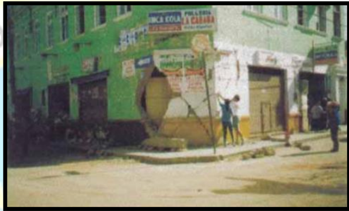
Figura N° 11: Daño en esquina débil de una edificación
