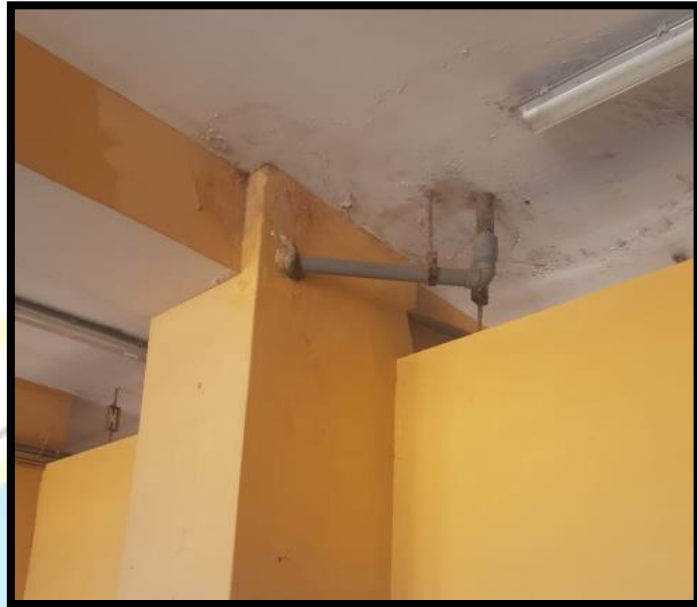
Figura N° 32: Columna corta en muros internos
