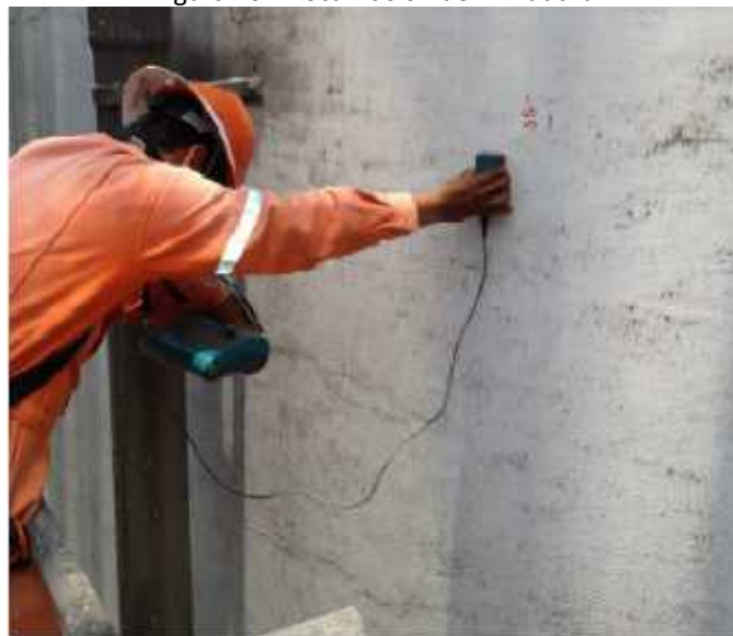
Figura 11 – Localización de Armadura
