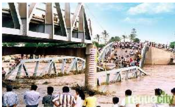
Figura 1 – Colapso del Puente Reque, Junio 1998
