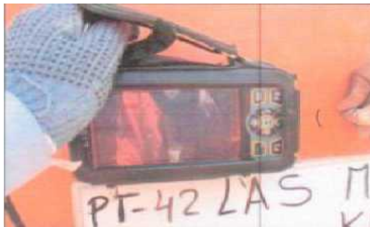
Figura 17 - Equipo para medir espesor de planchas de acero estructural.
