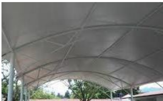
Figura 15. Toldo de lona y estructura metálica implementado sobre tanques de almacenamiento y líneas de alimentación en el grifo PECSA
