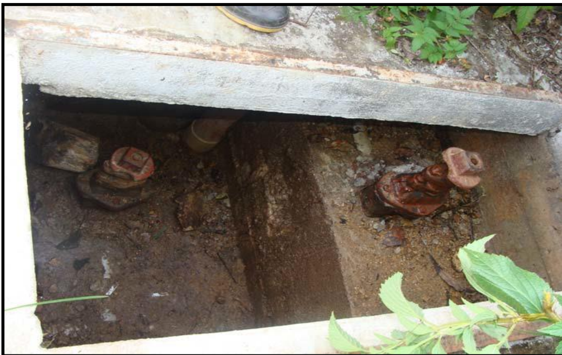
Figura 11. Vista de la cámara de válvulas, se puede apreciar la falta de mantenimiento a estos accesorios.
