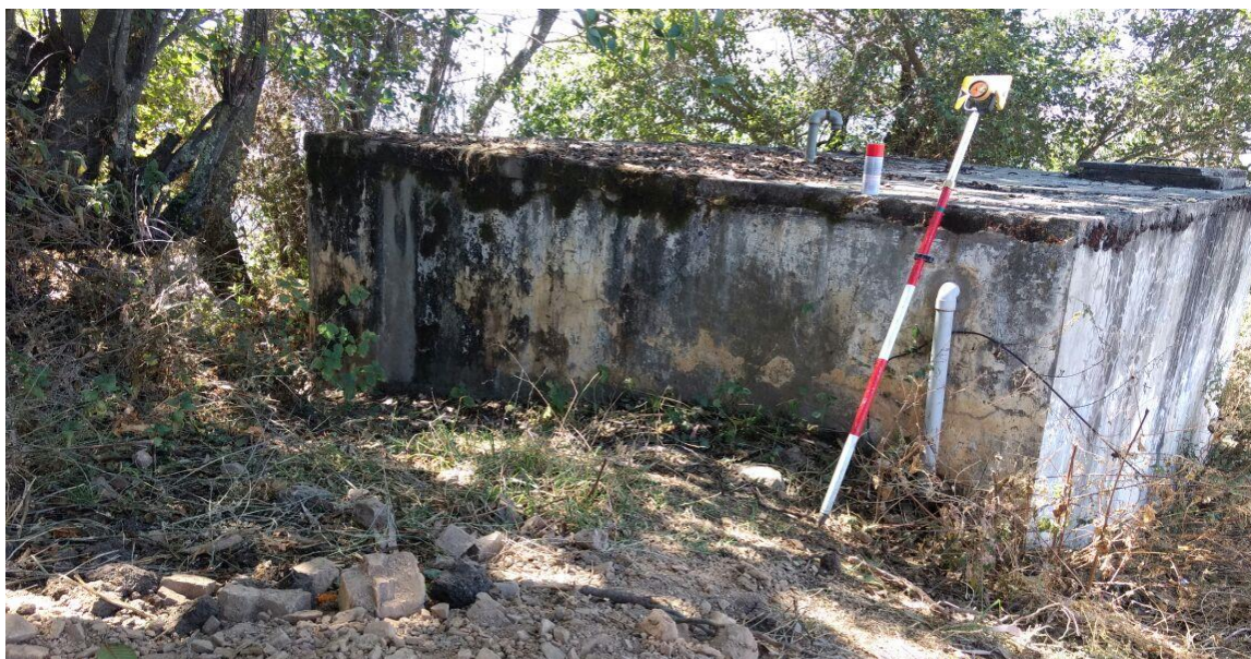
Figura 10. Vista del reservorio apoyado, se puede apreciar la tubería de conducción que llega y lo deteriorado que se encuentra la estructura del reservorio.
