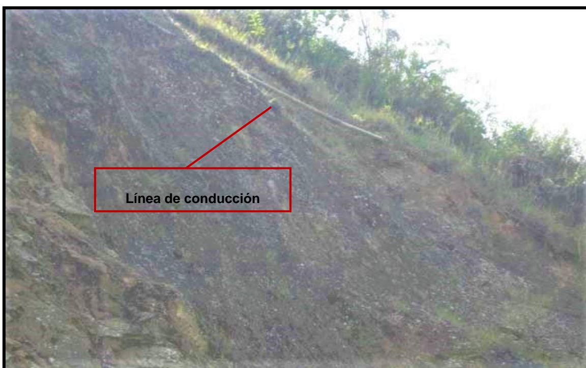
Figura 9. Vista de la línea de conducción expuesta
