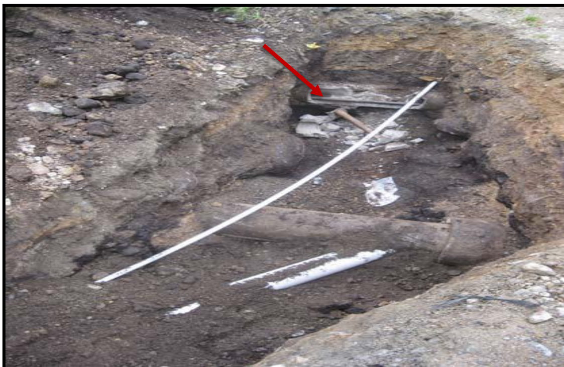
Figura 12. Vista de la red de distribución.
