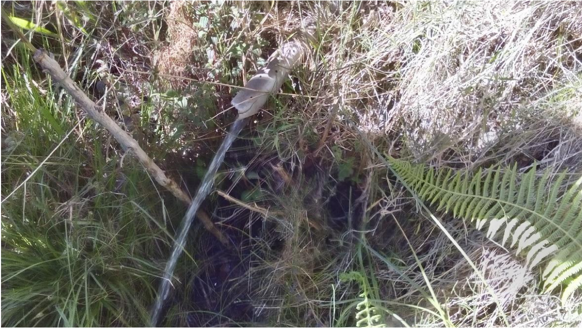
Figura 7. Se aprecia tubería rota, por la cual que es responsable de perdida de agua
