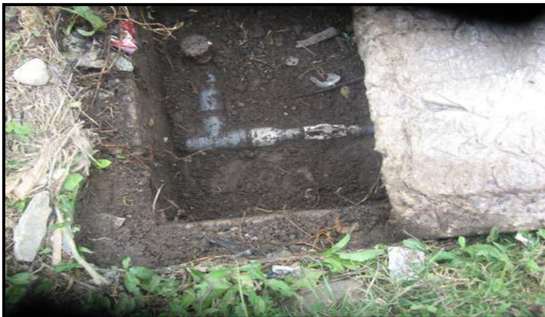
Figura 13. Vista interior de las conexiones domiciliarias de agua en mal estado de mantenimiento.
