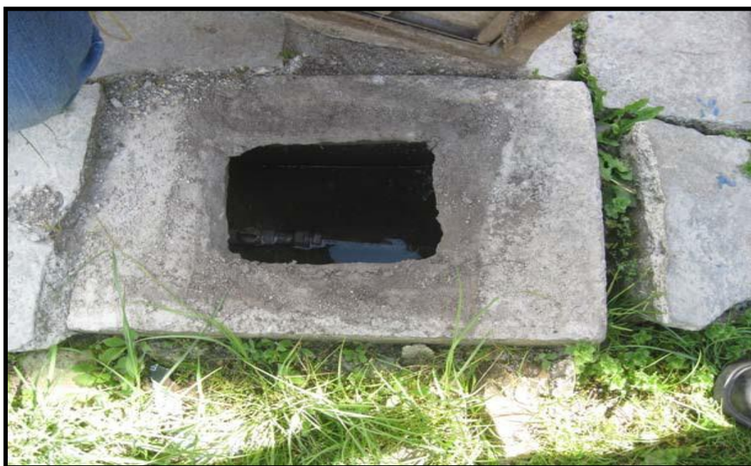
Figura 14. Vista exterior de las conexiones domiciliarias de agua en mal estado de mantenimiento.
