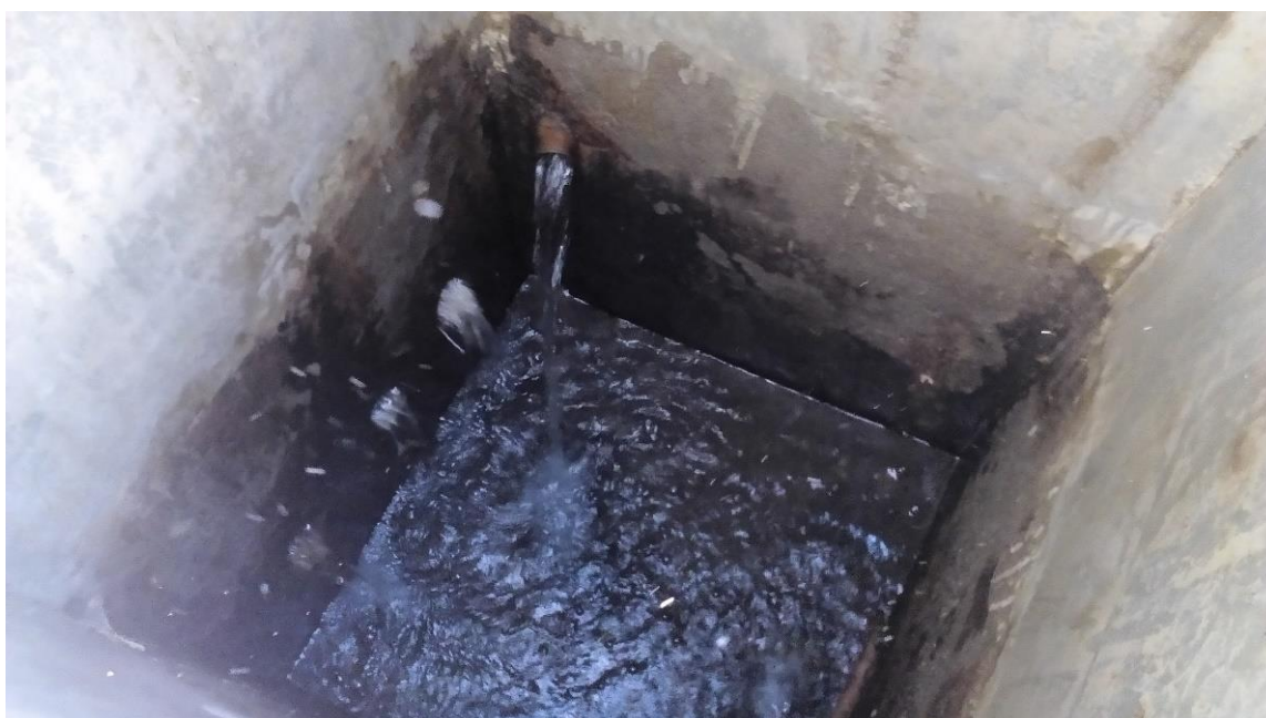
Figura 6. Se aprecia la parte interna de la caja de reunión en mal estado
