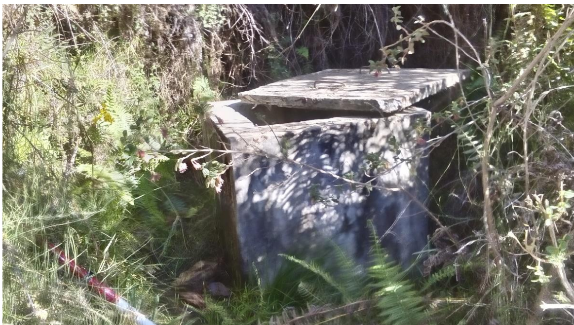
Figura 5. Se aprecia caja de reunión de concreto en mal estado
