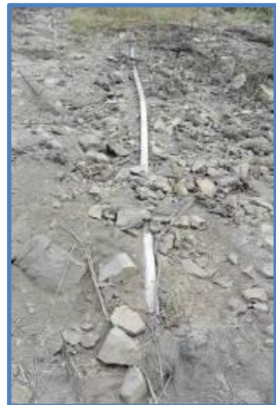
FOTO N°04: Tubería de aducción expuesta a la intemperie.
