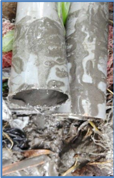
FOTO N°05: Tuberías colmatadas de lodo.
