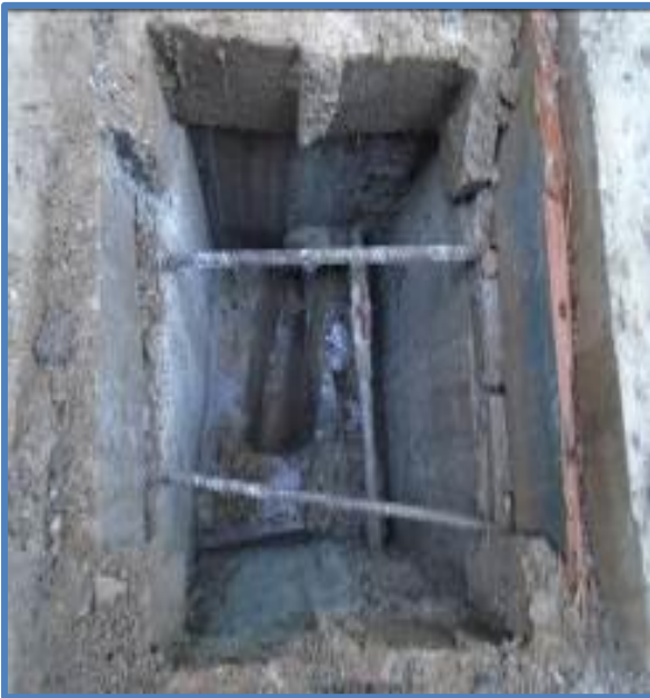
FOTO N°07: Conexiones domiciliarias de agua potable que atraviesan las cajas de desagüe.
