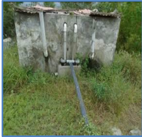
FOTO N°02: Reservorio en mal estado.
