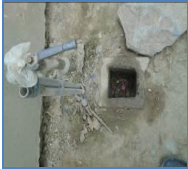
FOTO N°06: Conexión domiciliaria en mal estado
