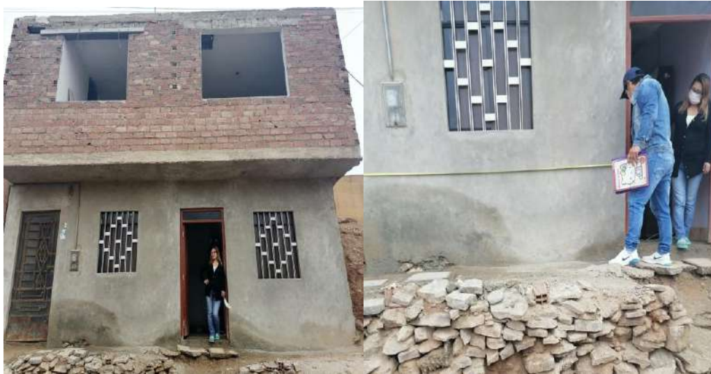
Figura 5: Deterioro por humedad de suelo
