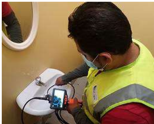
Grafica 14. Cámara endoscópica en desagüe Fuente: MR control soluciones sanitarias S.R.L.
