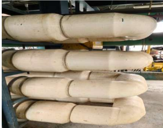
j) Vista de esquina de la estructura del serpentín, homogenizador de producto químico.
