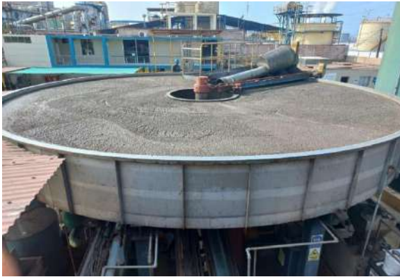
g) Vista exterior del Clarificador en la formación de lodos
