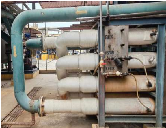
i) Vista Lateral de la estructura del serpentín y adición de coagulante (Sulfato Férrico).
