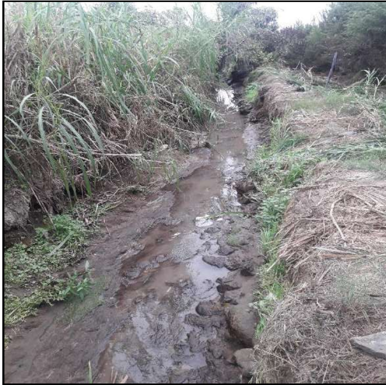
Figura 3: Se observa el canal lleno de malezas y arbustos
