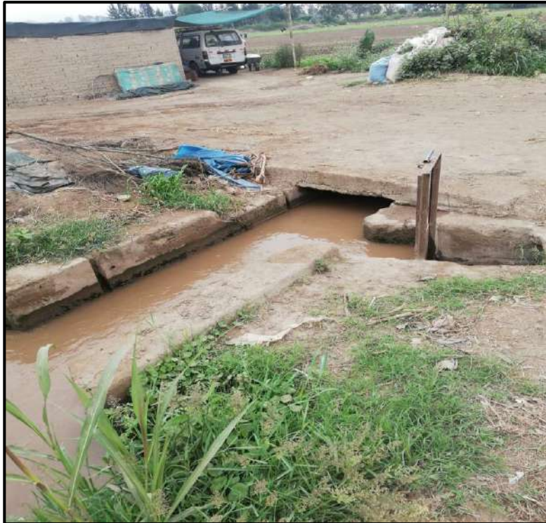
Figura 7: Se observa la alcantarilla y la compuerta del canal de tierra pendiente de diseño y construcción
