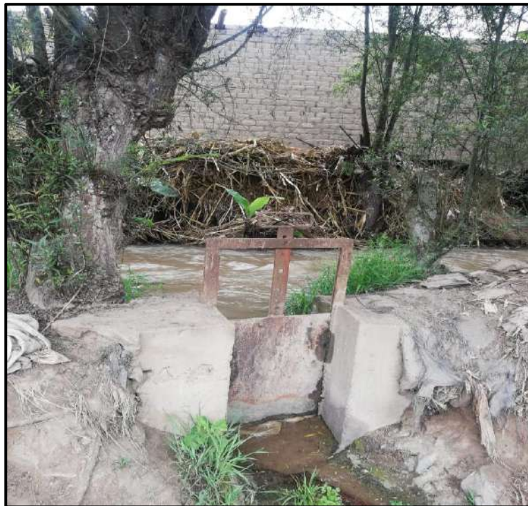
Figura 8: Se observa la compuerta de las tomas laterales pendiente de mejoramiento.
