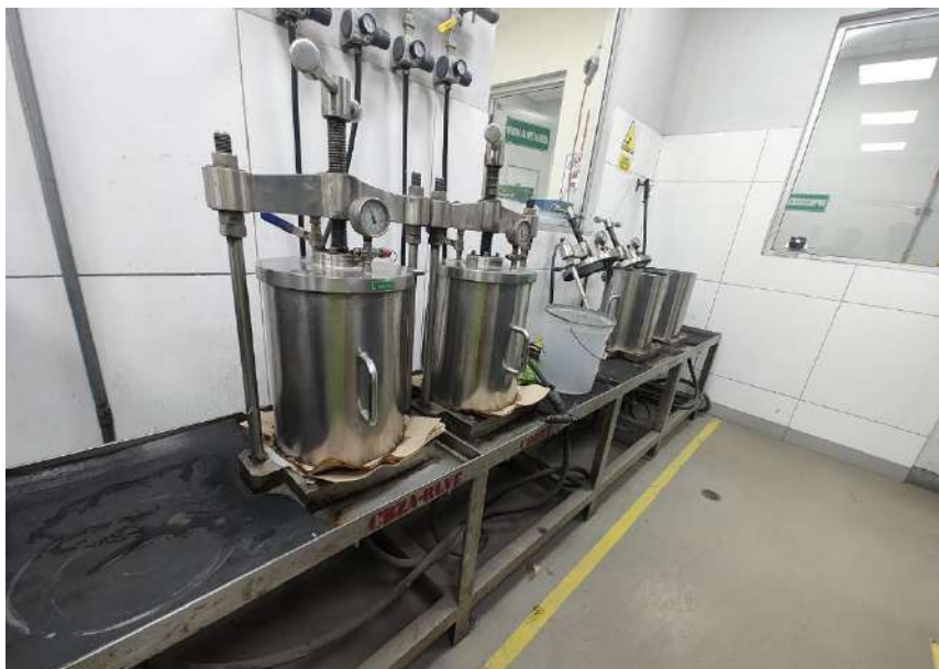
Figura 7 Sala de filtros de prensa.
