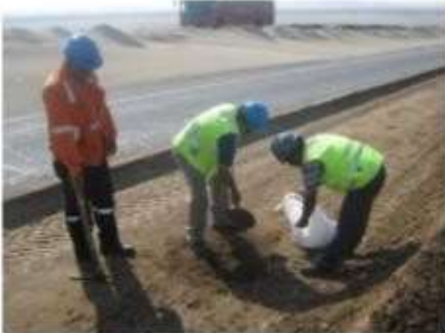
MUESTREO PARA PODER ENSAYAR Y VERIFICAR LA CALIDAD DE LOS MATERIALES EN CAMPO SEGÚN FRECUENCIA DE ENSAYOS.
