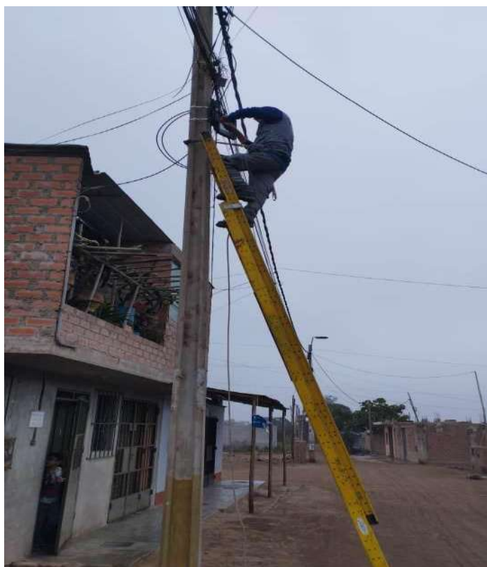
Figura 4: conexión de cajas nap en el poste de Quepepampa
