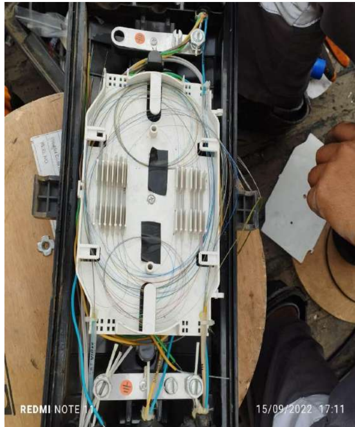
Figura 9: caja de empalmes para la primera mufa
