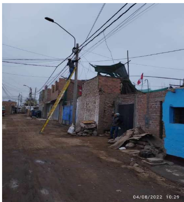
Figura 8: caja nap instalada calle principal de la quepepampa
