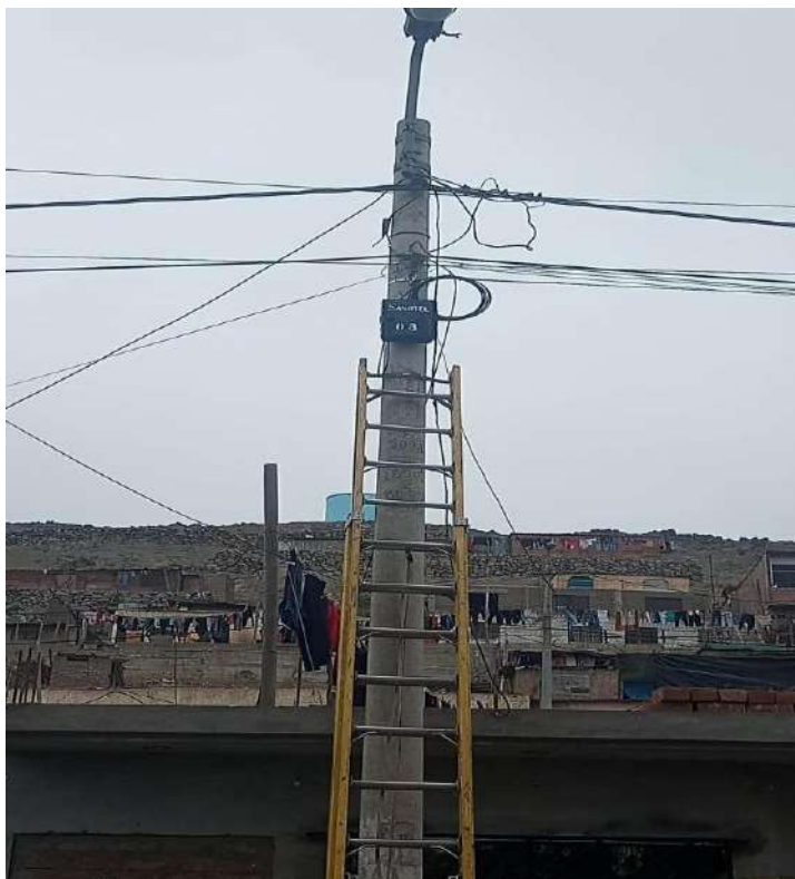
Figura 7: caja nap instalada calle principal de la quepepampa
