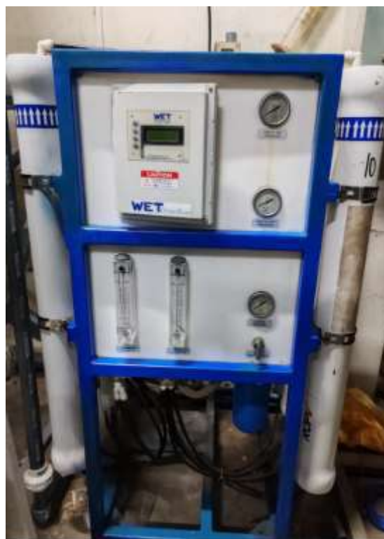
Equipo de osmosis inversa
